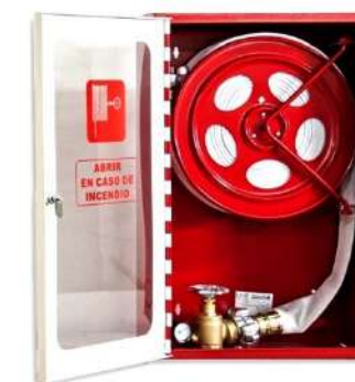
Figura. Boca d'Incendi Equipada
