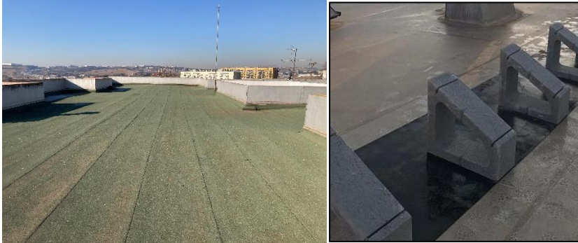
Estat actual de la coberta i làmina a incorporar sota dels blocs de formigó.
