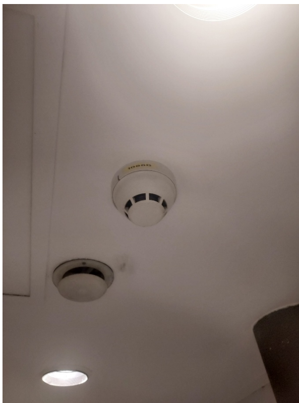
Fotografia 8. Ventilació i detecció d'Incendis.
