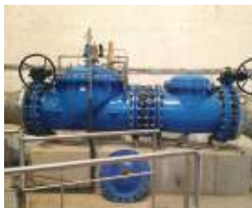
CAJA DE FILTROS PROTEGIENDO UNA VÁLVULA HYDROBLOC
