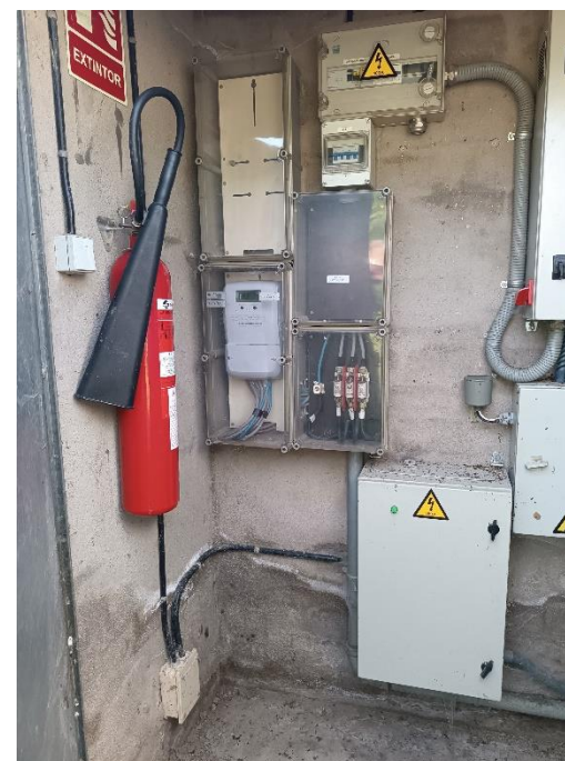
Imatge 5: Instal·lació elèctrica. actual Montrodon 4
