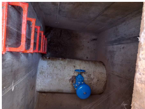
Fotografia 10: Vista canonada D800 i vàlvula de ventosa
