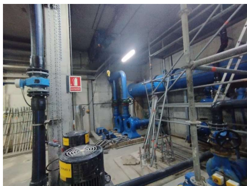
Fotografia 2: Instal·lacions de bombament d'aigua regenerada a l'EDAR St. Feliu de Llobregat
