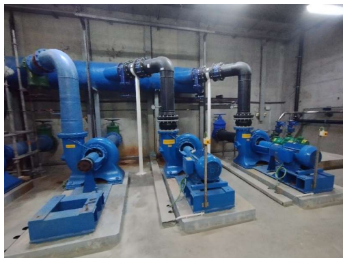
Fotografia 1: Instal·lacions de bombament d'aigua regenerada a l'EDAR St. Feliu de Llobregat
