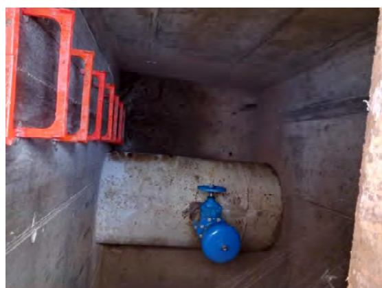
Fotografia 6: Interior de l'arqueta. Vista de la canonada i de la vàlvula de ventosa
