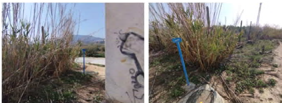
Fotografia 5: Vista de l'arqueta de la canonada D800 prèvia al gir abans de creuar el Llobregat
