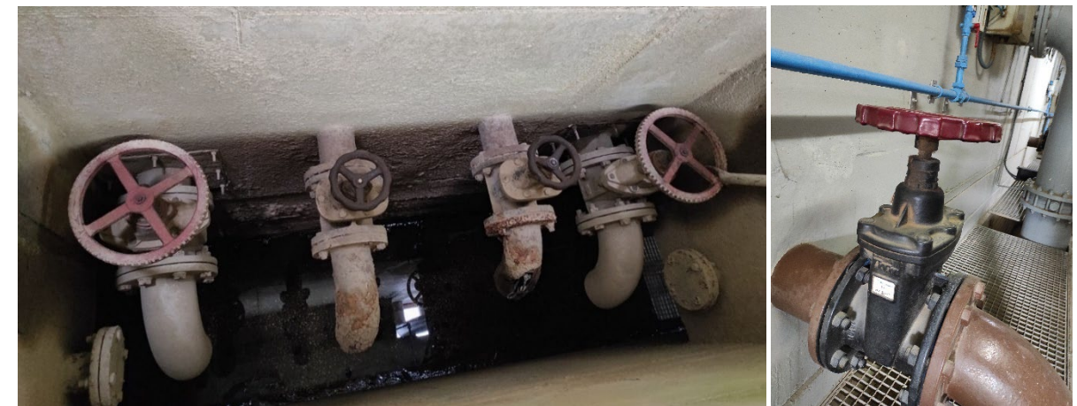
Figura 2. Vàlvules en mal estat
