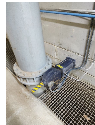
Figura 3. Actuadors en mal estat
