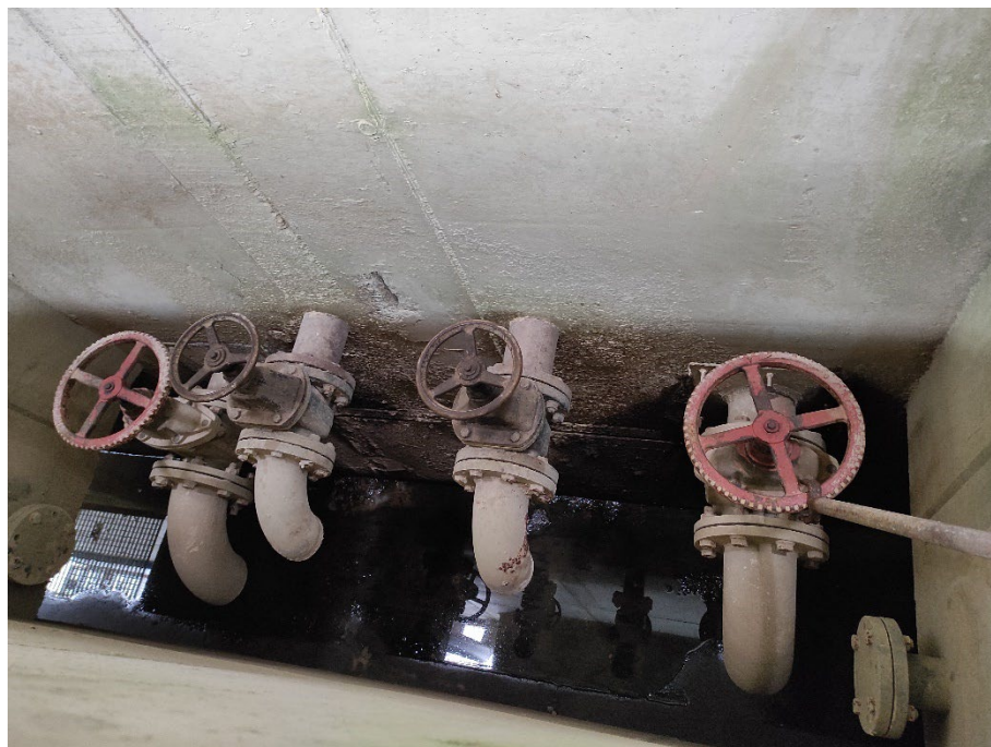
Fotografia 13. Vàlvules purgues decantador
