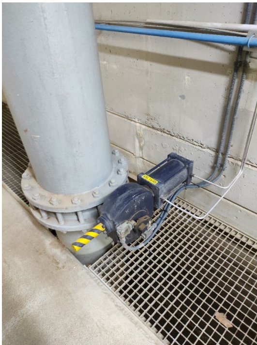
Figura 3. Vàlvula en mal estat
