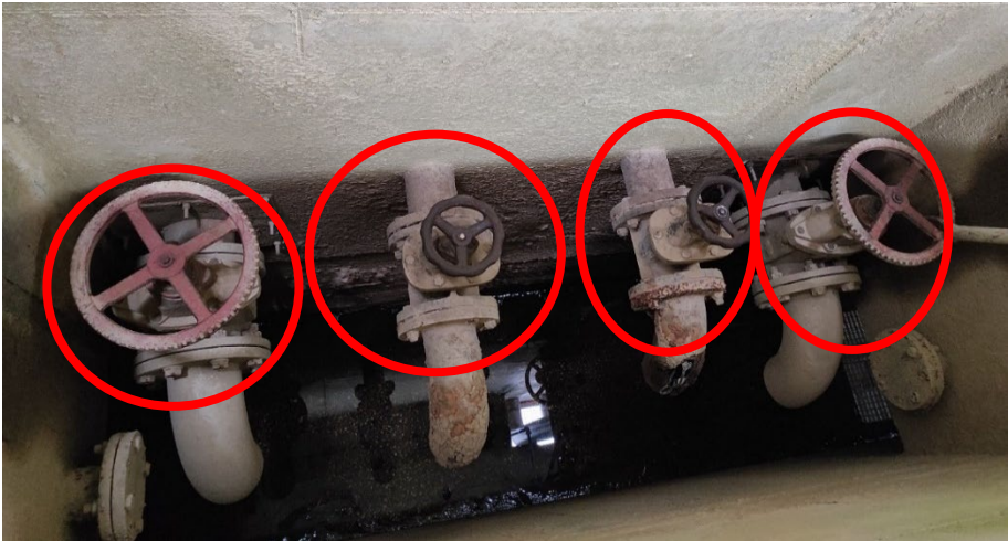
Figura 7. Vàlvula purgues decantador
