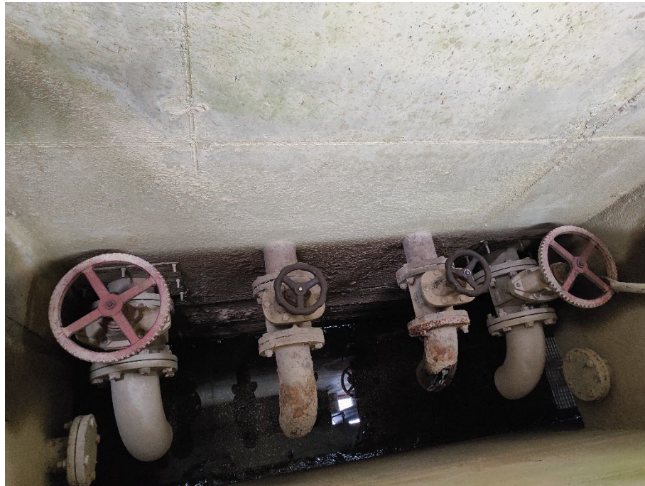
Fotografia 12. Vàlvules purgues decantador
