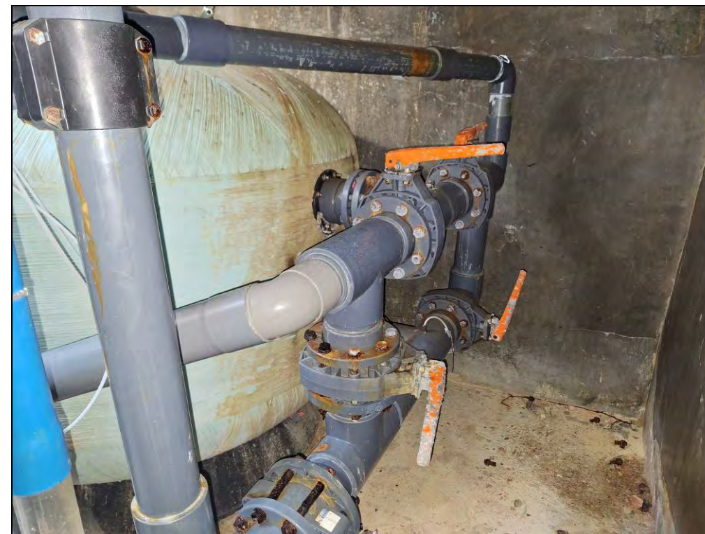
Figura núm. 9 Caseta d'instal·lacions. Estat actual instal·lacions
