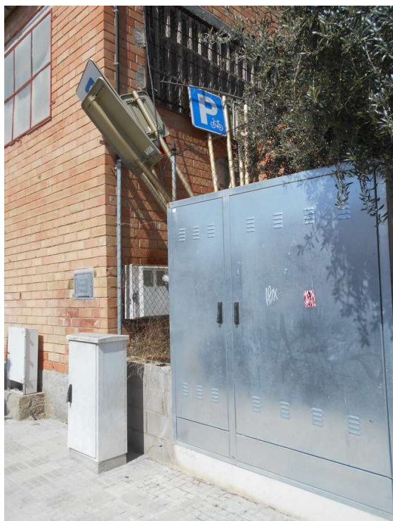
Imatge armari exterior amb TMF10.
