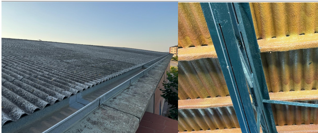
Estat de la coberta actual de plaques de fibrociment amb amiant i projectat interior amb poliuretà.
