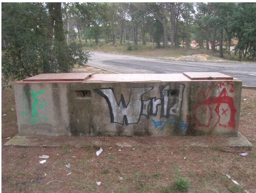
Fotografia núm. 1. Pou A i B de l'Urbanització de King Park
