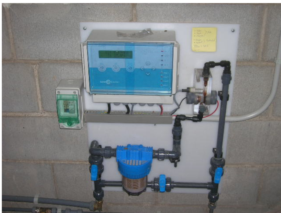
Fotografia núm. 12. Sistema de cloració del dipòsit de Sils
