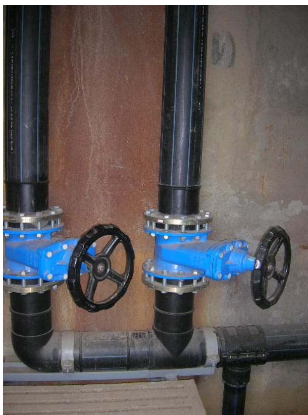
Fotografia núm. 9. Biburcació de la canonada d'entrada d'aigua al dipòsit
