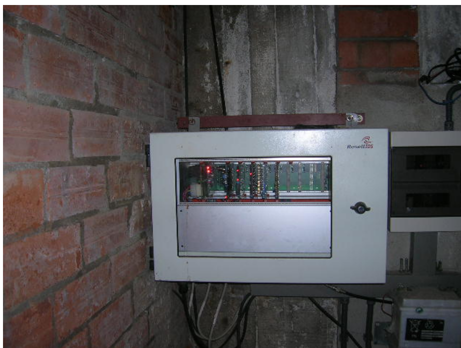
Fotografia núm.9. Telecontrol ubicat al dipòsit de Les Comes
