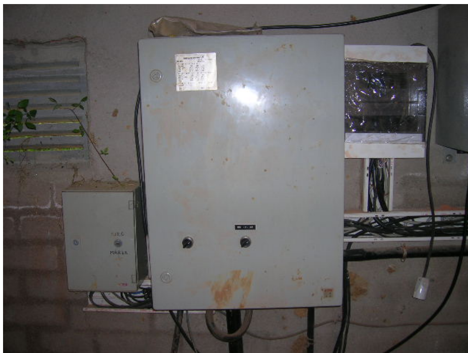
Fotografia núm. 8. Quadre elèctric del dipòsit de Les Comes
