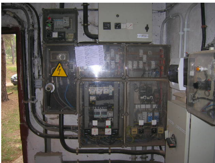
Fotografia núm. 4. Quadre electric de la captació de King Park
