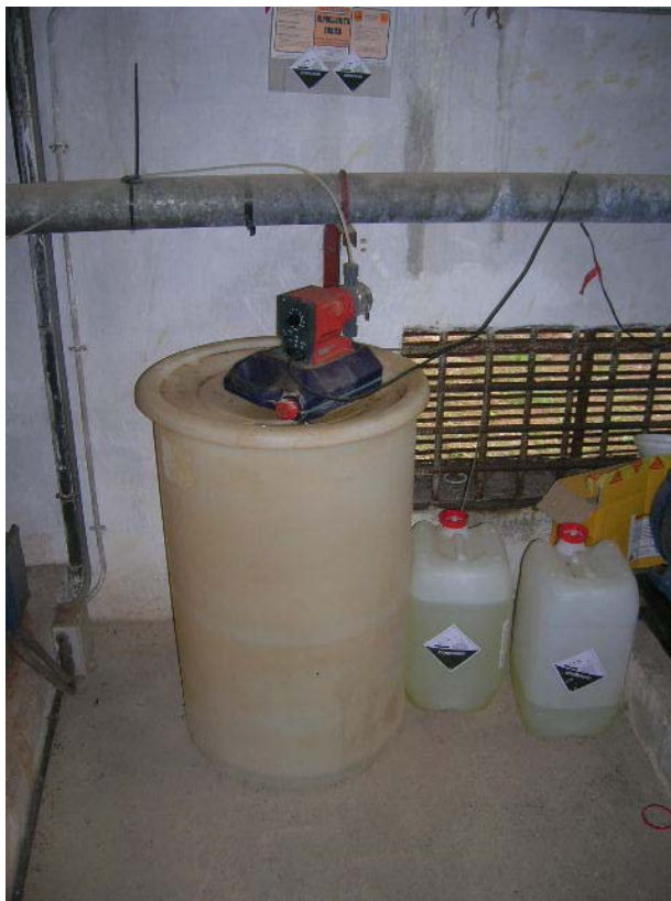
Fotografia núm. 7. Sistema de cloració de la captació de King Park
