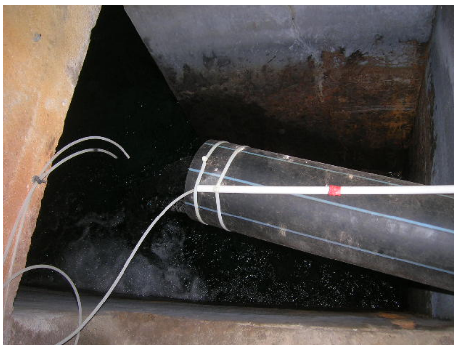
Fotografia núm. 11. Detall de la canonada d'entrada a dipòsit
