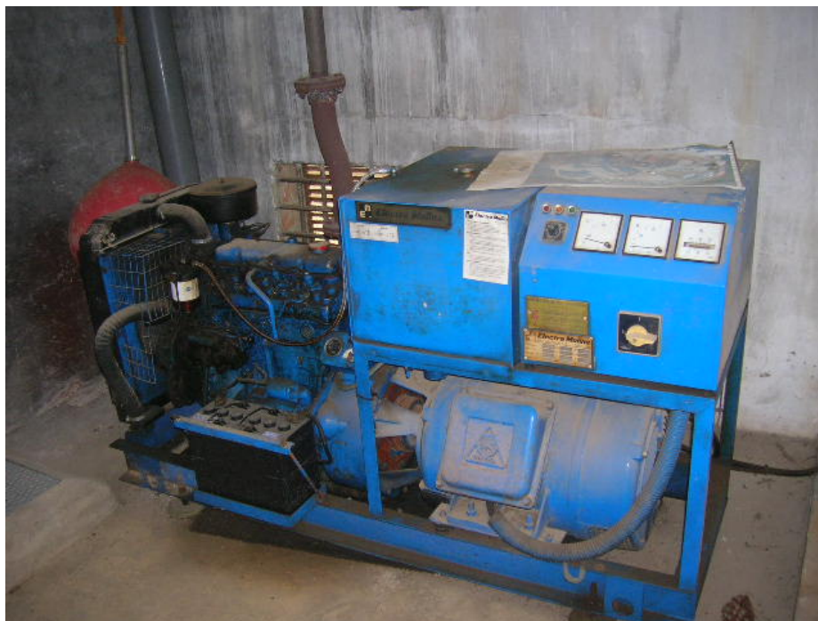
Fotografia núm. 8. Grup electrògen de la captació de King Park
