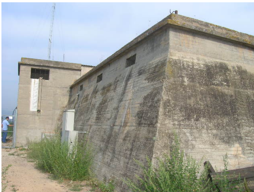
Fotografia núm. 6. Dipòsit de Sils
