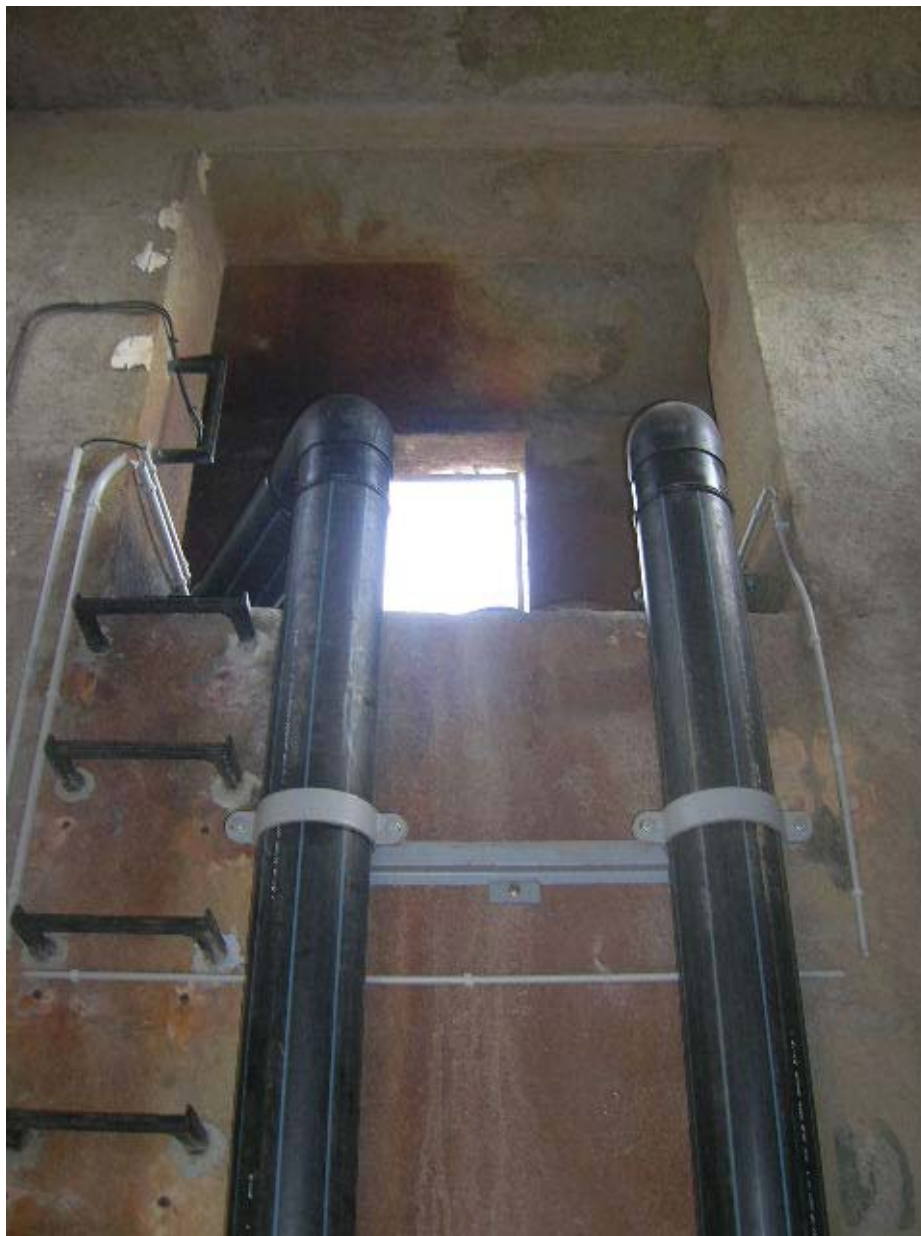
Fotografia núm. 10. Canonades d'entrada d'aigua al diposit
