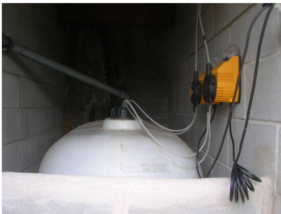
Fotografia núm. 13. Detall del sistema de cloració
