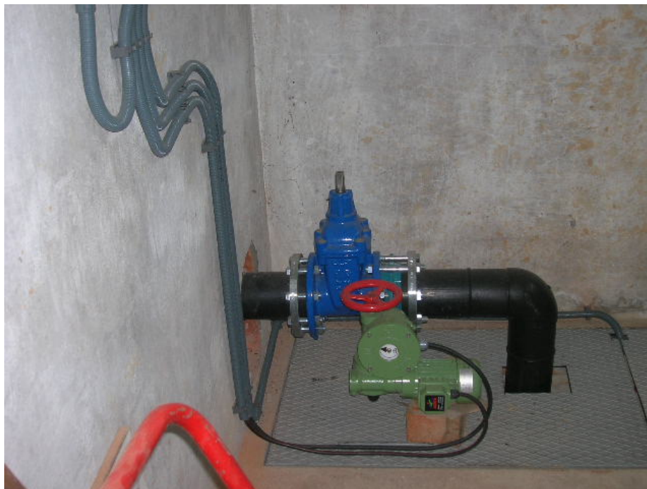
Fotografia núm. 5. Canonada d'entrada de la connexió de la xarxa de Sils
