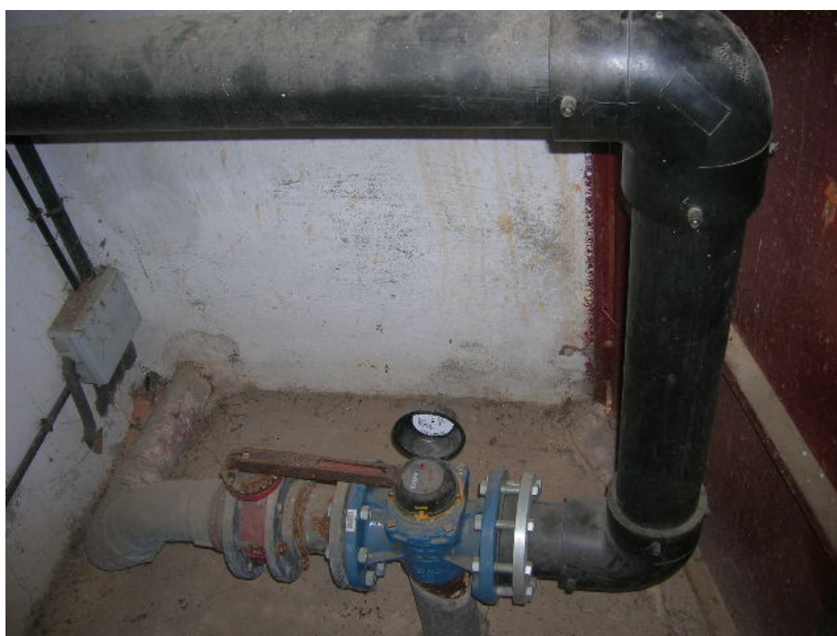
Fotografia núm. 6. Canonada de sortida cap a dipòsit de King Park
