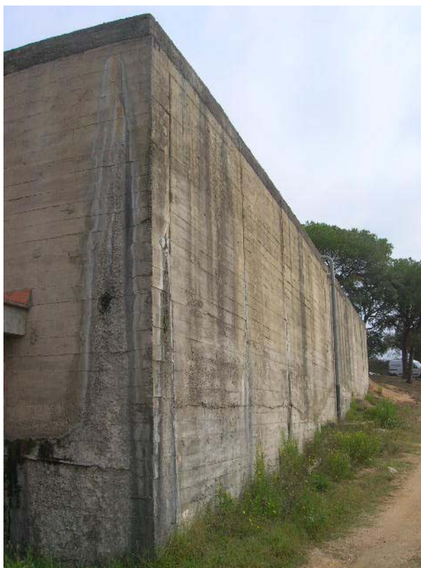
Fotografia núm.11. Detall del dipòsit de l'Urbanització de King Park(I)
