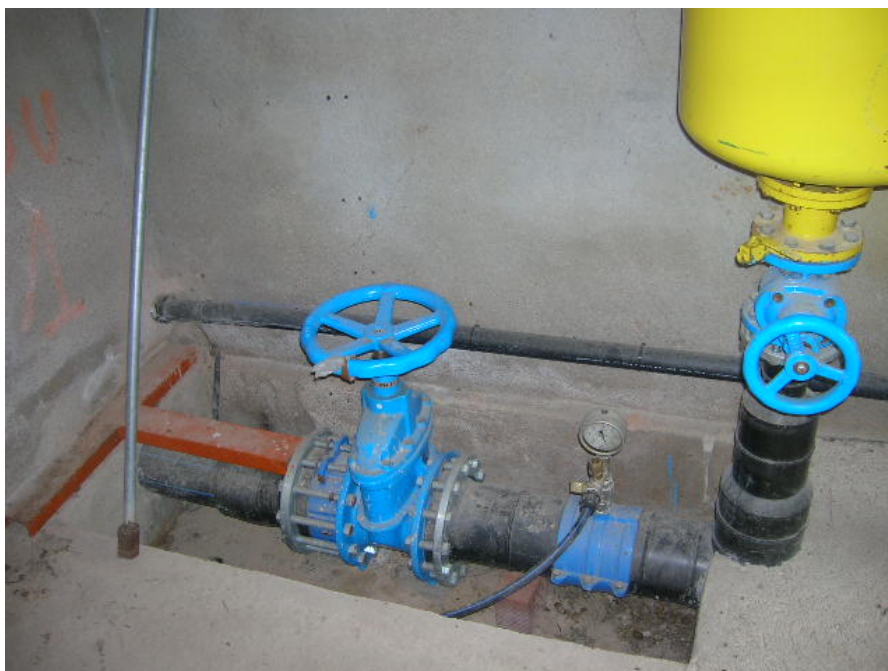
Fotografia núm. 3. Sortida de la canonada d'impulsió cap al dipòsit
