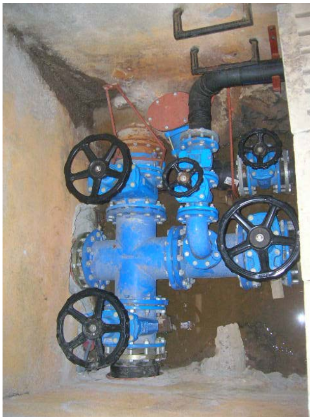
Fotografia núm. 15. Canonada de sortida de dipòsit
