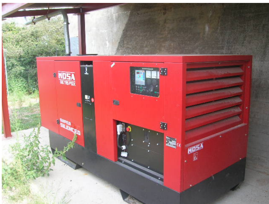
Fotografia núm. 14. Grup electrògen del dipòsit de Sils
