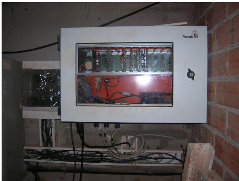
Fotografia núm. 4. Telecontrol dels pous de Les Comes situat a la caseta de captació
