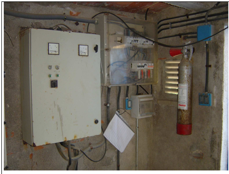
Quadres de maniobra e instal·lació elèctrica del dipòsit rodó petit.
