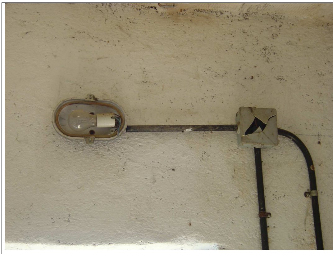
Detall de l'instal·lació elèctrica del pou Sevillana.
