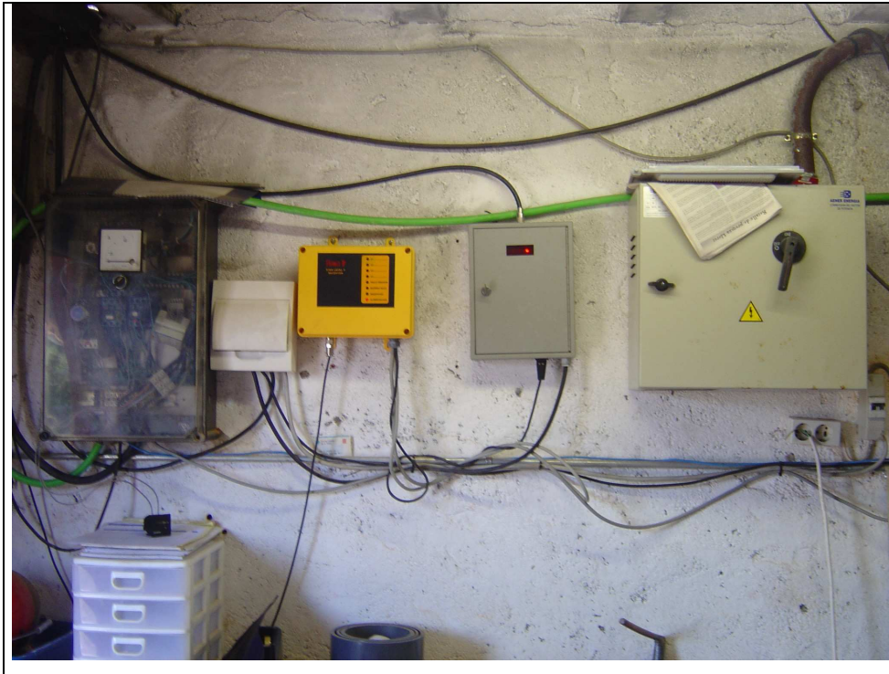
Quadres de maniobra e instal·lació elèctrica del dipòsit quadrat.
