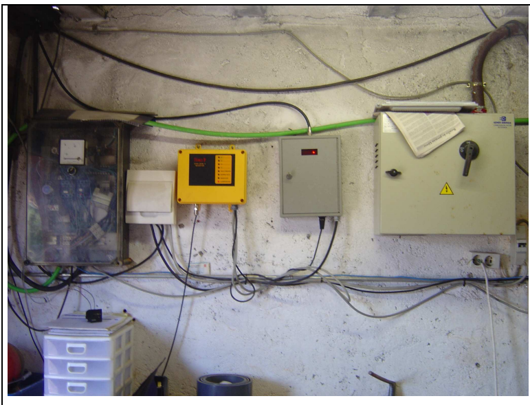
Emissora dipòsit quadrat i receptor de la senyal del dipòsit rodó petit.
