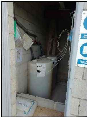
CASETA DE CLORACIÓ
