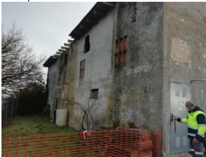
Figura 5. Edifici en desús i ruïnós adjunt a la cara nord-est del Dipòsit de Sils
