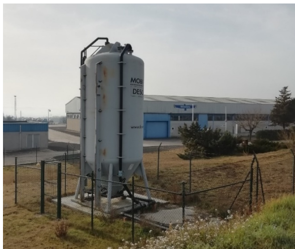
Figura 1. Filtre de carbó actiu instal·lat entre la captació i el Dipòsit de Sils, solució de caràcter provisional
