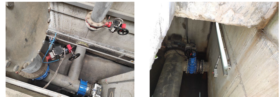
Figura 2. Vàlvules en mal estat
