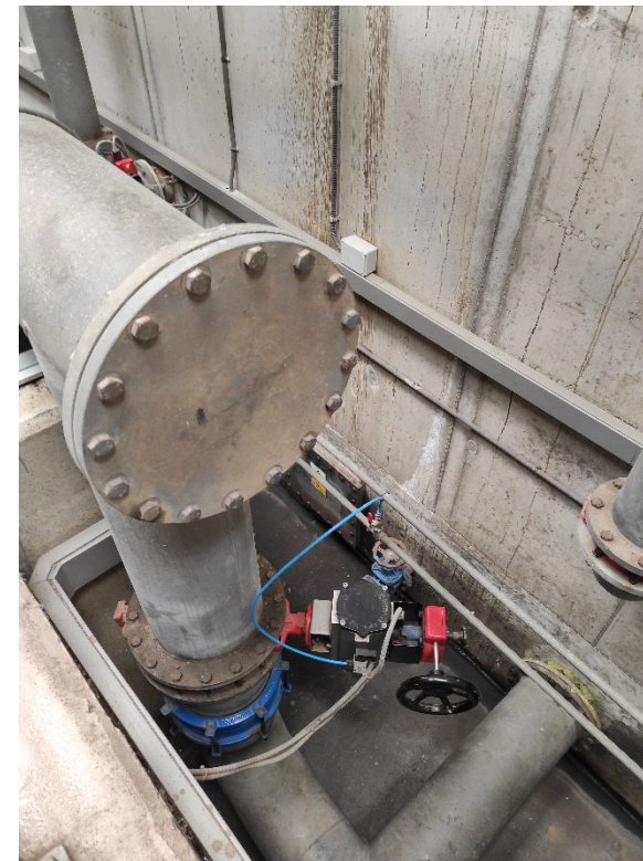
Fotografia 7. Vàlvules entrada aigua rentat dels filtres
