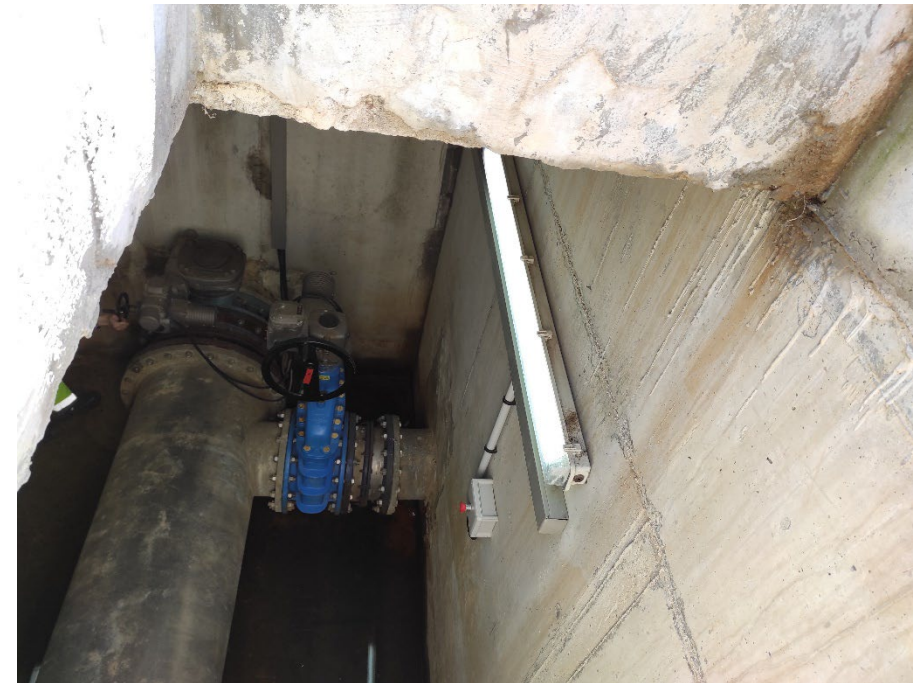
Fotografia 14. Vàlvules de l'arqueta dipòsit ITAM
