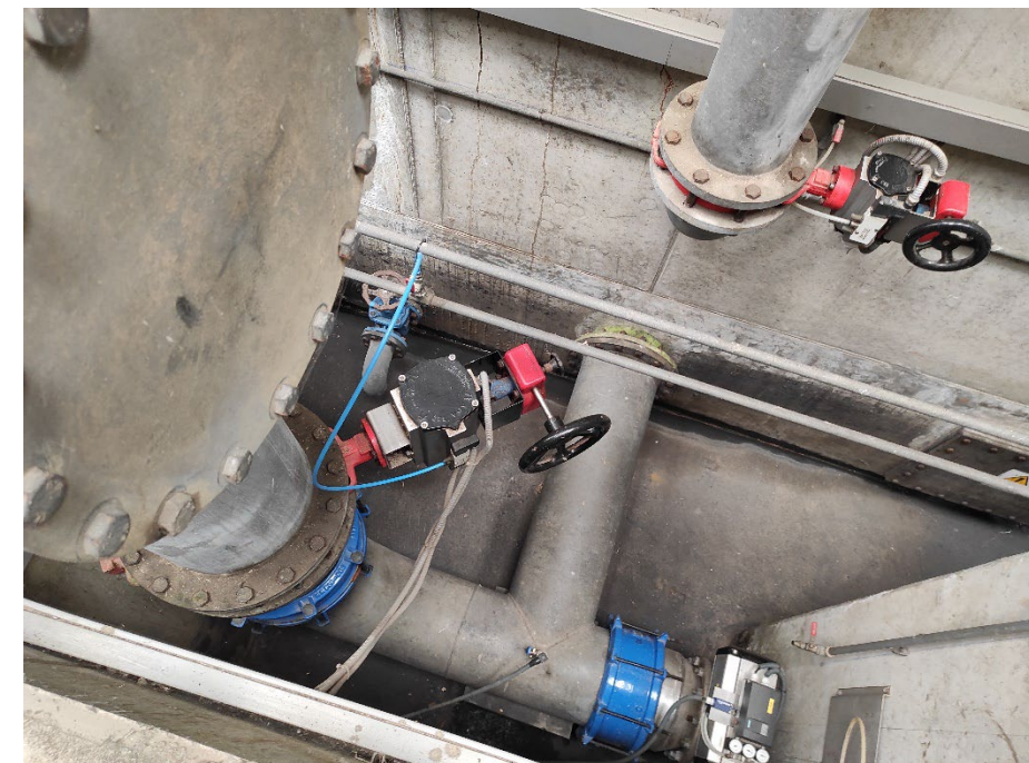
Fotografia 3. Vàlvules entrada aigua rentat i entrada aire rentat dels filtres
