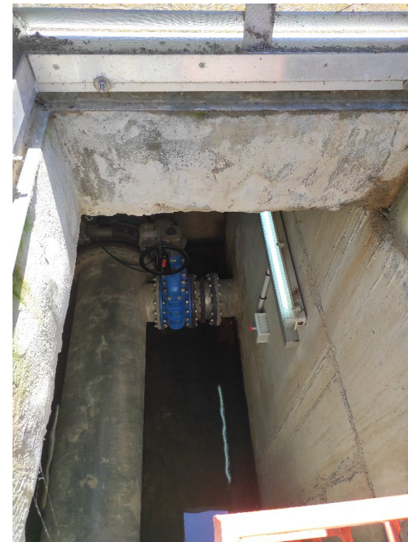
Fotografia 15. Vàlvules de l'arqueta dipòsit ITAM
