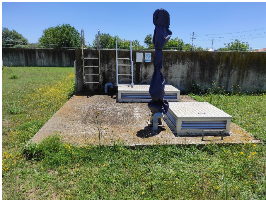
Fotografia 13. Arqueta dipòsit ITAM
