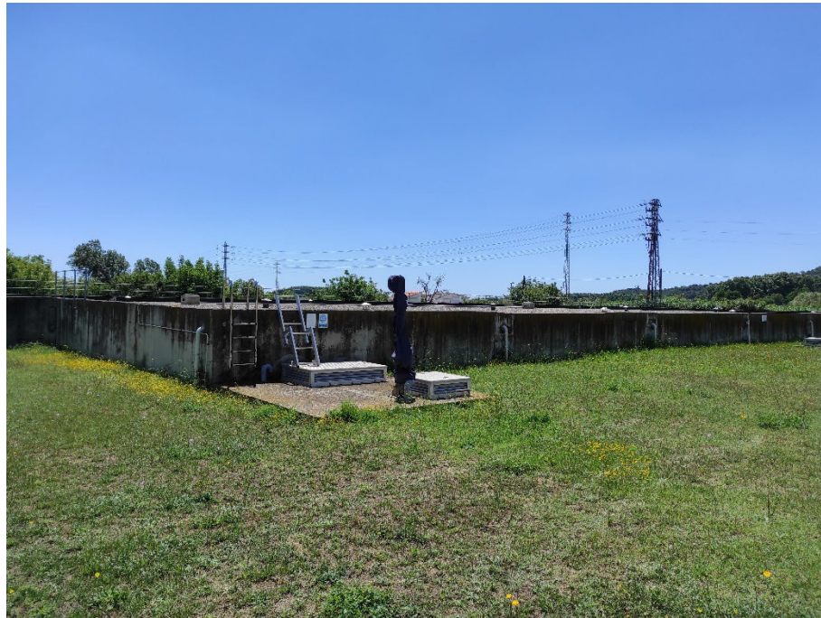
Fotografia 12. Arqueta dipòsit ITAM
