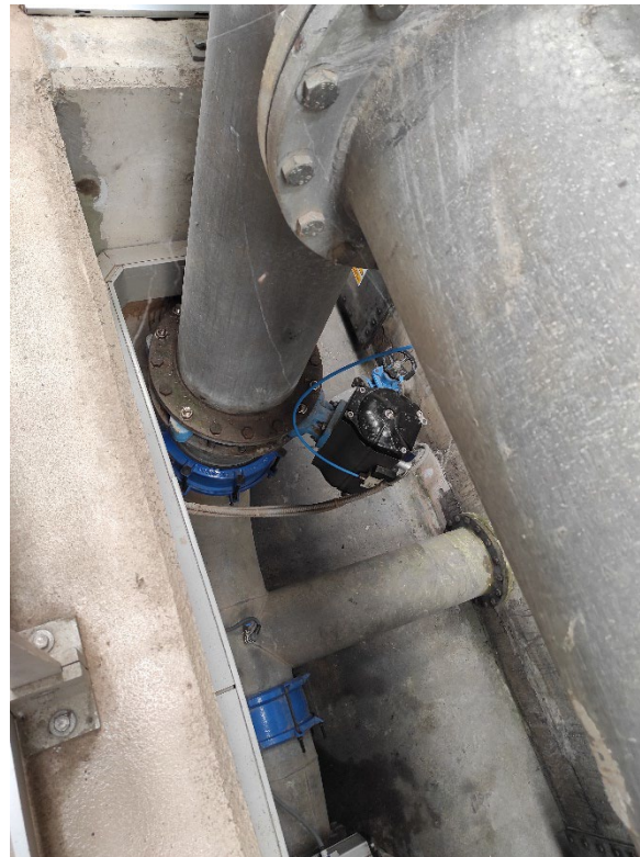
Fotografia 8. Vàlvules entrada aigua rentat dels filtres
