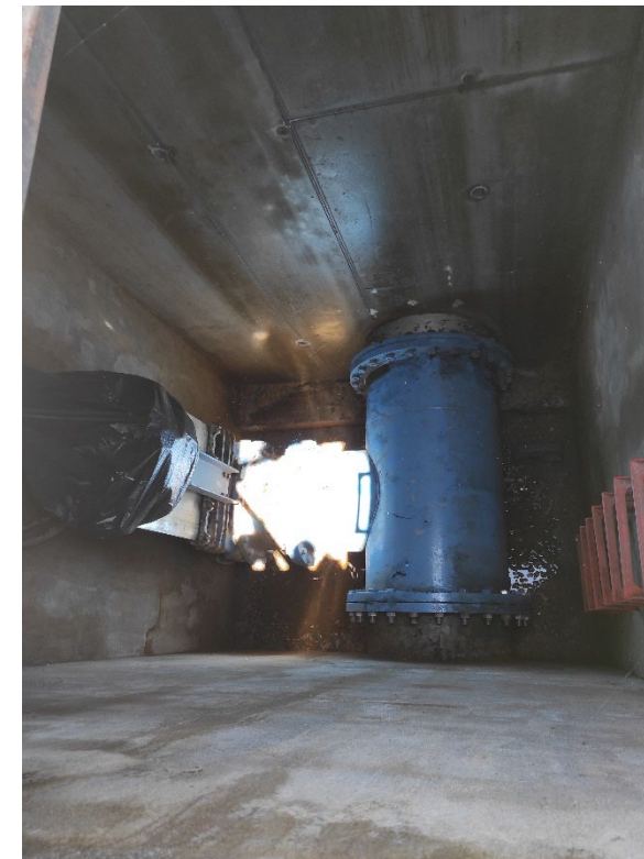
Fotografia 11. Vàlvules de l'arqueta sortida dipòsit regulador
