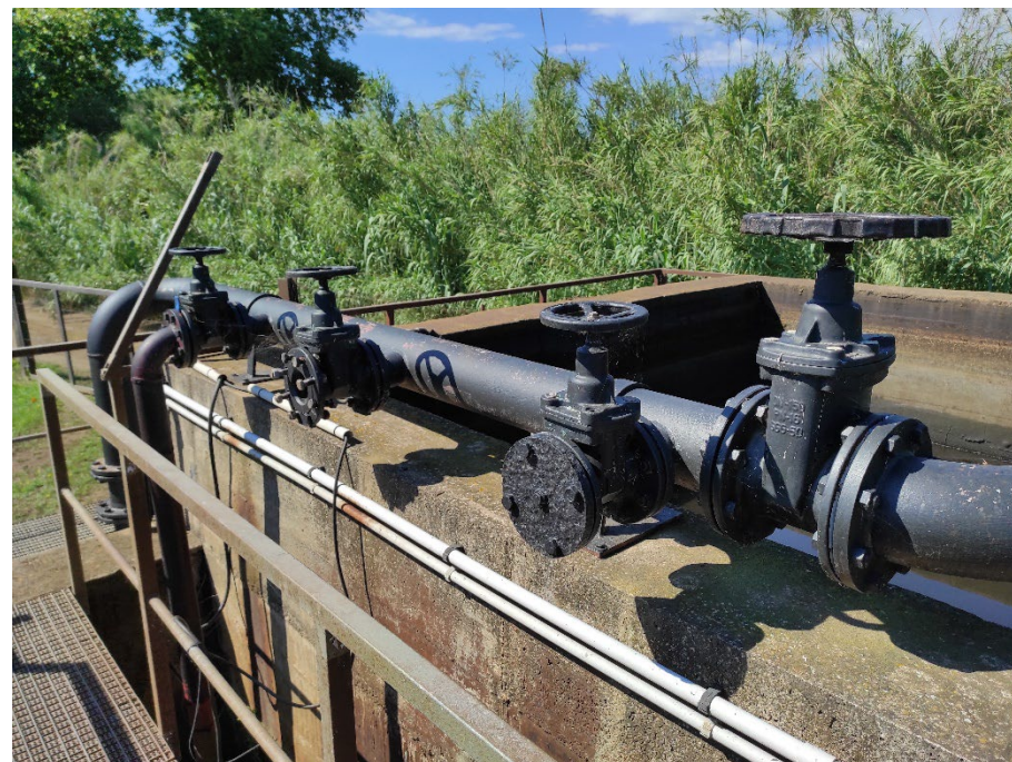
Fotografia 22. Vàlvules recuperació d'aigua
