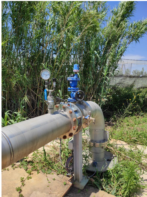
Fotografia 85. Vàlvules pou E captació Gualta
