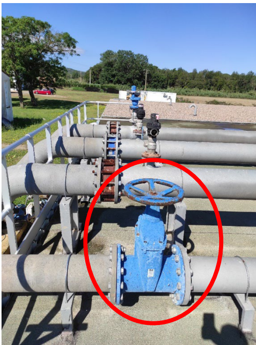
Figura 25. Vàlvula impulsió by-pass dipòsit Quermany
