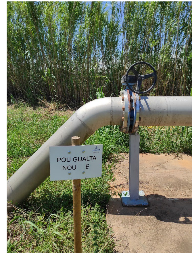
Fotografia 83. Vàlvules pou E captació Gualta
