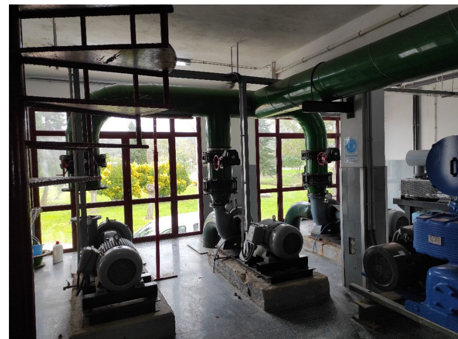
Fotografia 60. Bombes i valvuleria de l'aigua de rentat de filtres
