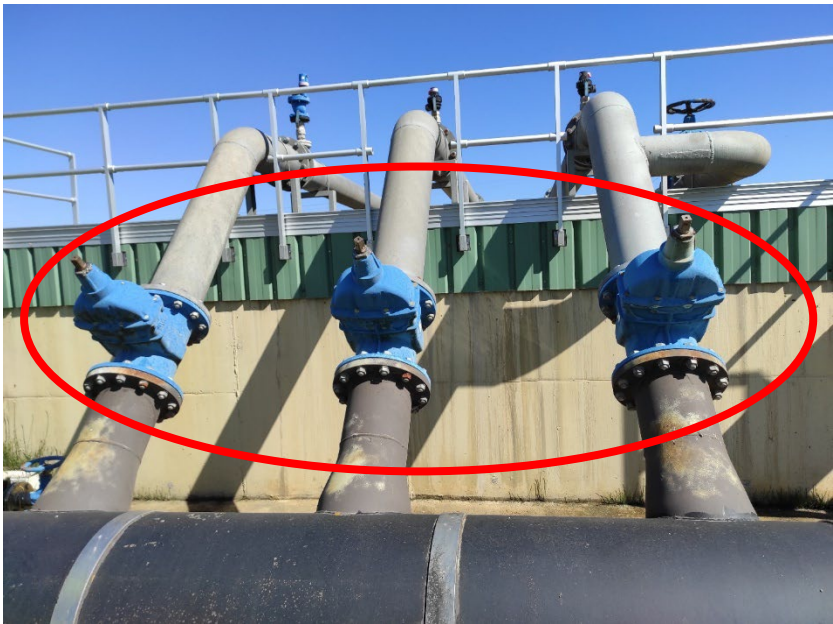
Figura 24. Vàlvules impulsió a dipòsit Quermany
