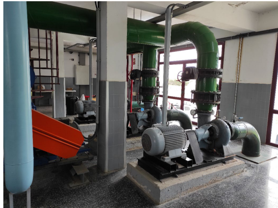
Fotografia 61. Bombes i valvuleria de l'aigua de rentat de filtres
