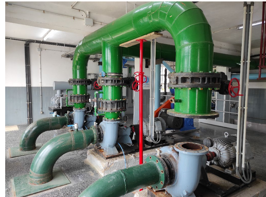
Fotografia 59. Bombes i valvuleria de l'aigua de rentat de filtres
