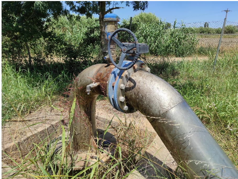
Fotografia 81. Vàlvules pou D captació Gualta
