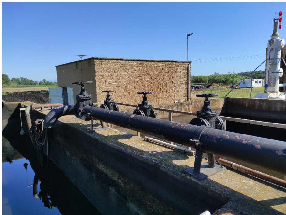
Fotografia 18. Vàlvules recuperació d'aigua
