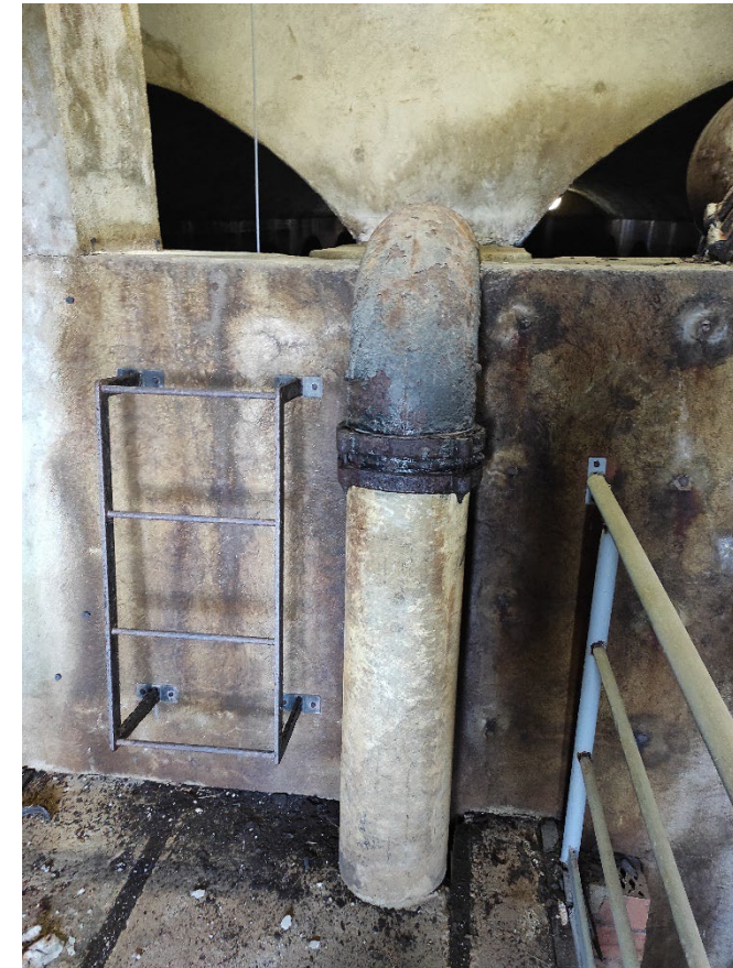
Fotografia 75. Vàlvules dipòsit Quermany vell
