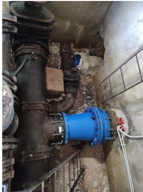
Fotografia 73. Vàlvules dipòsit Quermany vell
