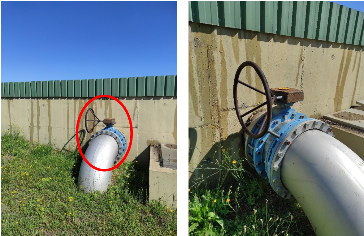
Figura 28. Vàlvula dipòsit nou
