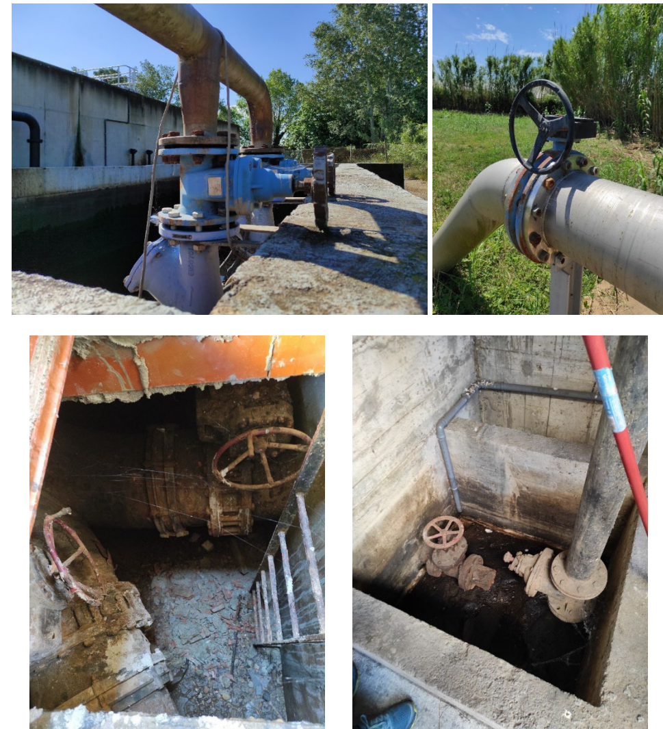
Figura 2. Vàlvules en mal estat
