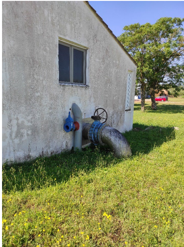
Fotografia 45. Vàlvula captació piscina
