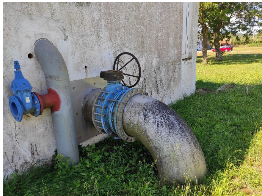
Fotografia 46. Vàlvula captació piscina
