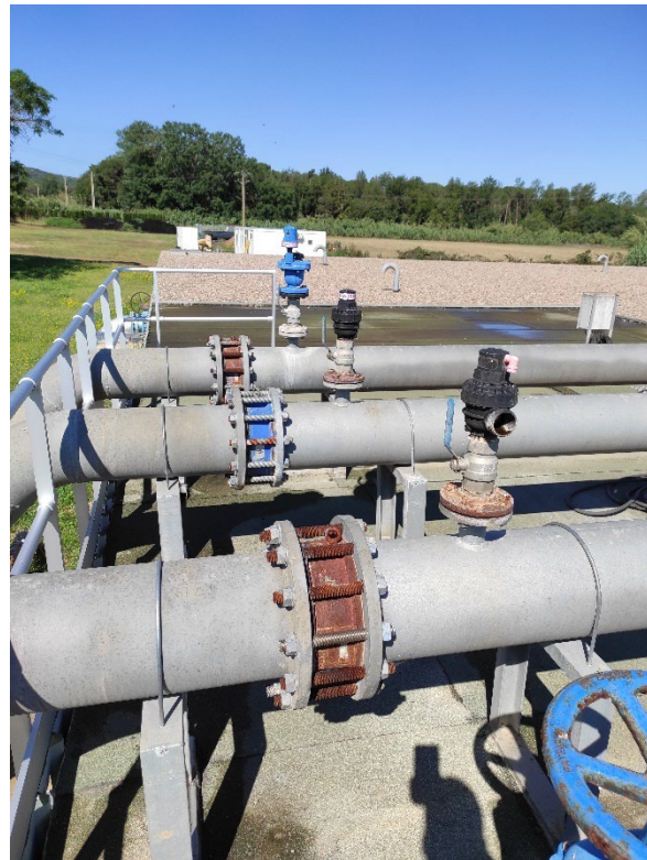
Fotografia 41. Vàlvules impulsió a Quermany
