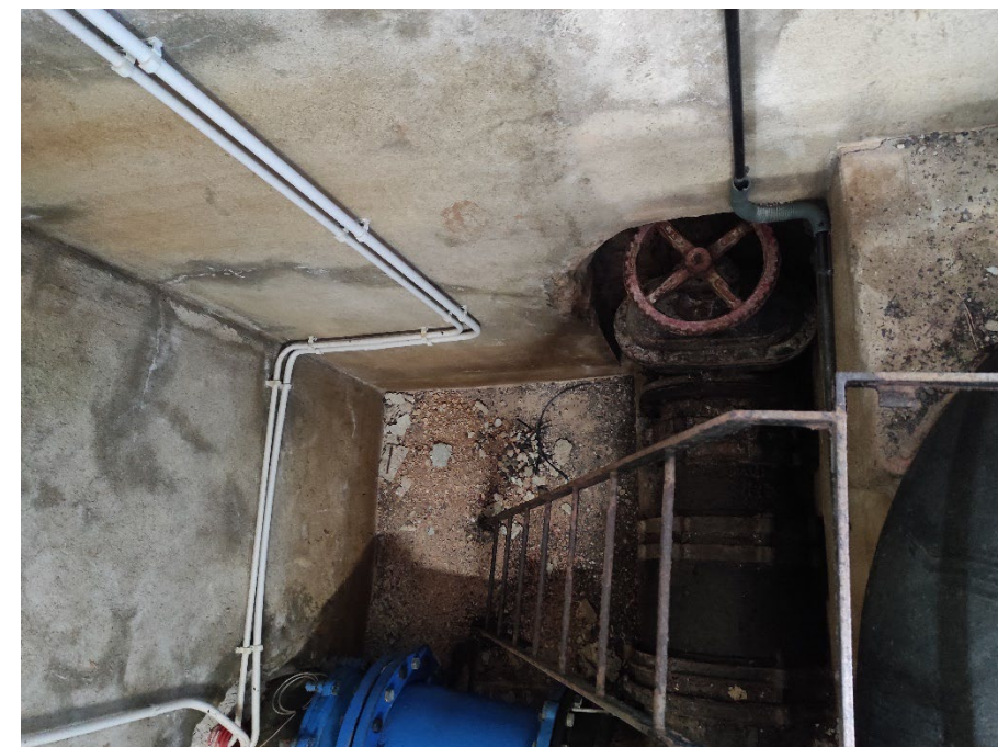
Fotografia 72. Vàlvules dipòsit Quermany vell
