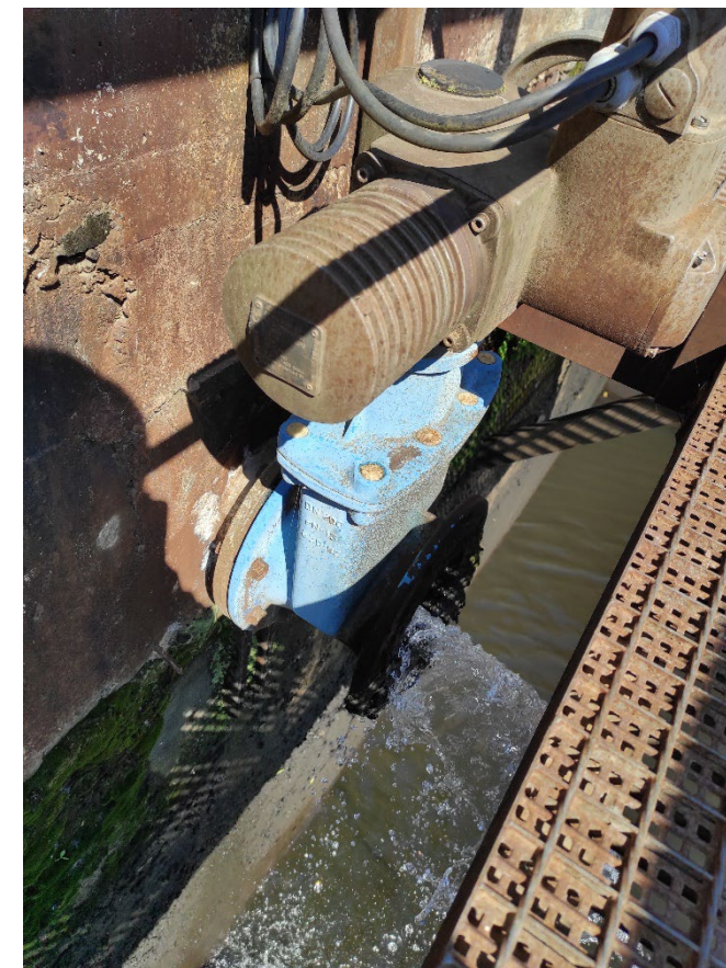
Fotografia 24. Vàlvules recuperació d'aigua
