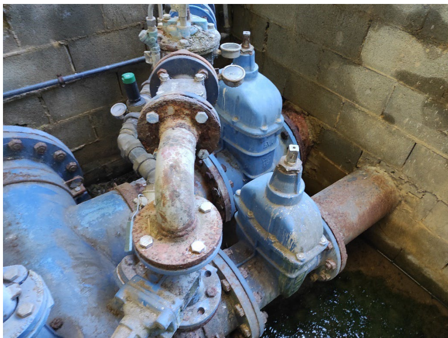
Fotografia 34. Valvuleria interior de l'arqueta
