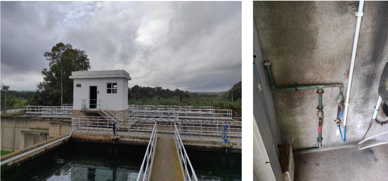
Figura 5. Cambra i canonada de l'inici del circuit pneumàtic
