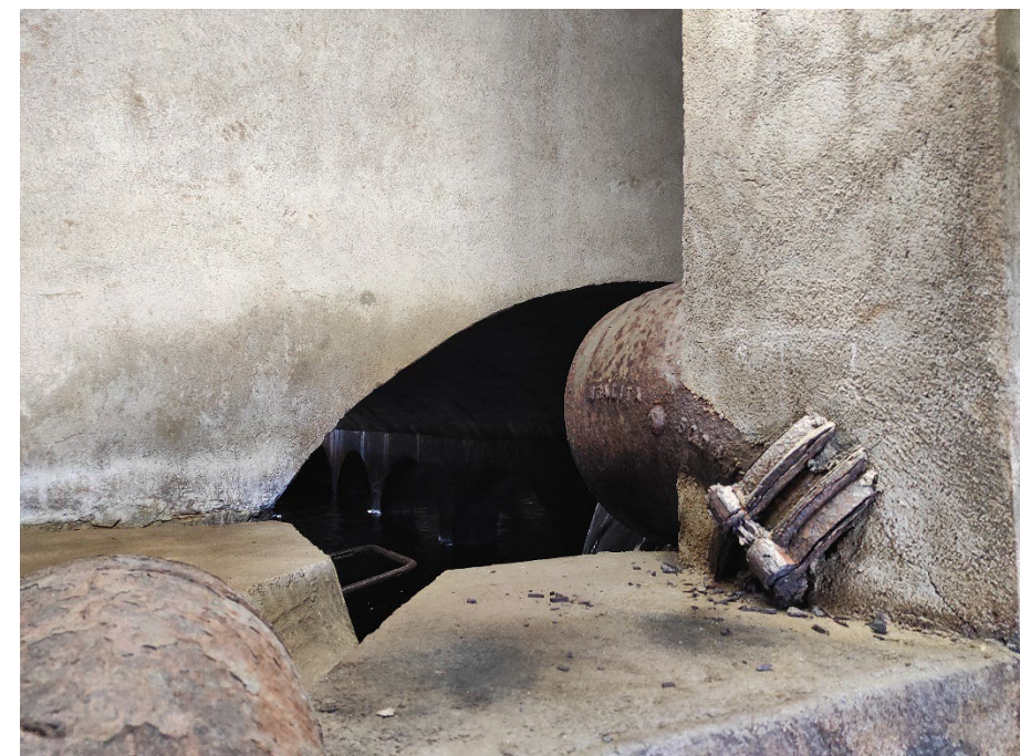
Fotografia 76. Vàlvules dipòsit Quermany vell
