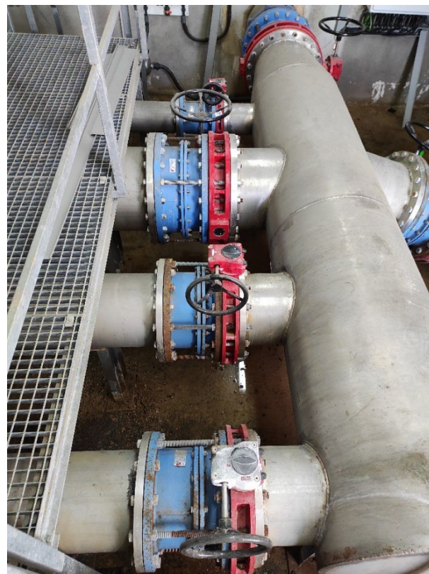
Fotografia 66. Vàlvules dipòsit Quermany nou
