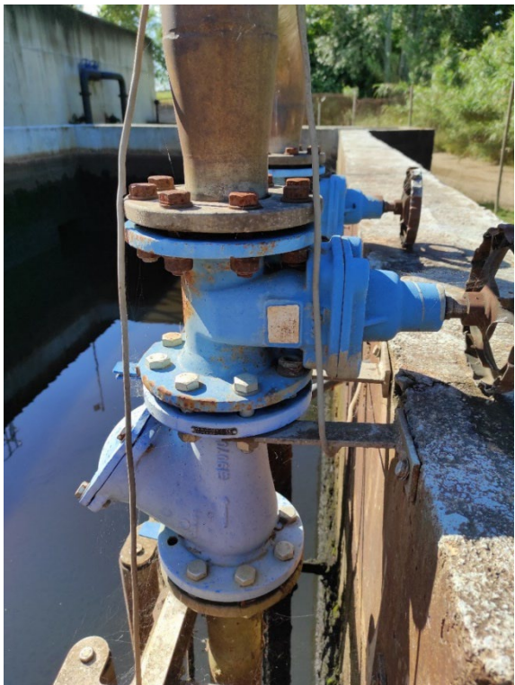
Figura 7. Vàlvules impulsió dipòsit de purgues
