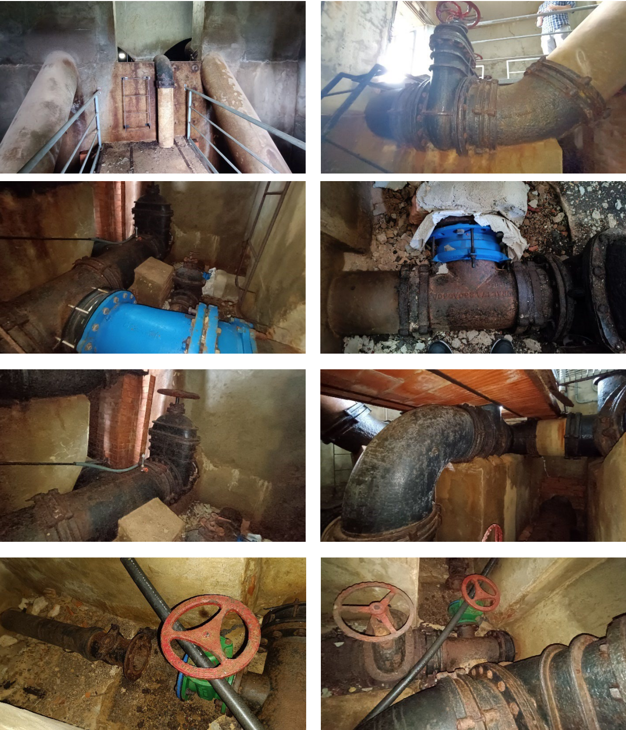
Figura 36. Canonades i vàlvules existents del dipòsit Quermany vell
