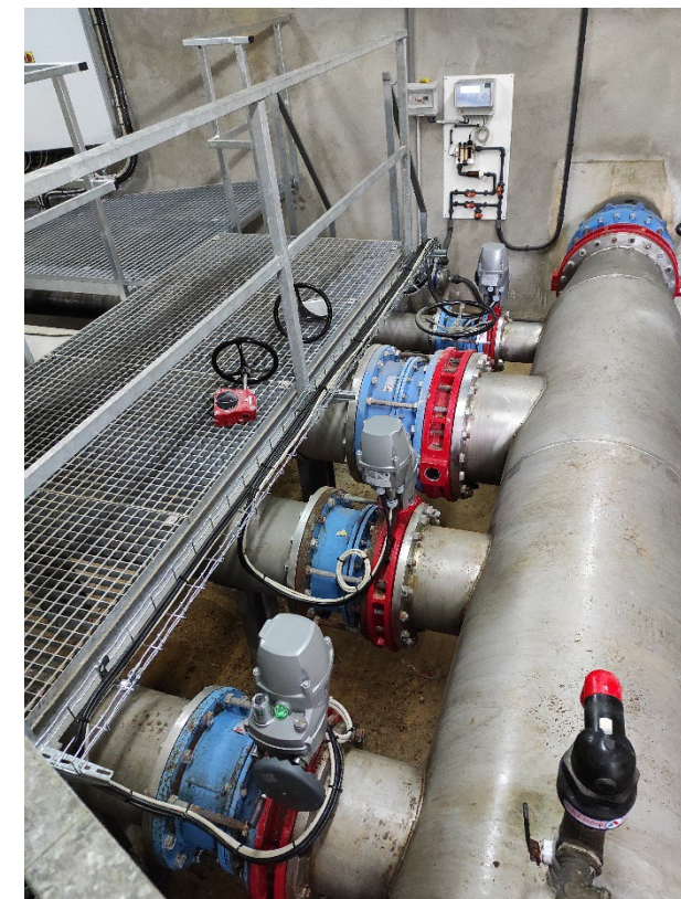
Fotografia 68. Vàlvules dipòsit Quermany nou
