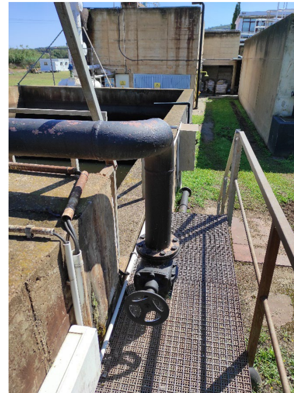
Fotografia 19. Vàlvules recuperació d'aigua
