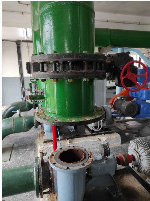
Fotografia 62. Bombes i valvuleria de l'aigua de rentat de filtres
