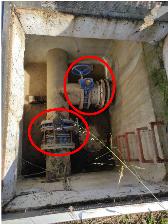
Figura 31. Vàlvules arqueta descàrregues
