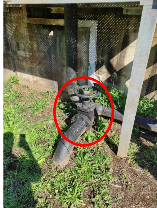
Figura 9. Vàlvula recuperació d'aigua
