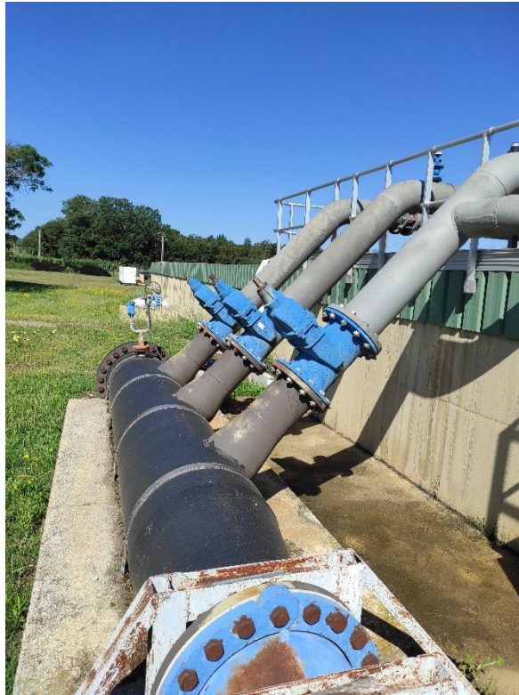
Fotografia 37. Vàlvules impulsió a Quermany
