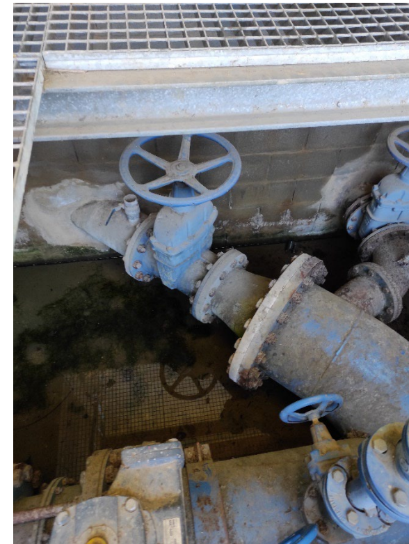
Fotografia 27. Valvuleria interior de l'arqueta
