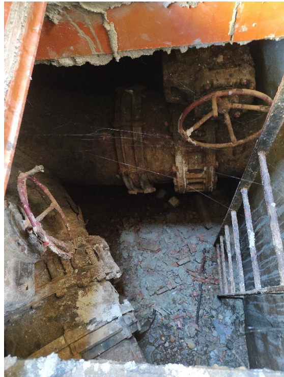
Fotografia 49. Vàlvules bypass connexió decantador-filtres
