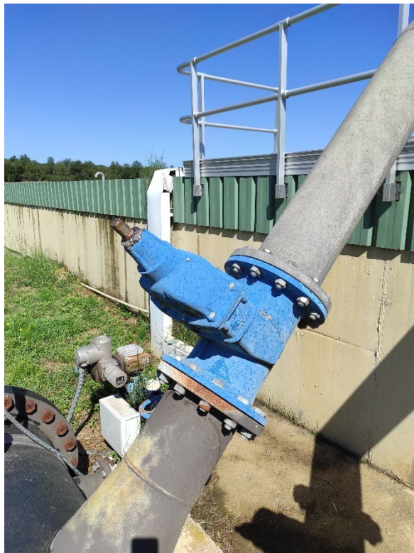
Fotografia 38. Vàlvules impulsió a Quermany
