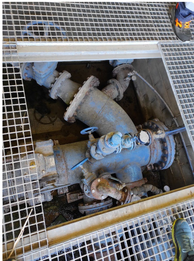
Fotografia 26. Valvuleria interior de l'arqueta
