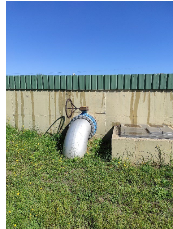
Fotografia 47. Vàlvula dipòsit nou
