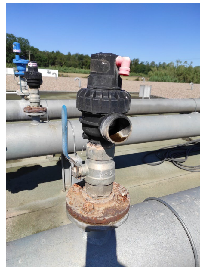
Fotografia 44. Vàlvules impulsió a Quermany
