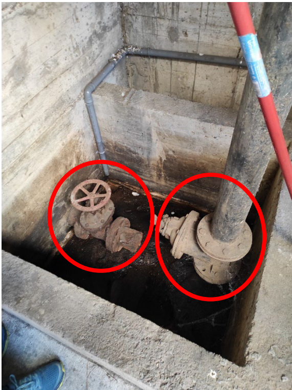
Figura 30. Vàlvules arqueta descàrregues
