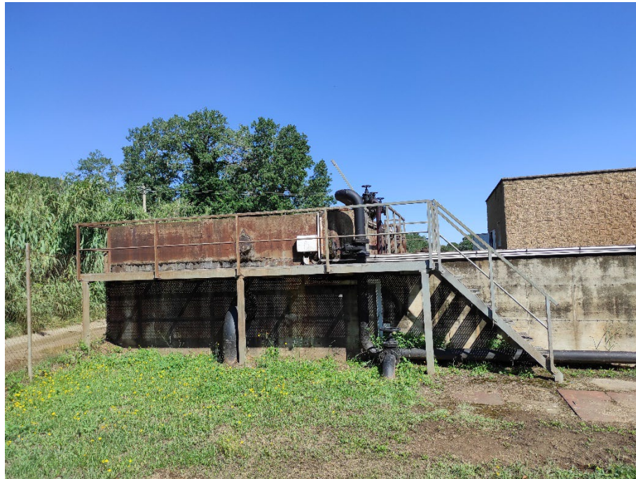
Fotografia 13. Edifici de recuperació d'aigua
