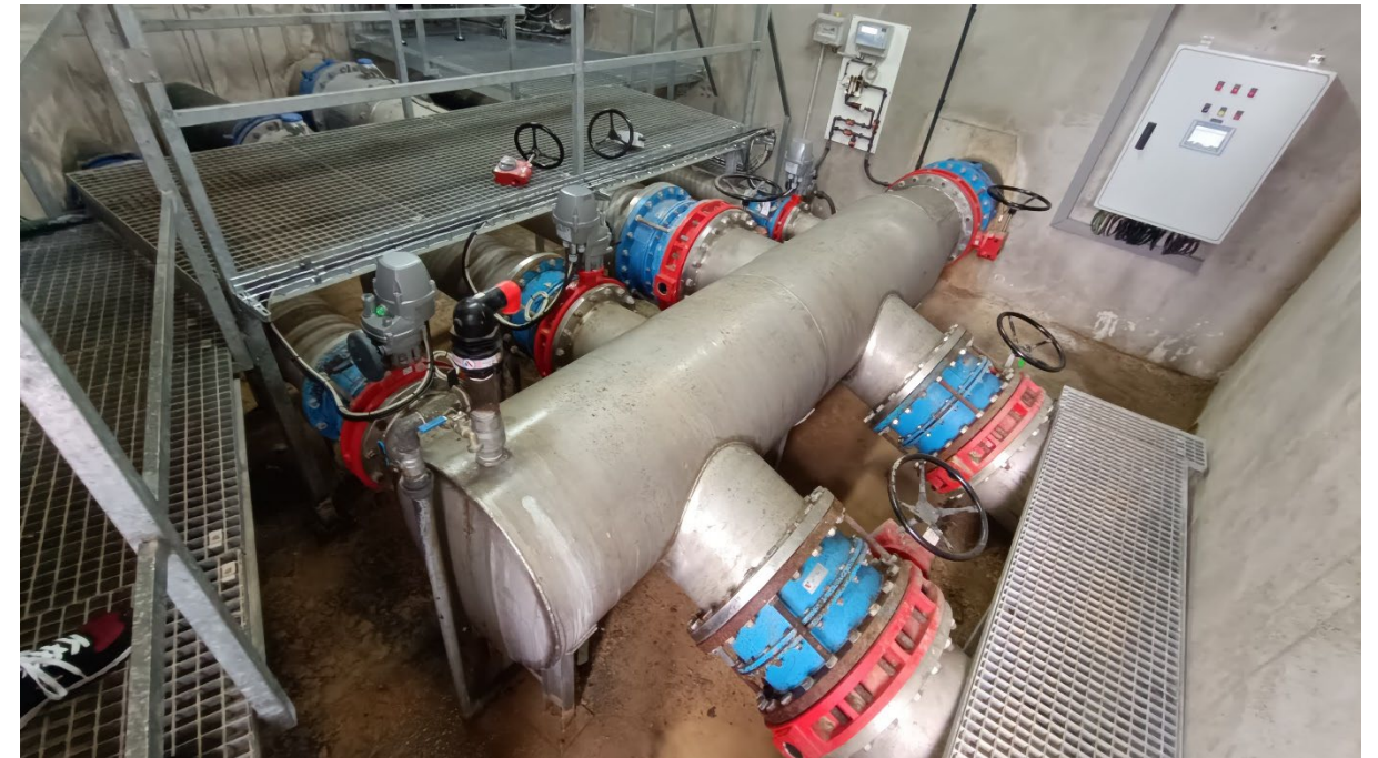
Fotografia 67. Vàlvules dipòsit Quermany nou
