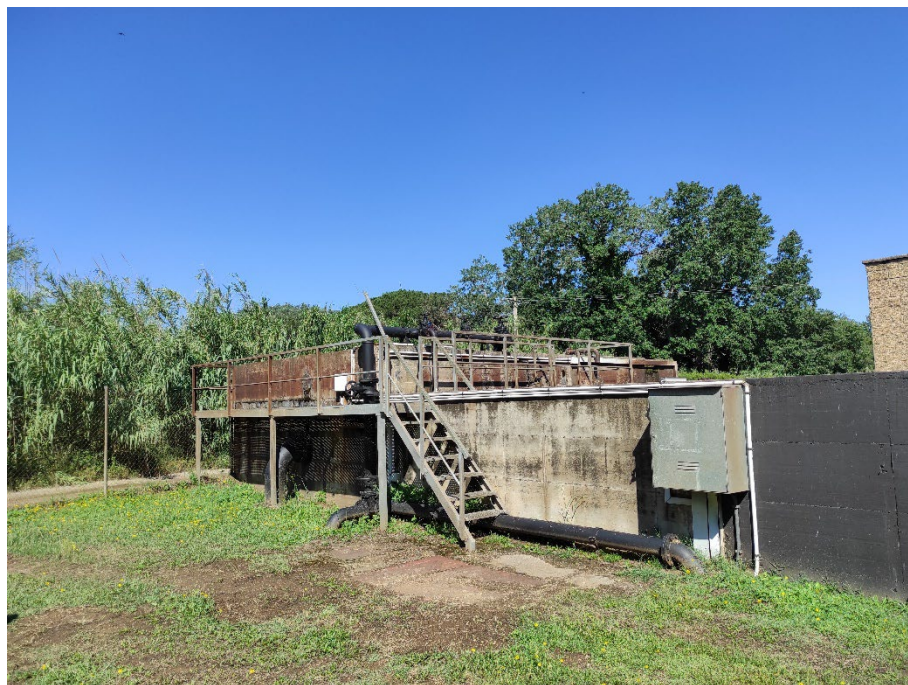
Fotografia 14. Edifici de recuperació d'aigua
