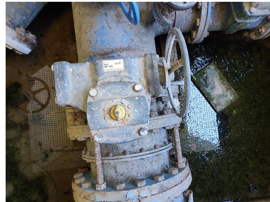
Fotografia 32. Valvuleria interior de l'arqueta
