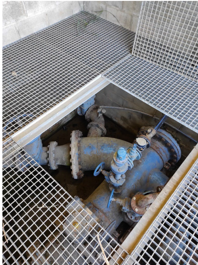
Fotografia 33. Valvuleria interior de l'arqueta
