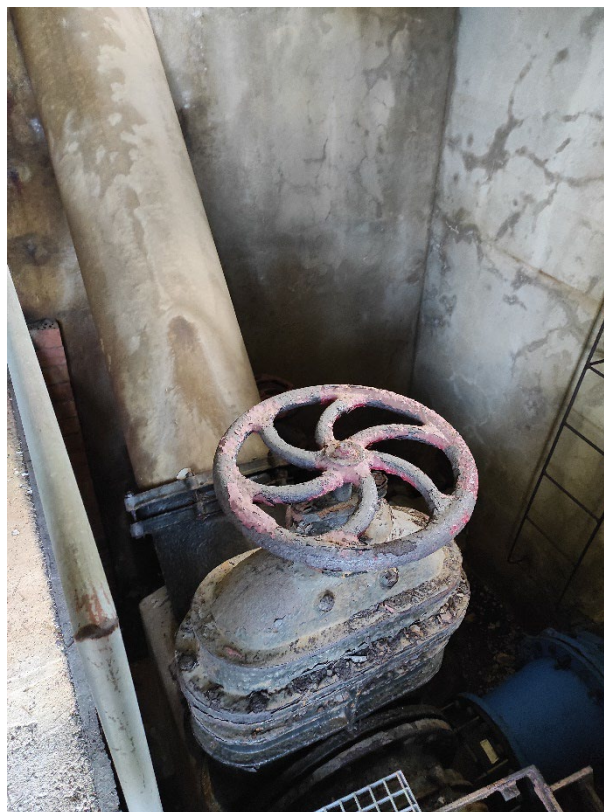
Fotografia 70. Vàlvules dipòsit Quermany vell
