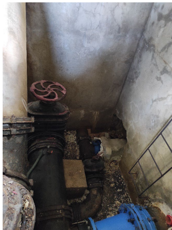
Fotografia 74. Vàlvules dipòsit Quermany vell
