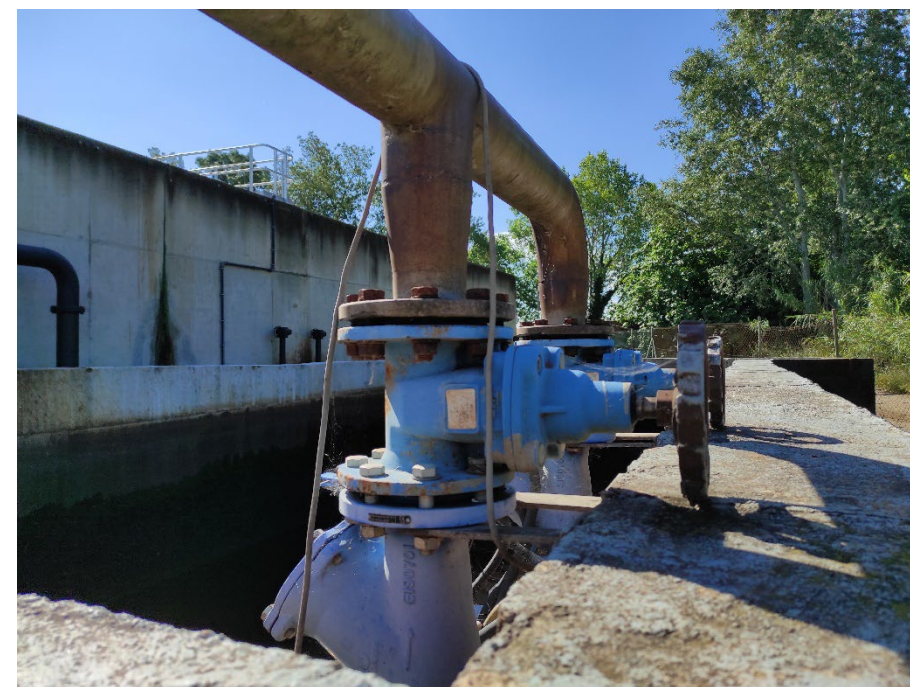
Fotografia 8. Vàlvules dipòsit de purgues
