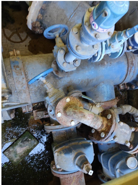
Fotografia 29. Valvuleria interior de l'arqueta
