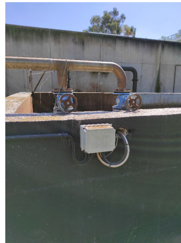
Fotografia 12. Vàlvules dipòsit de purgues
