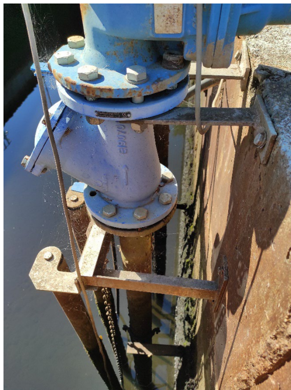
Fotografia 10. Vàlvules dipòsit de purgues
