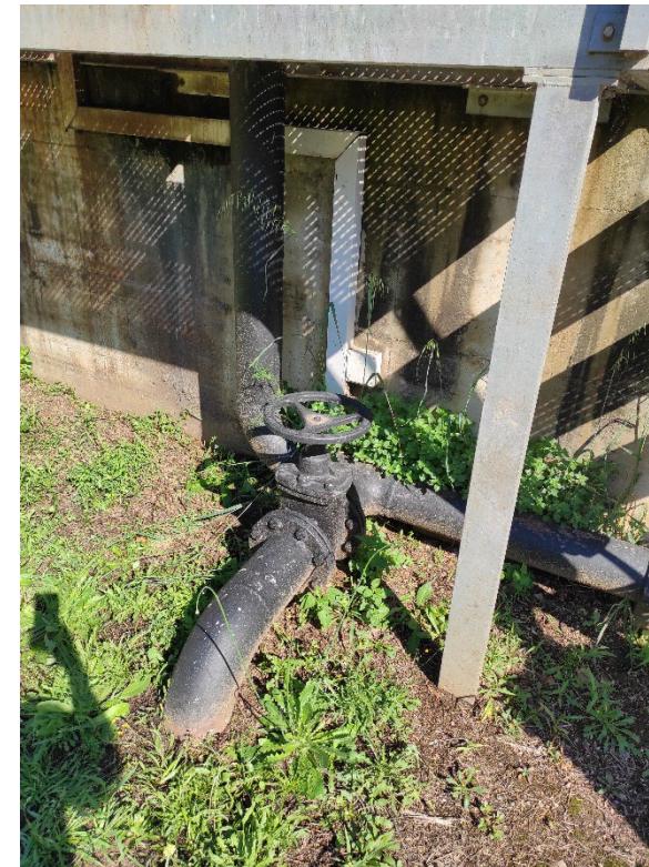
Fotografia 15. Vàlvules recuperació d'aigua
