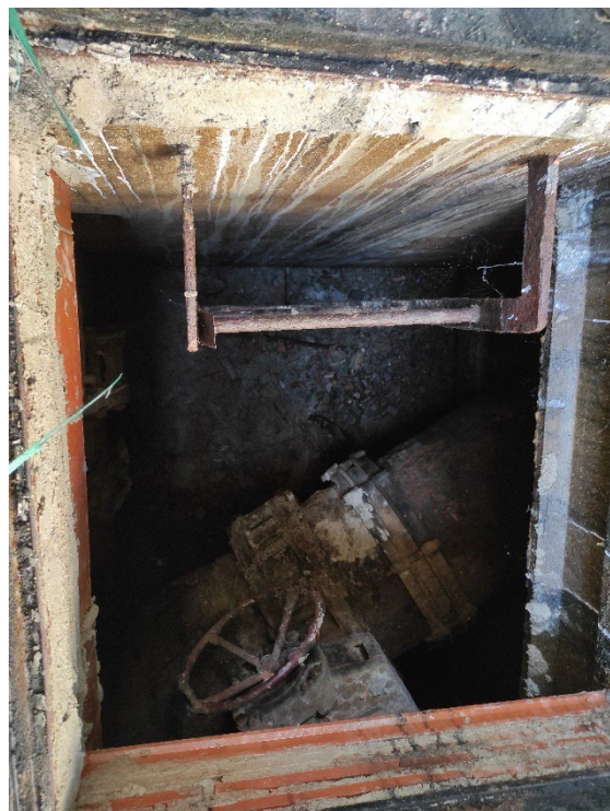
Fotografia 50. Vàlvules bypass connexió decantador-filtres
