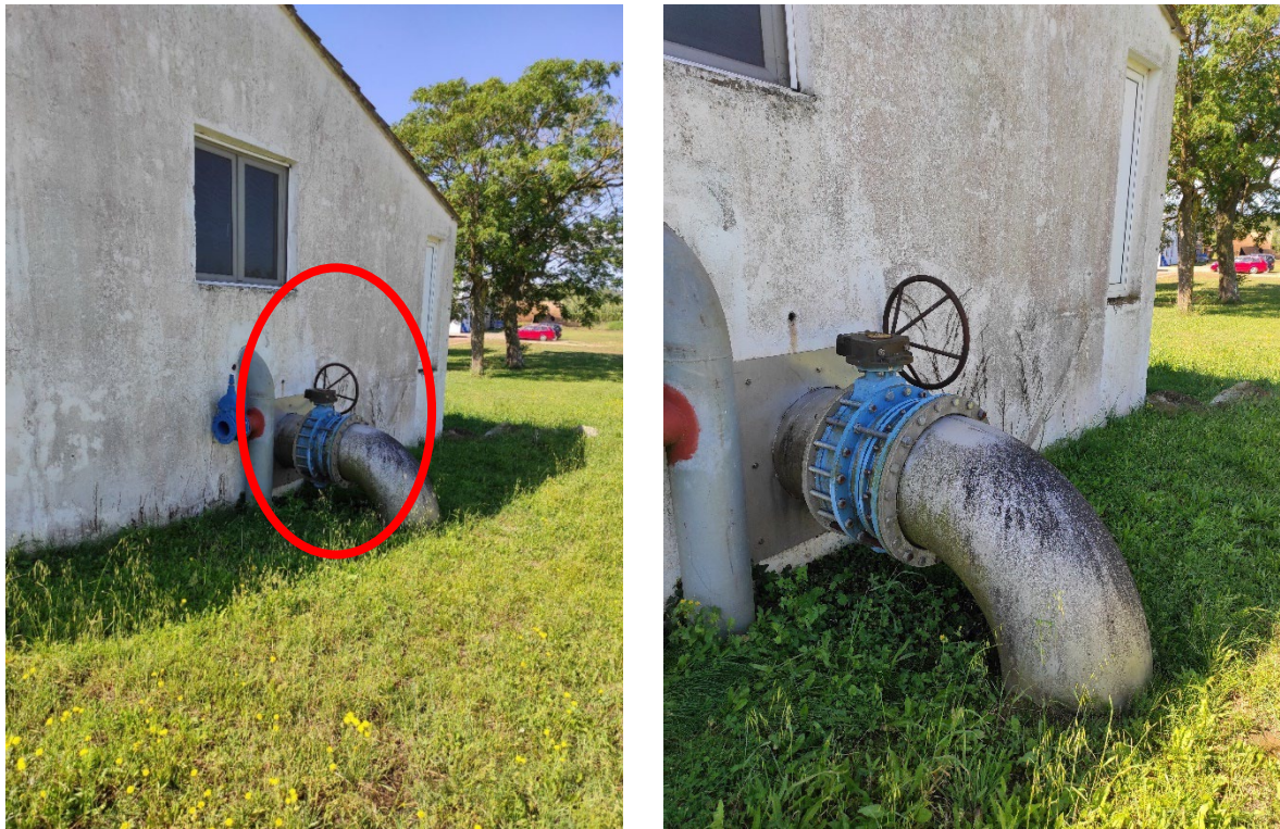
Figura 27. Vàlvula captació piscina
