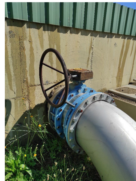
Fotografia 48. Vàlvula captació piscina
