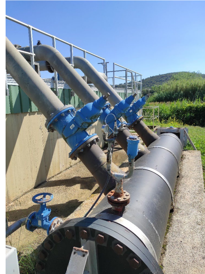
Fotografia 39. Vàlvules impulsió a Quermany
