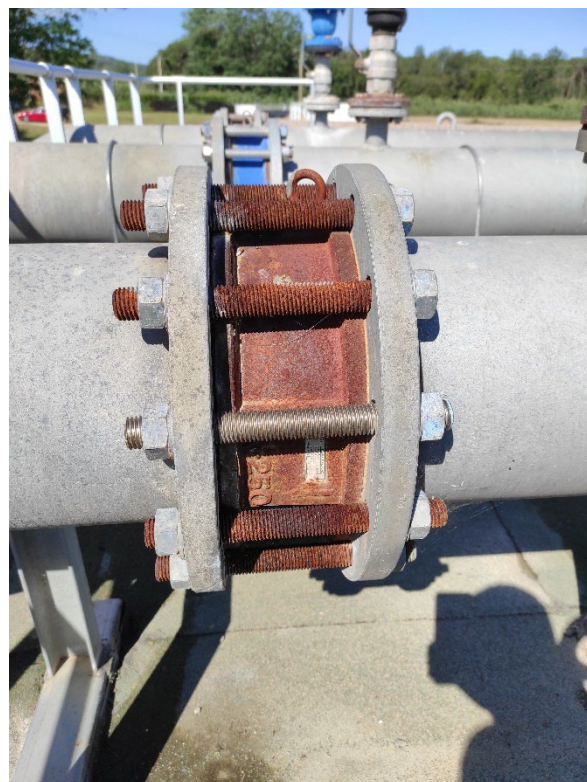
Fotografia 42. Vàlvules impulsió a Quermany
