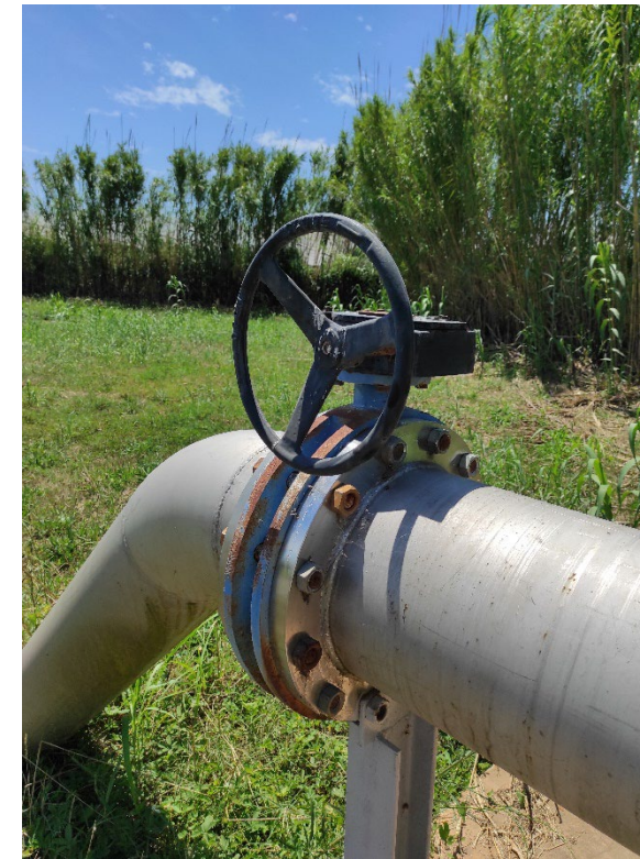
Fotografia 87. Vàlvules pou E captació Gualta
