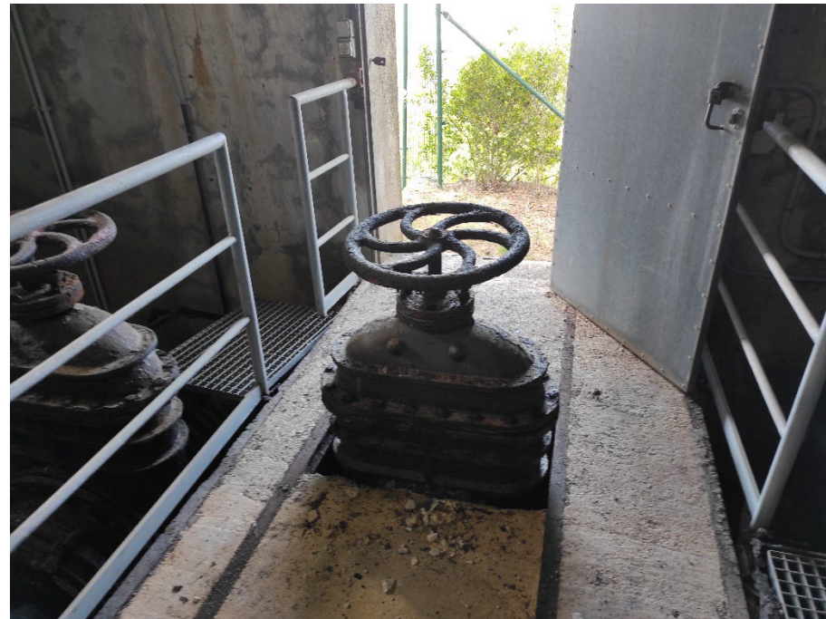
Fotografia 77. Vàlvules dipòsit Quermany vell
