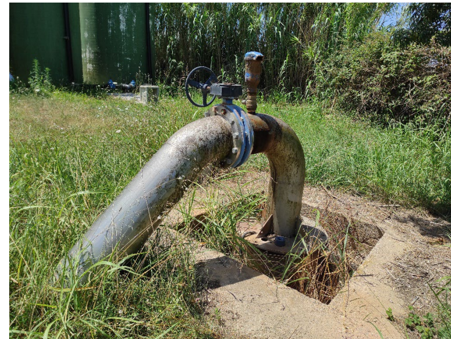
Fotografia 79. Vàlvules pou D captació Gualta
