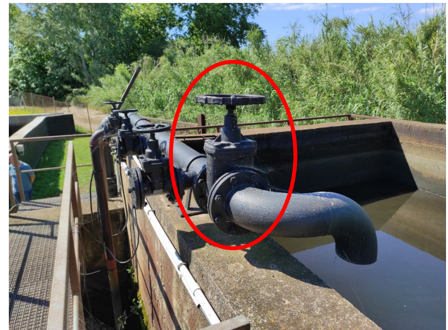
Figura 12. Vàlvula recuperació d'aigua
