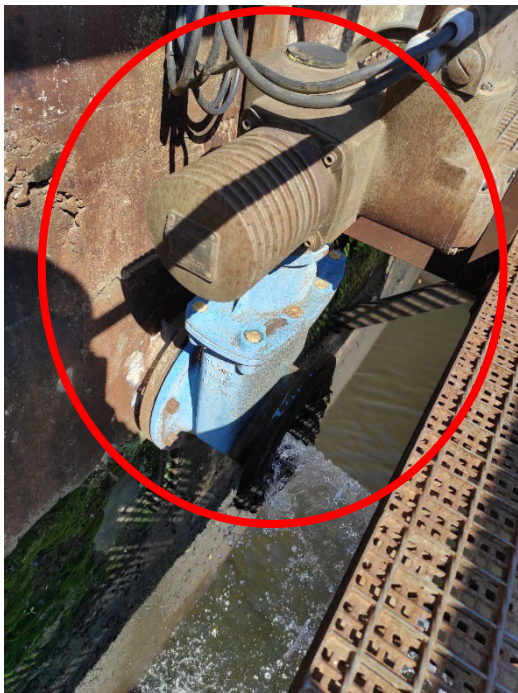
Figura 13. Vàlvula recuperació d'aigua
