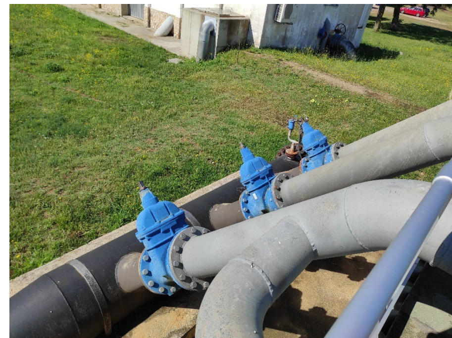
Fotografia 40. Vàlvules impulsió a Quermany
