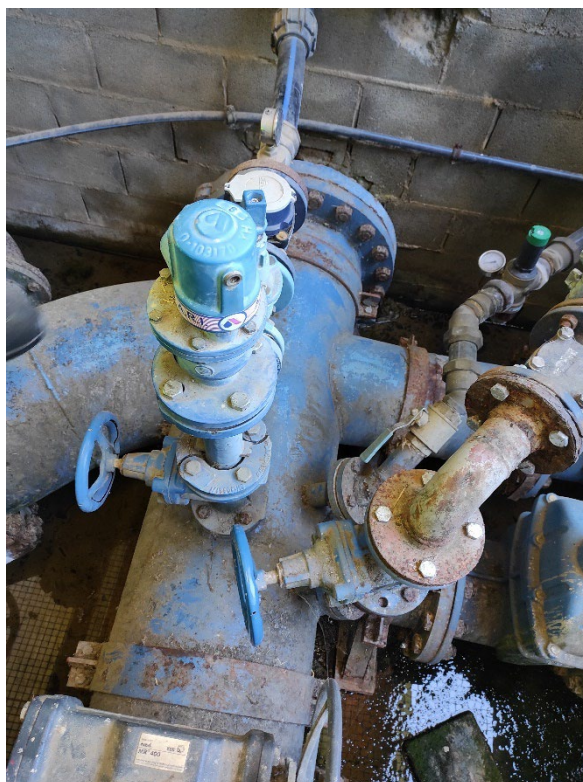
Fotografia 30. Valvuleria interior de l'arqueta
