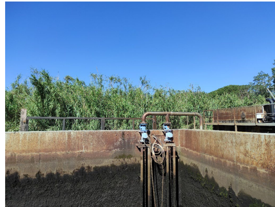
Fotografia 7. Vàlvules dipòsit de purgues
