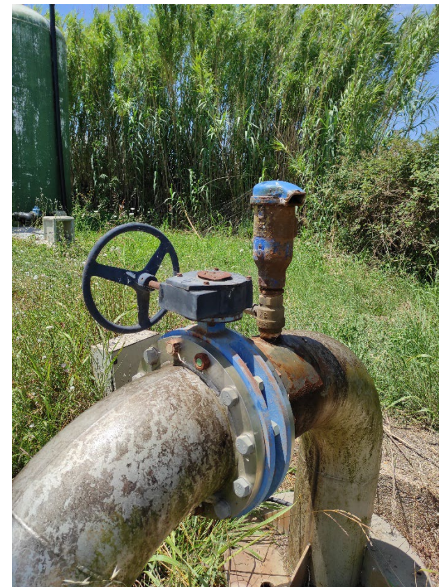
Fotografia 80. Vàlvules pou D captació Gualta
