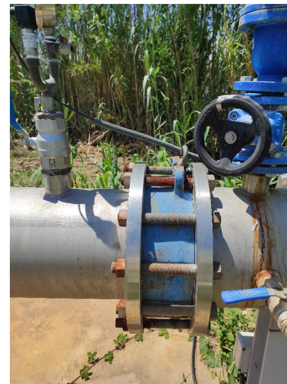
Fotografia 88. Vàlvules pou E captació Gualta
