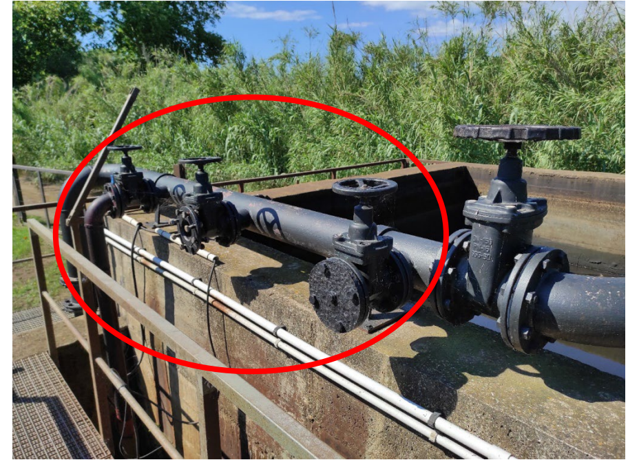
Figura 11. Vàlvules recuperació d'aigua
