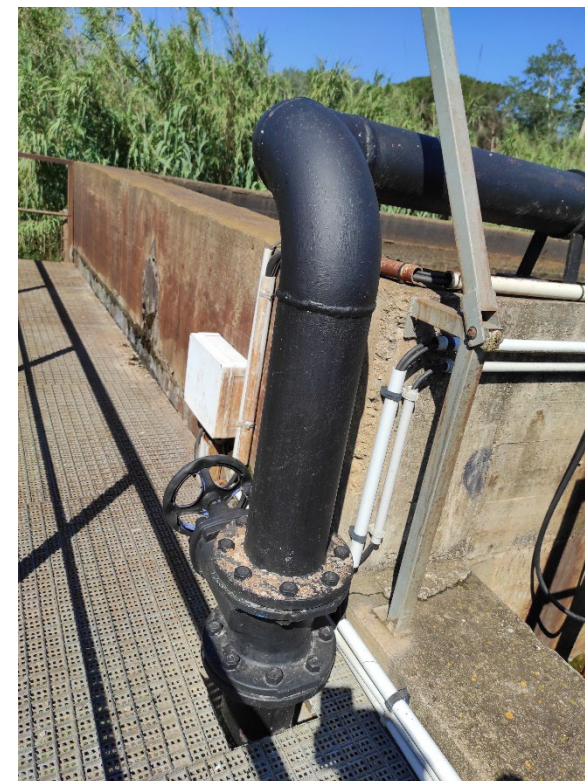
Fotografia 16. Vàlvules recuperació d'aigua
