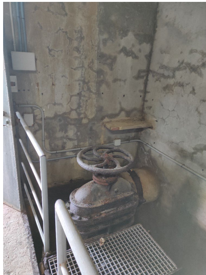
Fotografia 78. Vàlvules dipòsit Quermany vell
