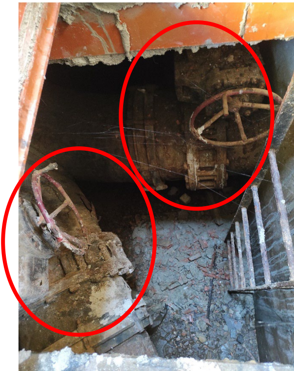
Figura 29. Vàlvules arqueta by-pass connexió decantador-filtres
