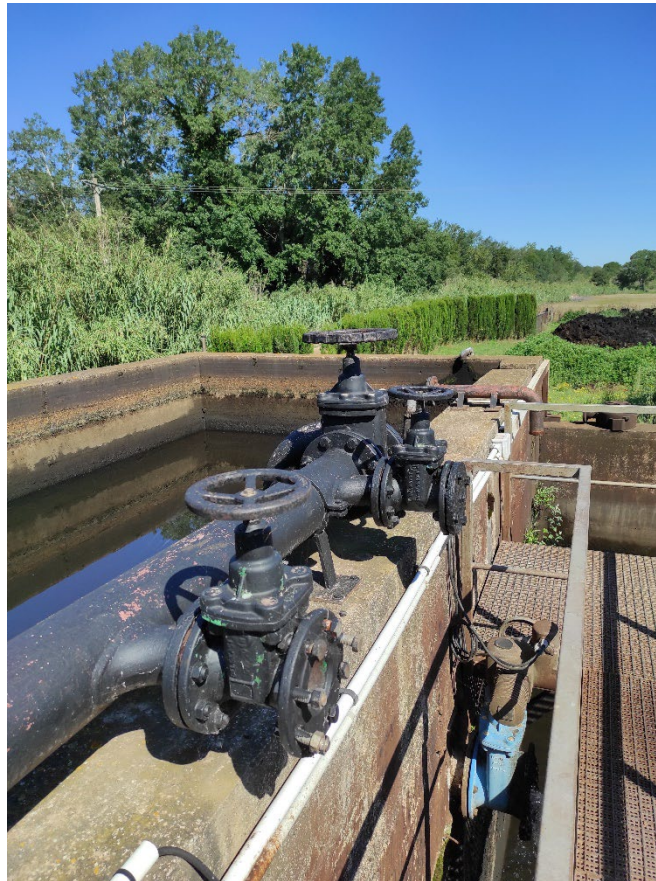
Fotografia 21. Vàlvules recuperació d'aigua
