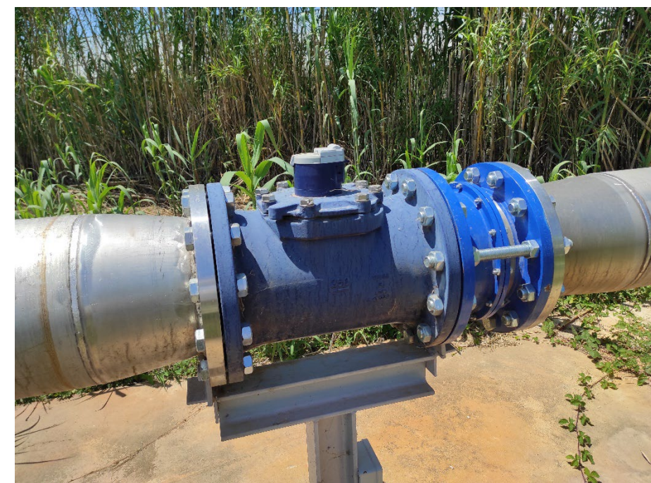
Fotografia 84. Vàlvules pou E captació Gualta
