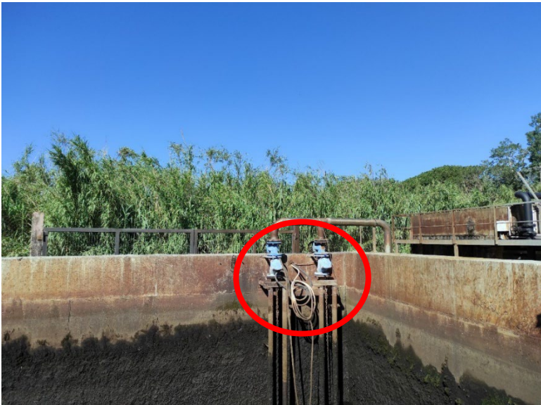
Figura 6. Vàlvules impulsió dipòsit de purgues
