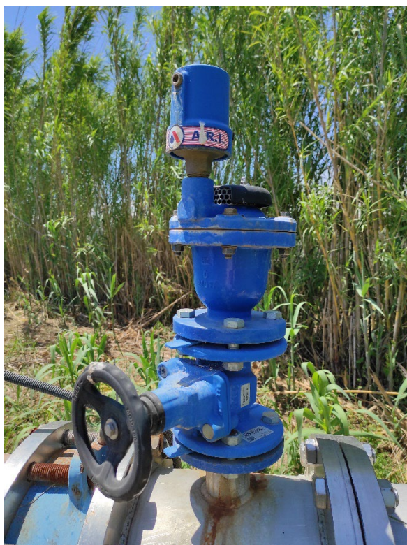
Fotografia 86. Vàlvules pou E captació Gualta
