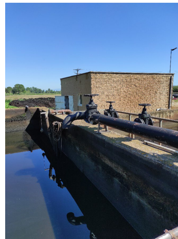
Fotografia 20. Vàlvules recuperació d'aigua
