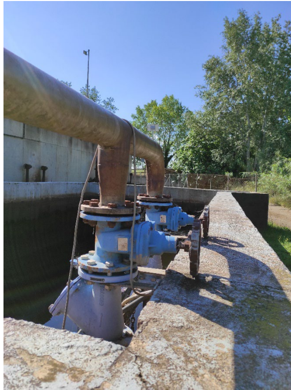
Fotografia 9. Vàlvules dipòsit de purgues
