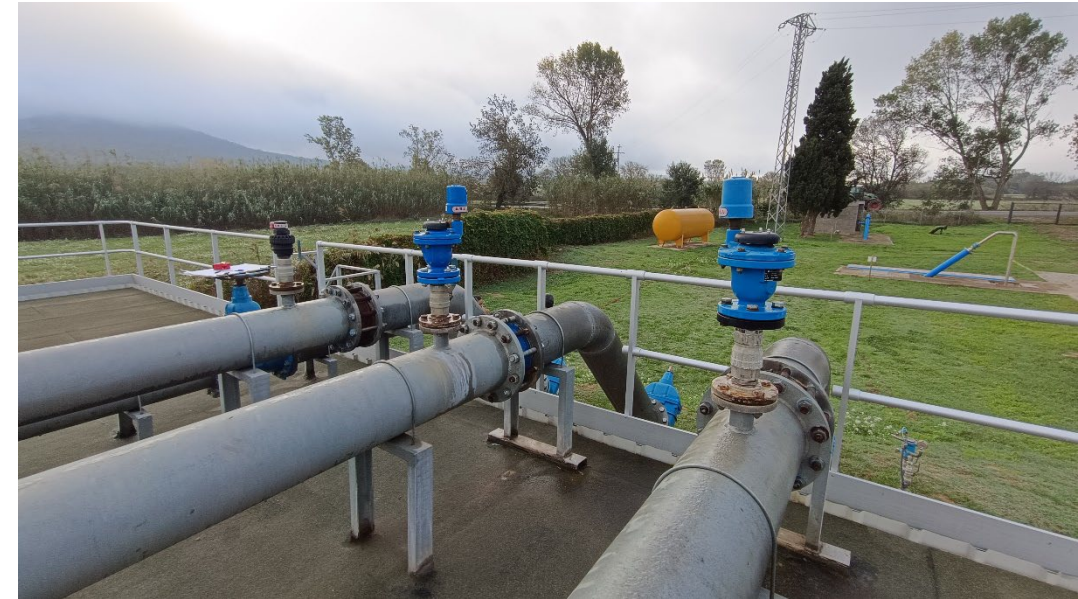
Fotografia 43. Vàlvules impulsió a Quermany
