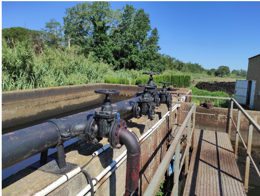
Fotografia 17. Vàlvules recuperació d'aigua
