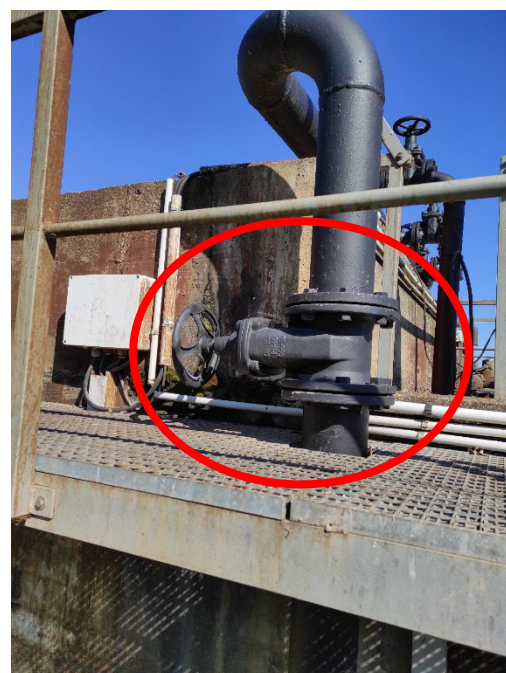
Figura 10. Vàlvula recuperació d'aigua
