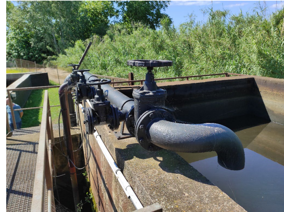
Fotografia 23. Vàlvules recuperació d'aigua
