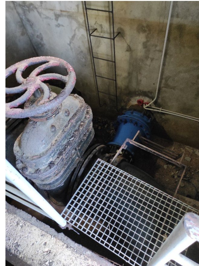
Fotografia 71. Vàlvules dipòsit Quermany vell
