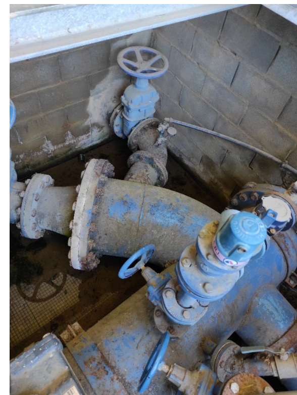
Fotografia 28. Valvuleria interior de l'arqueta
