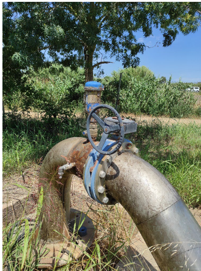
Fotografia 82. Vàlvules pou D captació Gualta
