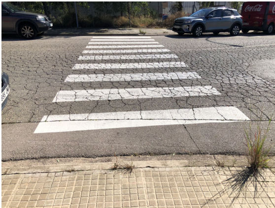
Rampa de pas de vianants inexistent
