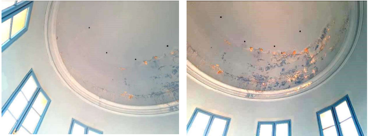
Foto dels danys provocats al revestiment per la filtració d'aigua provinent de la cúpula i dels danys que poden derivar-se'n per una possible caiguda d'aigua i material al vestíbul principal que pren més importància atès que es tracta d'un paviment original de tessel·les.
