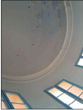
Revestiment interior casquet cúpula, enguixat i pintat, amb deficiències.
