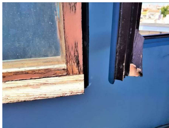
Estat de marcs de finestres i dels escopidors
