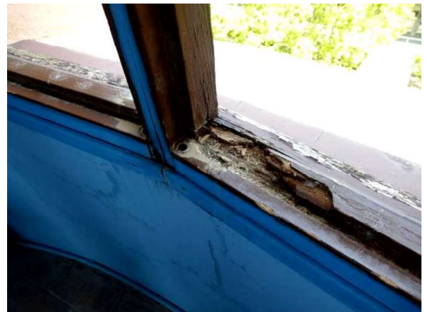
Estat de la fusteria. Marcs
