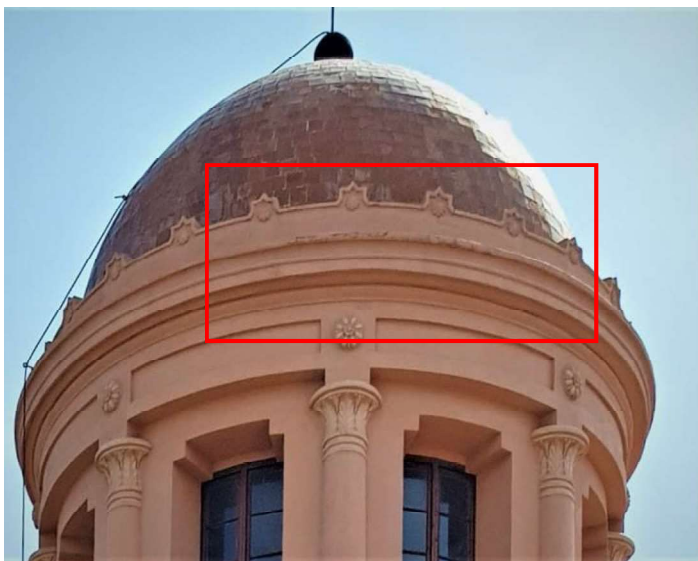
Cornisa. Desgast de pintura
