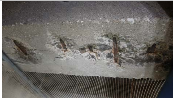
Figura 3. Patologia 3 – Despreniment parcial del formigó
