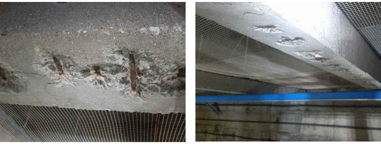
DESPRENIMENT PARCIAL DEL FORMIGÓ
