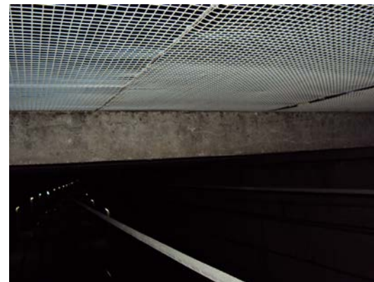
Figura 5. Patologia 5 – Deformació excessiva
