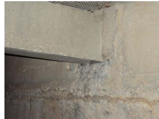
Figura 6. Patologia 6 – Defectes en el suport
