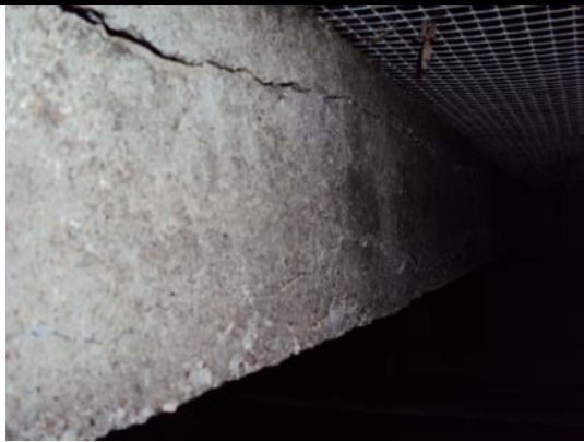
Figura 2. Patologia 2 - Fissures i esquerdes
