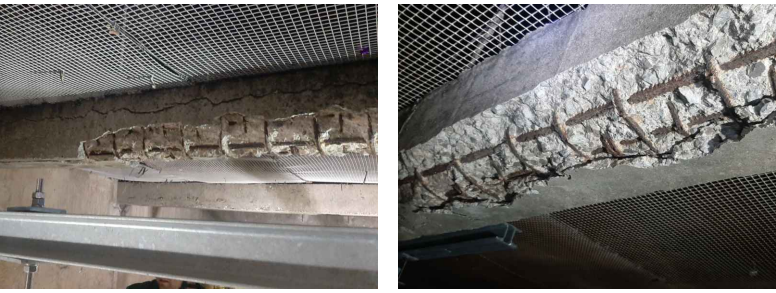
DESPRENIMENT TOTAL DEL FORMIGÓ
