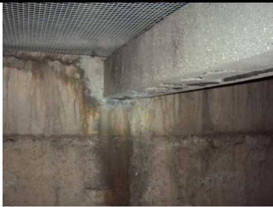
Figura 1. Patologia 1 - Eflorescències i humitats
