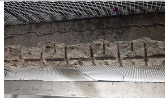
Figura 4. Patologia 4 – Despreniment total del formigó
