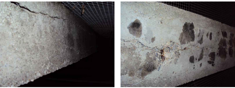
FISSURES I ESQUERDES
