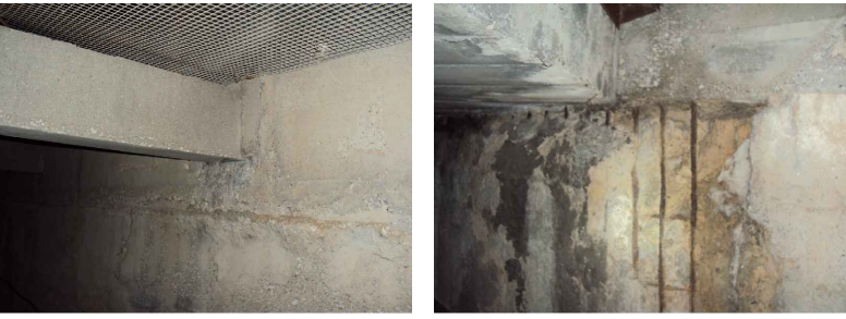
DEFECTES EN EL SUPORT
