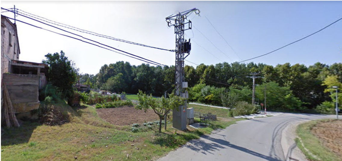
Imatge del centre transformador emplaçat en una torre metàl·lica a l'entrada del poble
