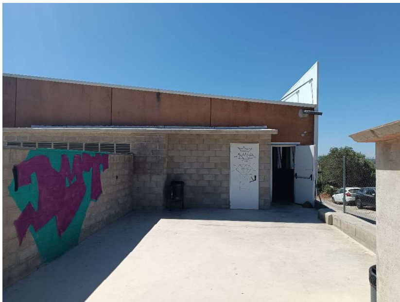
Fig. 21 Vista de zona d'inversor i recorregut cablejat des de coberta
