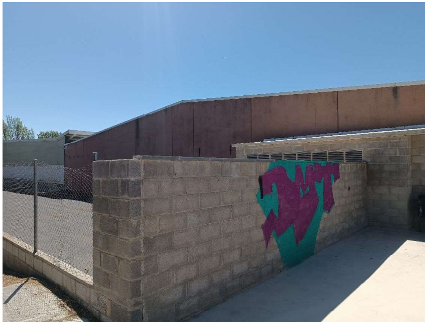
Fig. 20 Vista de zona d'inversor i proteccions
