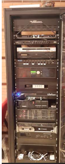
Il·lustració 5 Rack actual de la sala de Plens
