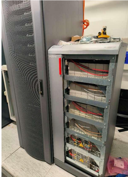
Fig. 2. SAI (mòdul de bateries)
