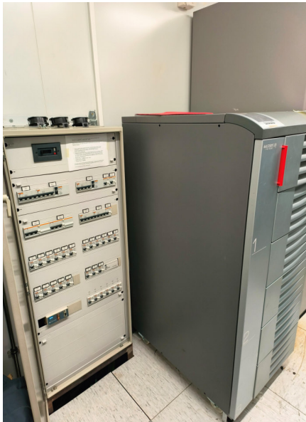
Fig. 1. SAI (mòduls de potència) i quadre elèctric
