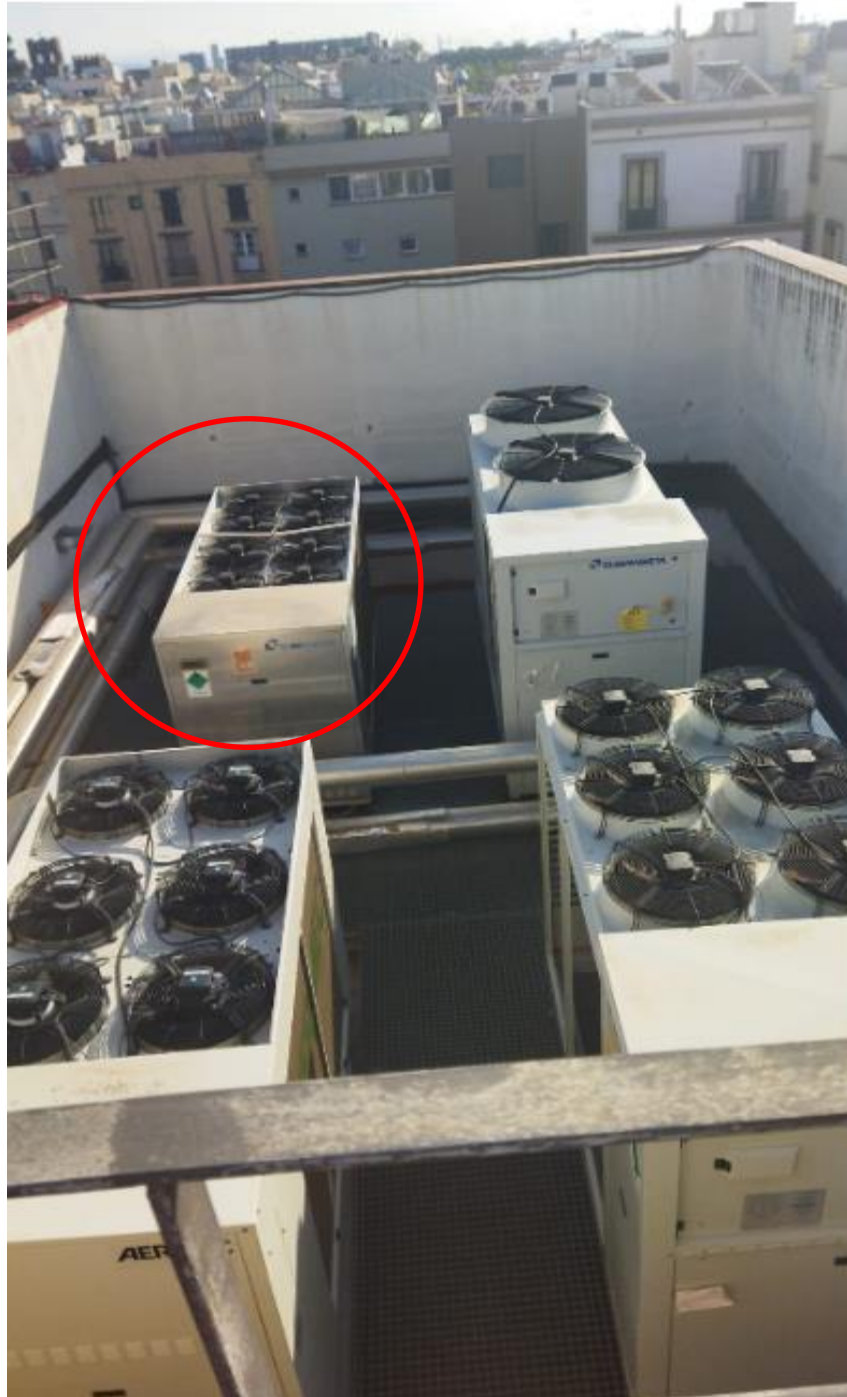
Unitat Climaveneta a substituir (unitat al fons a l'esquerra)
