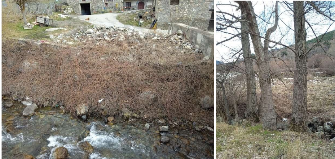
Imatge 5. Esquerra: llera coberta de vegetació invasora que dificulta el flux. Dreta: arbres que neixen al marge i creixen en direcció a la llera impedit el flux en cas d'avinguda.
