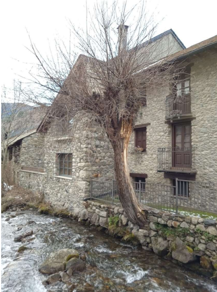
Imatge 4. Els murs d'endegament es troben descalçats en alguns punts. En alguns casos, els habitatges queden just a sobre d'aquests murs, sent crucial la seva estabilitat.
