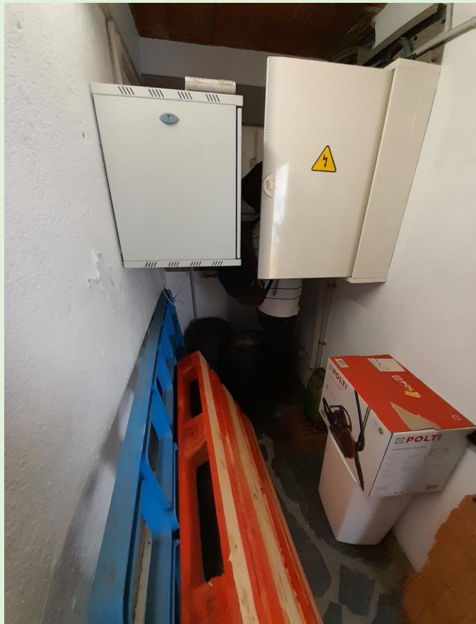
Exemple d'una sala tècnica amb quadres elèctrics utilitzat a la vegada com a magatzem.
