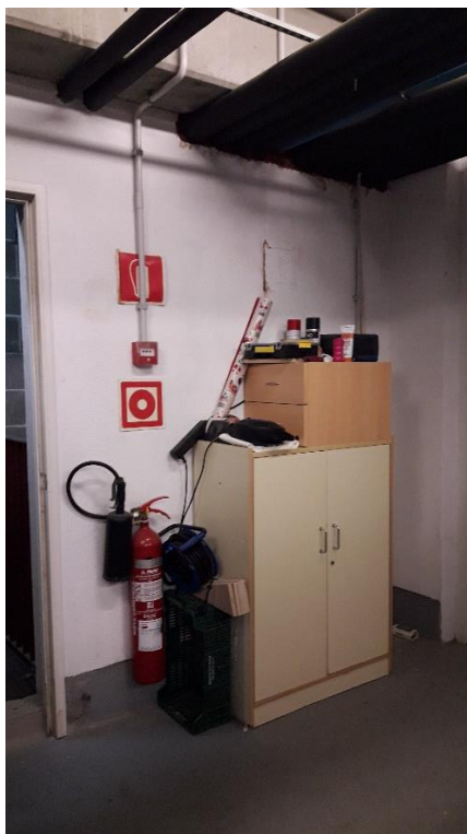
Fotografia 5 UBICACIÓ DE L'INVERSOR
