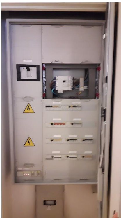
Fotografia 6 QGBT DE L'EDIFICI
