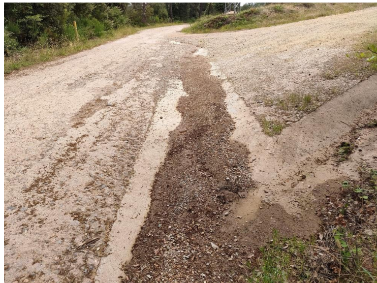
IMG 13. Gual de formigó en l'entroncament dels camins, amb acumulació de materials granulars arrossegats.
