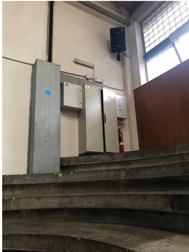
Imatge del quadre elèctric
