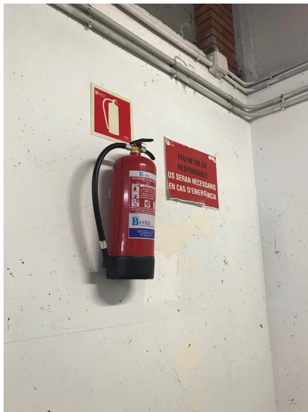
Imatge Protecció contra incendis: Extintors
