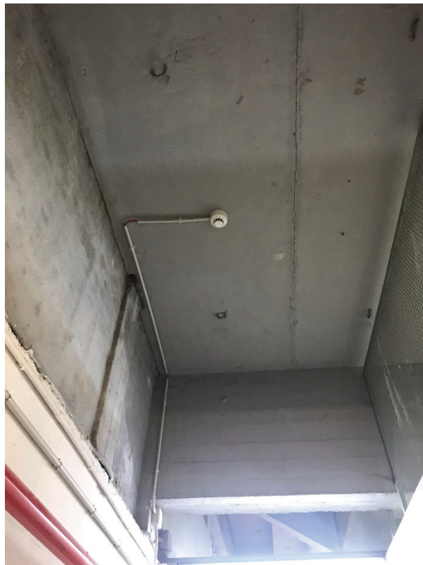
Imatge Protecció contra incendis: Detectores de fums
