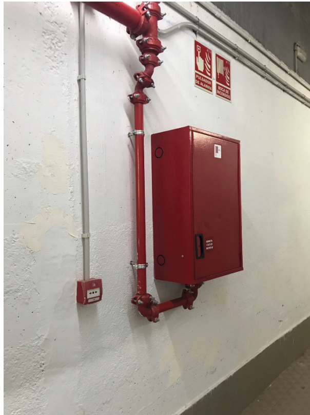
Imatge Protecció contra incendis: BIE
