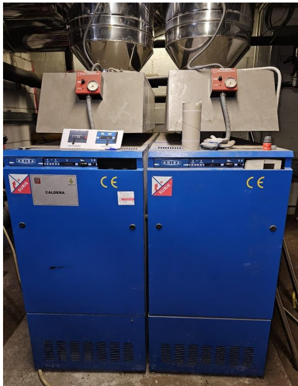
Calderes existents de 280 kW nominals.
