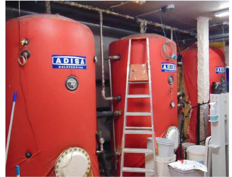
DIPÒSITS ACTUALS (EQUIPS A SUBSTITUIR)
