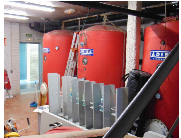
DIPÒSITS ACTUALS (EQUIPS A SUBSTITUIR)
