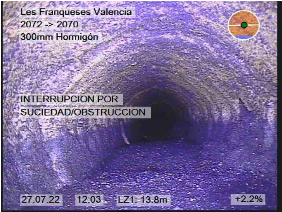
22.jpg, 00:04:21, 13.80m INTERRUPCION POR SUCIEDAD/OBSTRUCCION
