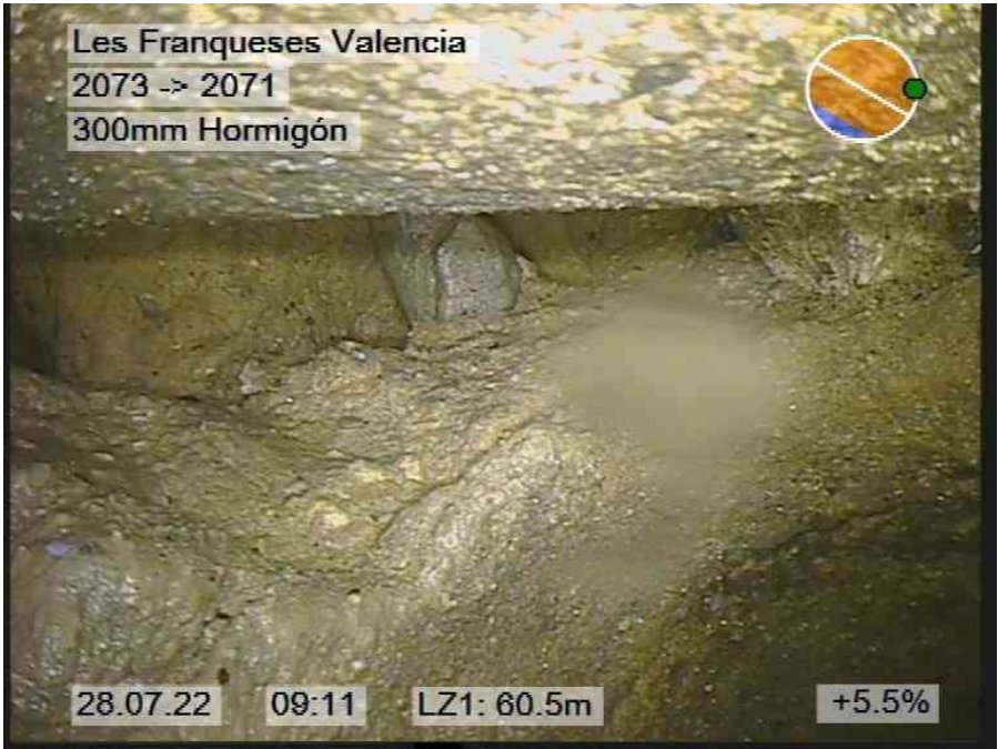
67.jpg, 00:12:24, 60.50m ENTRONQUE DE LA CONEXION DEFECTUOSA desde 12 Reloj a 2 Reloj
