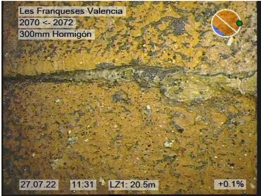
12.jpg, 00:05:02, 20.50m REPARACION POR desde 7 Reloj a 5 Reloj
