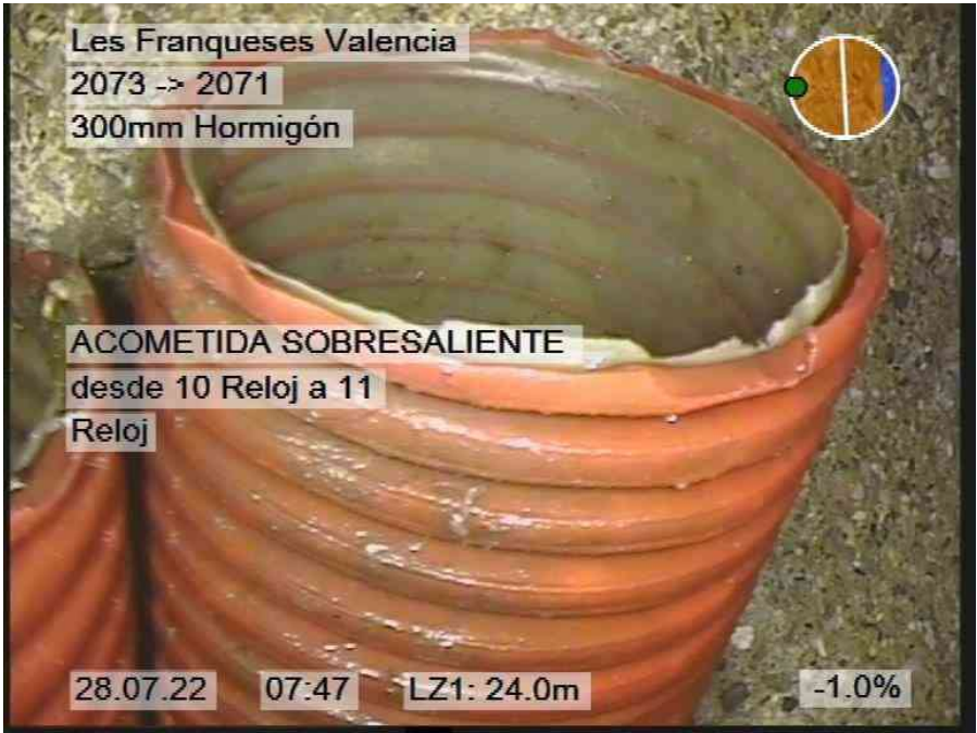
43.jpg, 00:04:32, 24.00m ACOMETIDA SOBRESALIENTE desde 10 Reloj a 11 Reloj
