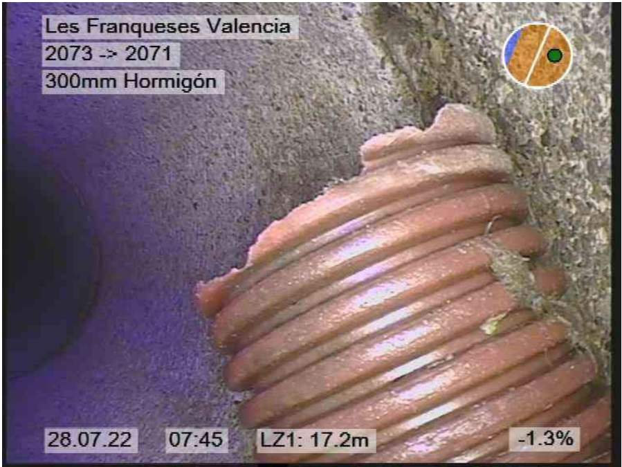
38.jpg, 00:03:07, 17.20m ACOMETIDA SOBRESALIENTE desde 1 Reloj a 2 Reloj
