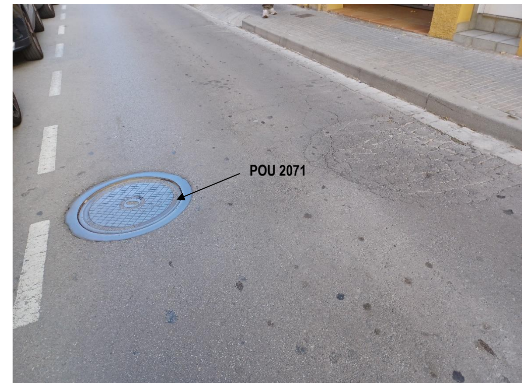
Fotografia 10. Final del carrer Valencia, pou 2071
