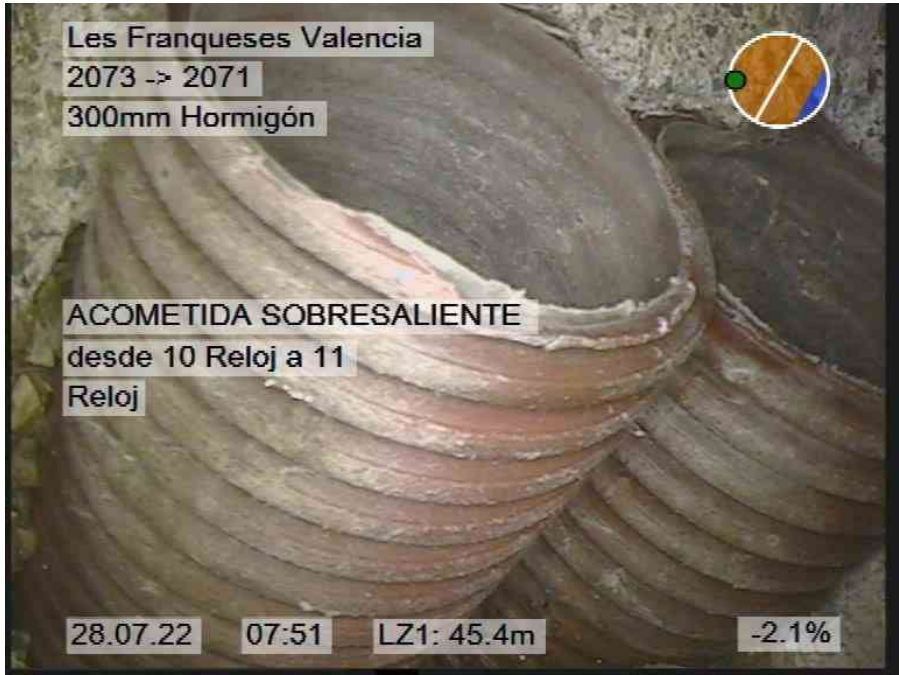
53.jpg, 00:07:45, 45.40m ACOMETIDA SOBRESALIENTE desde 10 Reloj a 11 Reloj
