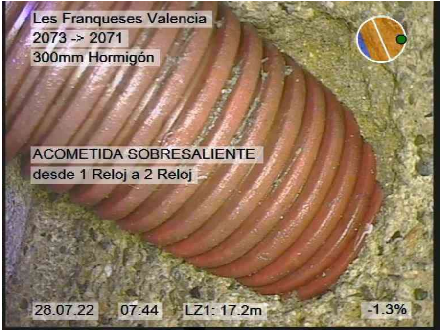
37.jpg, 00:03:07, 17.20m ACOMETIDA SOBRESALIENTE desde 1 Reloj a 2 Reloj
