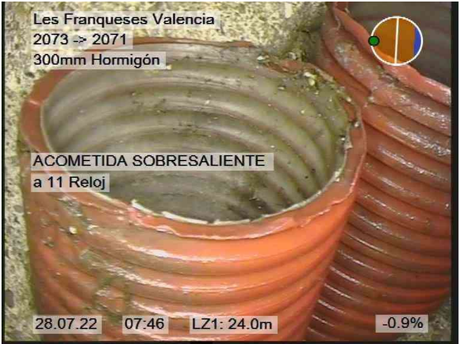
42.jpg, 00:04:26, 24.00m ACOMETIDA SOBRESALIENTE a 11 Reloj
