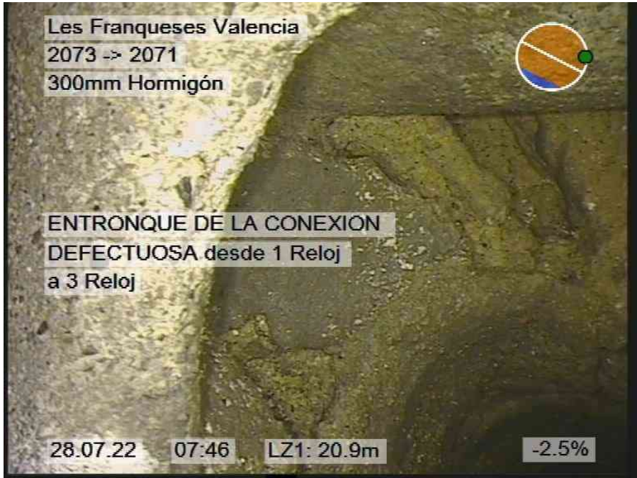
40.jpg, 00:03:54, 20.90m ENTRONQUE DE LA CONEXION DEFECTUOSA desde 1 Reloj a 3 Reloj
