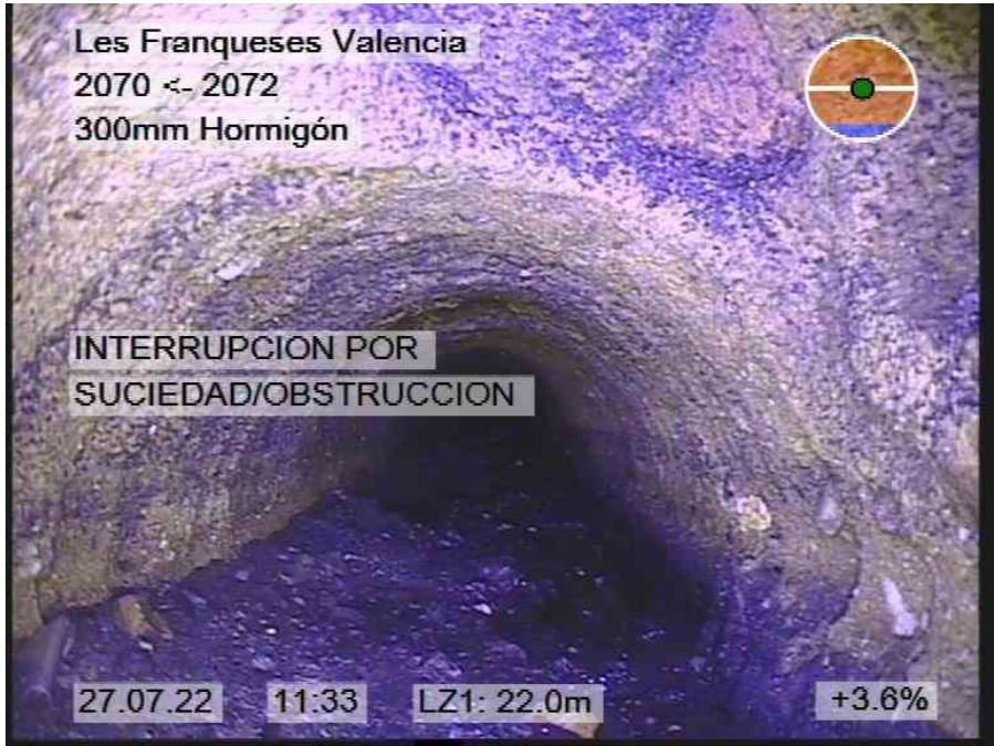
13.jpg, 00:06:13, 22.00m INTERRUPCION POR SUCIEDAD/OBSTRUCCION
