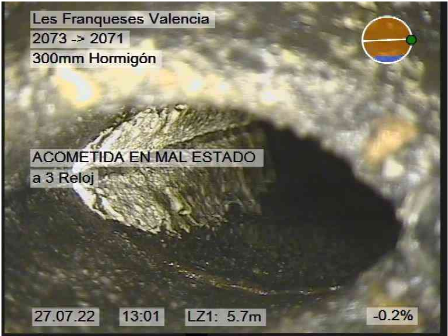
25.jpg, 00:04:18, 5.70m ACOMETIDA EN MAL ESTADO a 3 Reloj
