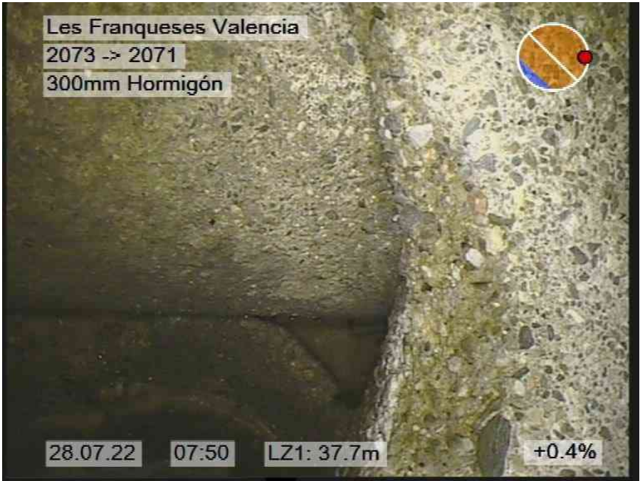
50.jpg, 00:06:40, 37.70m ENTRONQUE DE LA CONEXION DEFECTUOSA desde 1 Reloj a 2 Reloj
