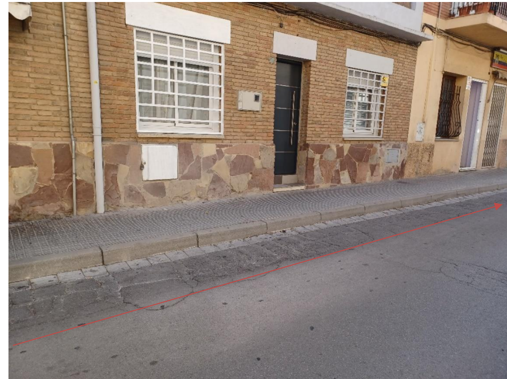
Fotografia 6: Carrer València, estat del paviment
