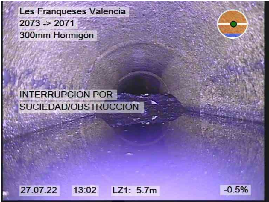
29.jpg, 00:05:13, 5.70m INTERRUPCION POR SUCIEDAD/OBSTRUCCION
