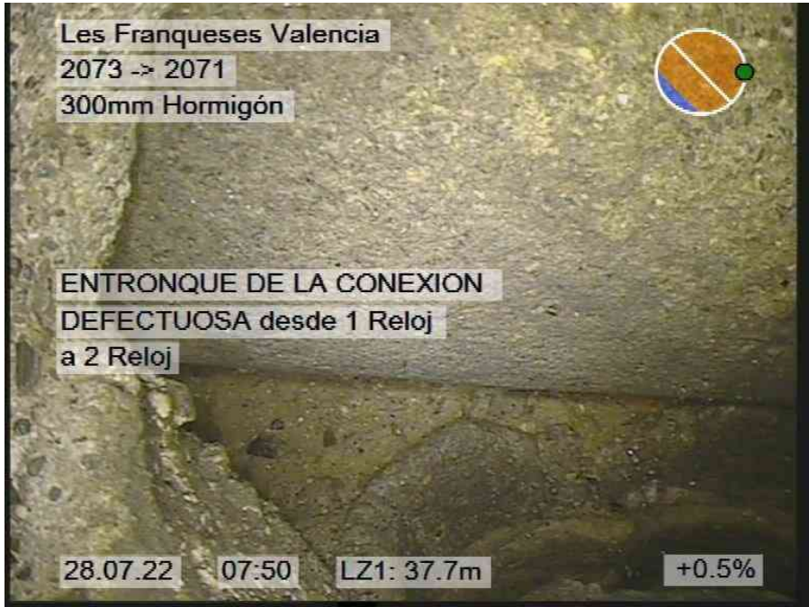
49.jpg, 00:06:40, 37.70m ENTRONQUE DE LA CONEXION DEFECTUOSA desde 1 Reloj a 2 Reloj
