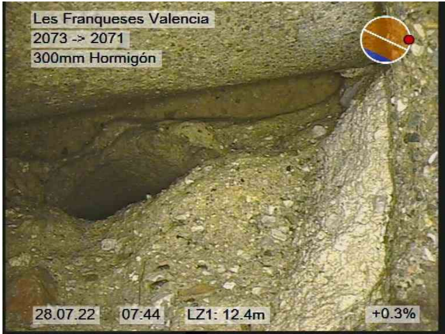
36.jpg, 00:02:28, 12.40m ENTRONQUE DE LA CONEXION DEFECTUOSA desde 1 Reloj a 5 Reloj
