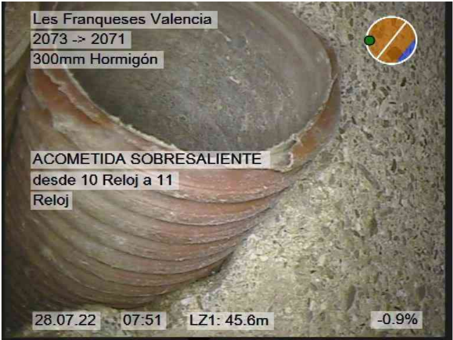
54.jpg, 00:07:50, 45.60m ACOMETIDA SOBRESALIENTE desde 10 Reloj a 11 Reloj
