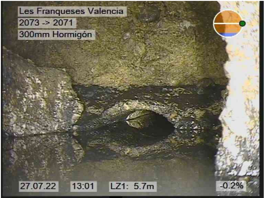
26.jpg, 00:04:18, 5.70m ACOMETIDA EN MAL ESTADO a 3 Reloj
