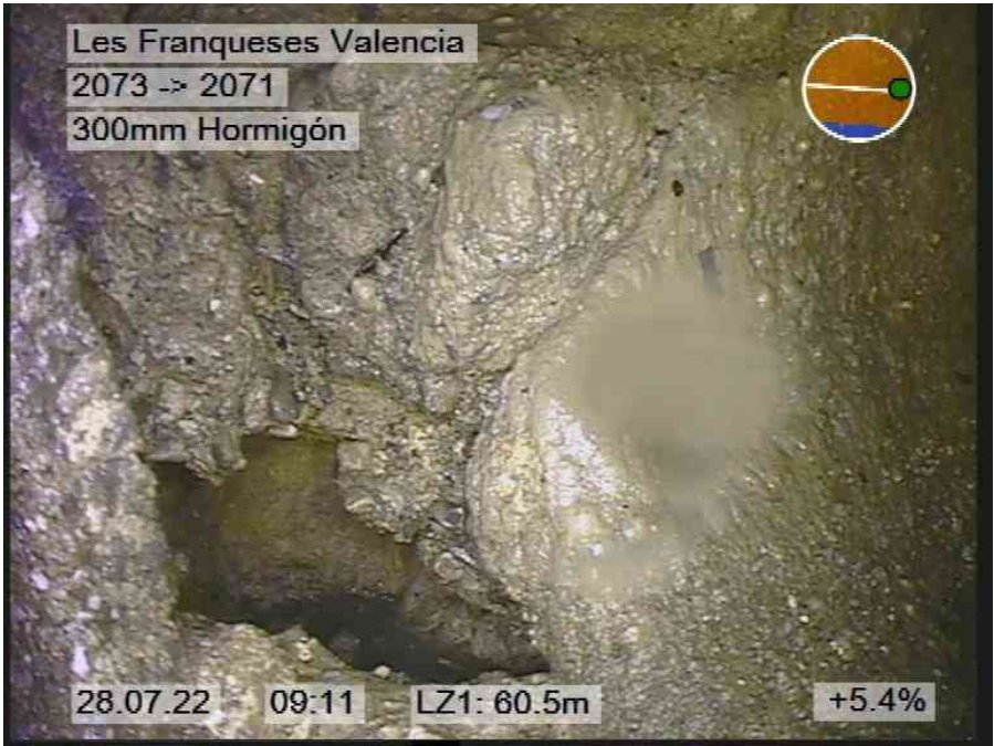
66.jpg, 00:12:24, 60.50m ENTRONQUE DE LA CONEXION DEFECTUOSA desde 12 Reloj a 2 Reloj
