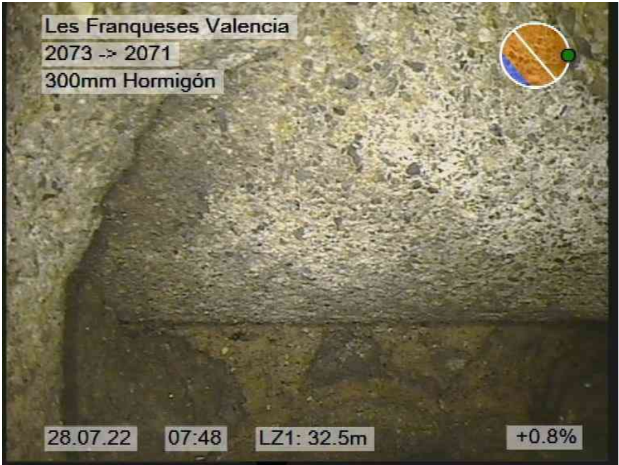
46.jpg, 00:05:32, 32.50m ENTRONQUE DE LA CONEXION DEFECTUOSA desde 1 Reloj a 2 Reloj
