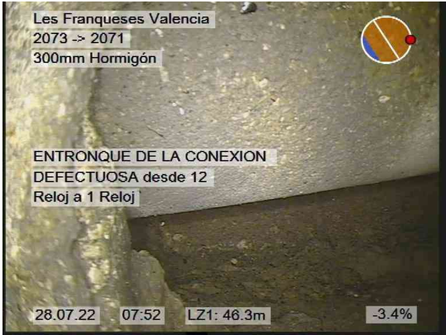
57.jpg, 00:08:15, 46.30m ENTRONQUE DE LA CONEXION DEFECTUOSA desde 12 Reloj a 1 Reloj
