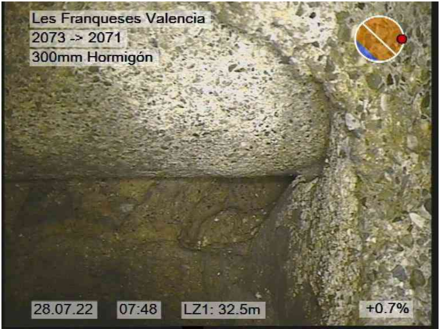
47.jpg, 00:05:32, 32.50m ENTRONQUE DE LA CONEXION DEFECTUOSA desde 1 Reloj a 2 Reloj
