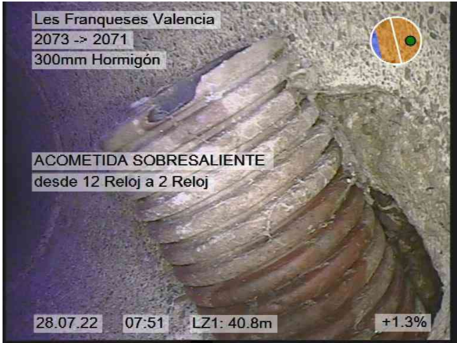
52.jpg, 00:07:16, 40.80m ACOMETIDA SOBRESALIENTE desde 12 Reloj a 2 Reloj
