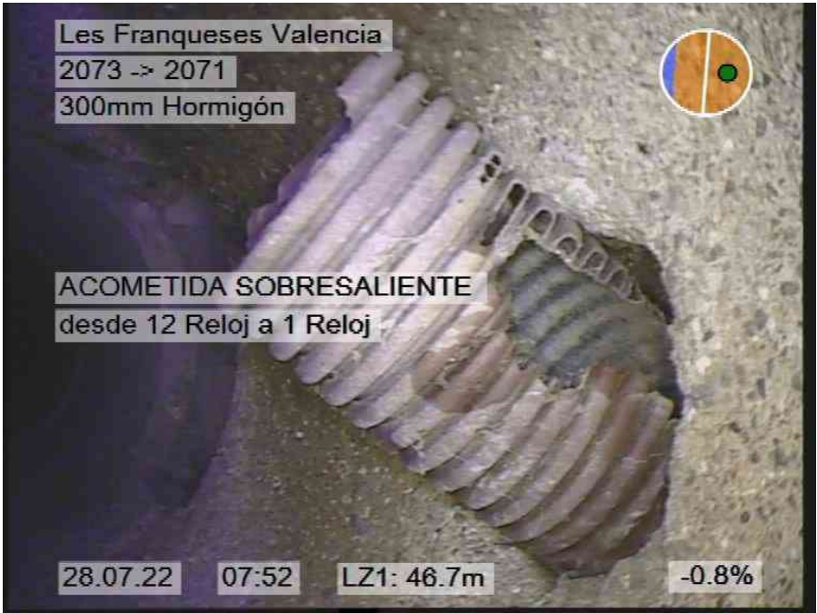
58.jpg, 00:08:31, 46.70m ACOMETIDA SOBRESALIENTE desde 12 Reloj a 1 Reloj
