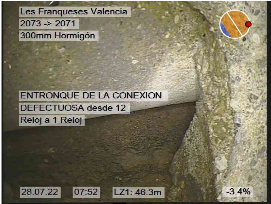
56.jpg, 00:08:15, 46.30m ENTRONQUE DE LA CONEXION DEFECTUOSA desde 12 Reloj a 1 Reloj
