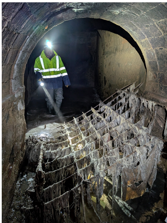
Figura 56. Reixa de desbast actual desencaixada
