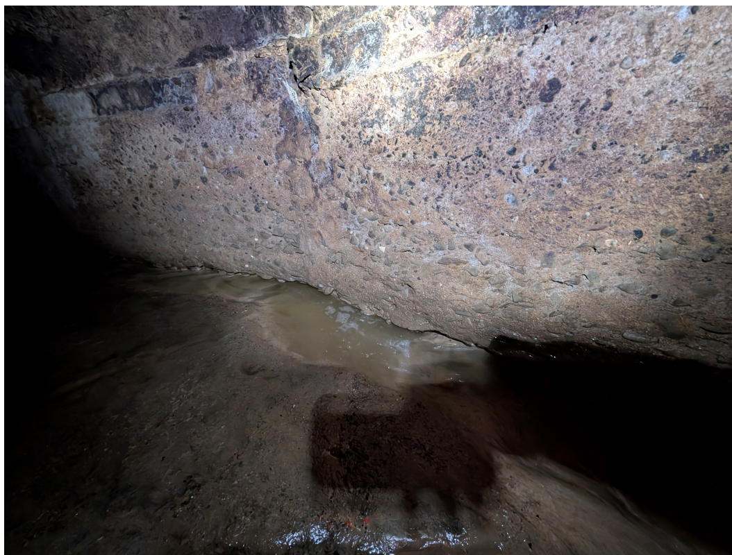
Figura 57. Erosió de peu de parament vertical
