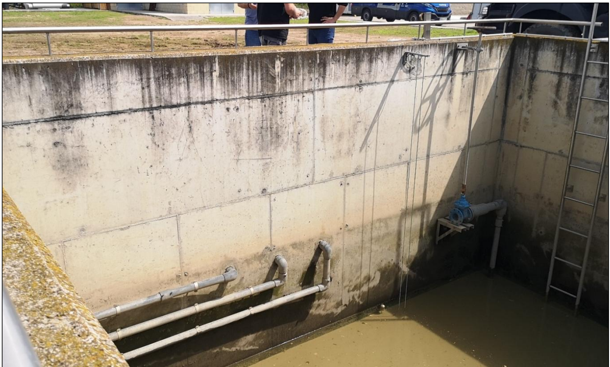
Foto - 4 – Entrada a l'arqueta de les canonades d'impulsió de les bombes submergides.
