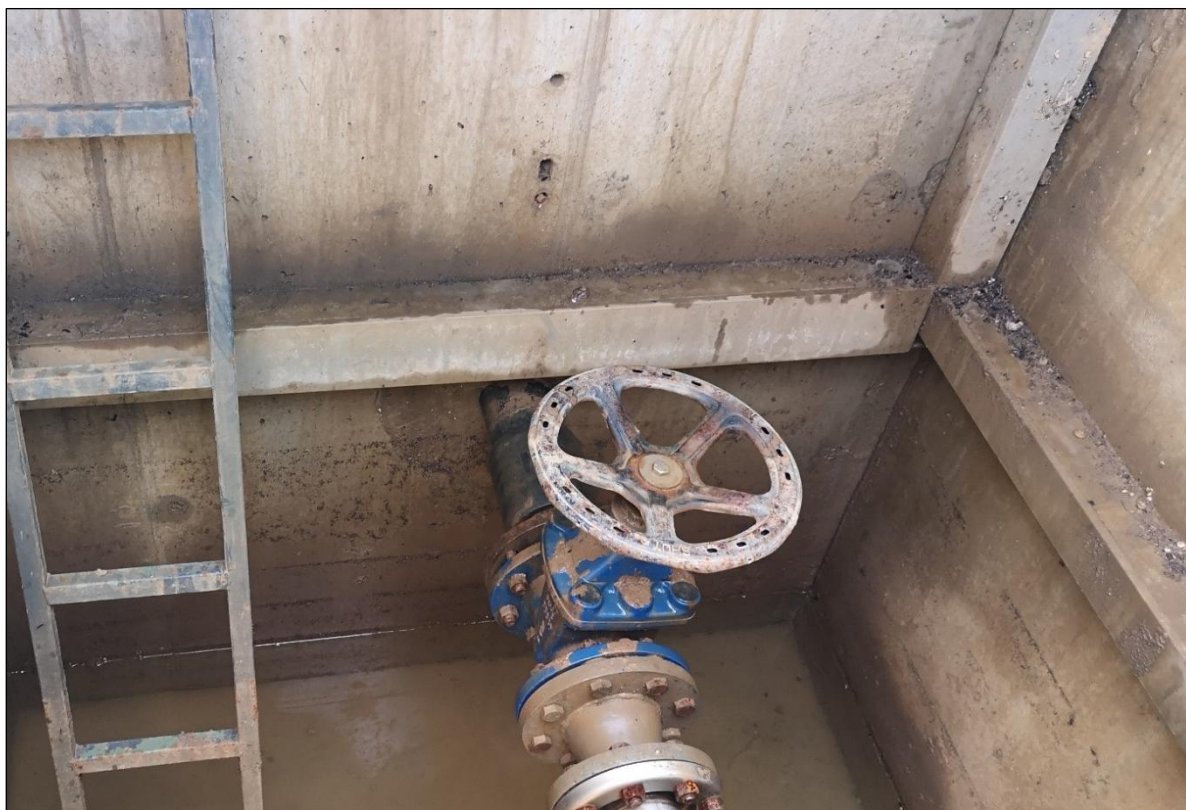
Foto - 6 – Canonades principal de connexió amb l'espessidor de fangs.
