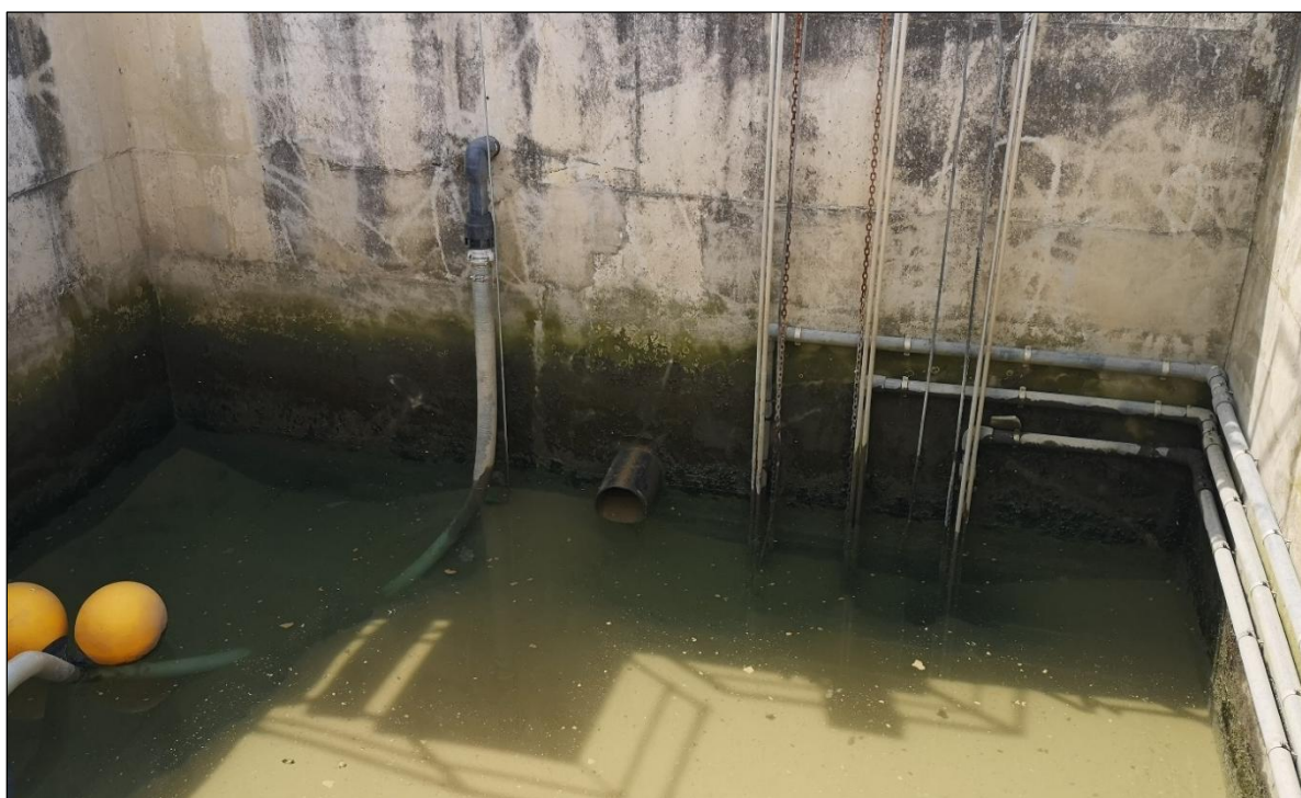
Foto - 3 – Bombes submergides existent i bomba flotant (a desplaçar).
