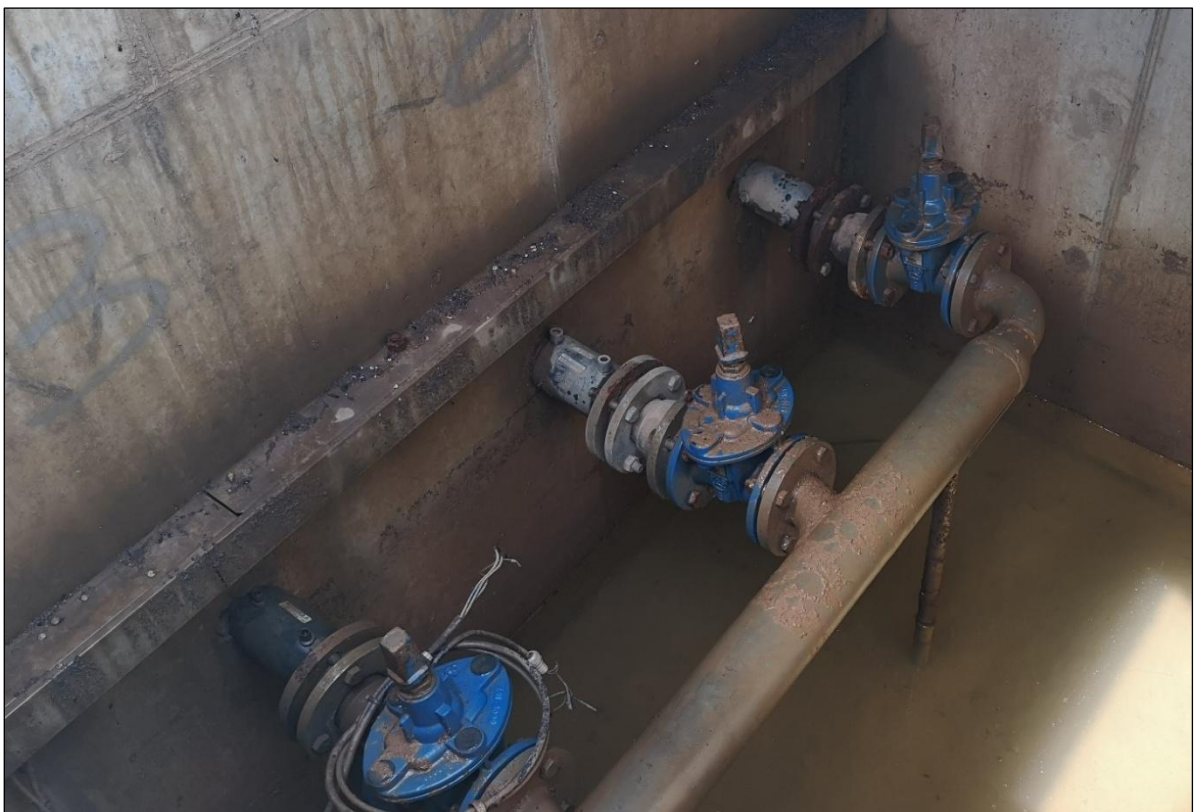
Foto - 5 – Canonades d'impulsió de les bombes submergides vistes des de l'arqueta.
