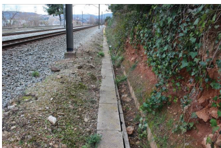
Foto n°1. Acumulació de material a la cuneta.
