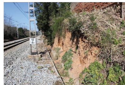
Foto nº1. Material erosionat acumulat a la cuneta.
