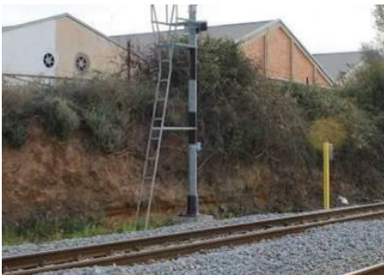
Foto n°1. Vista parcial del talús dreta on presenta una lleugera erosió diferencial a la base.
