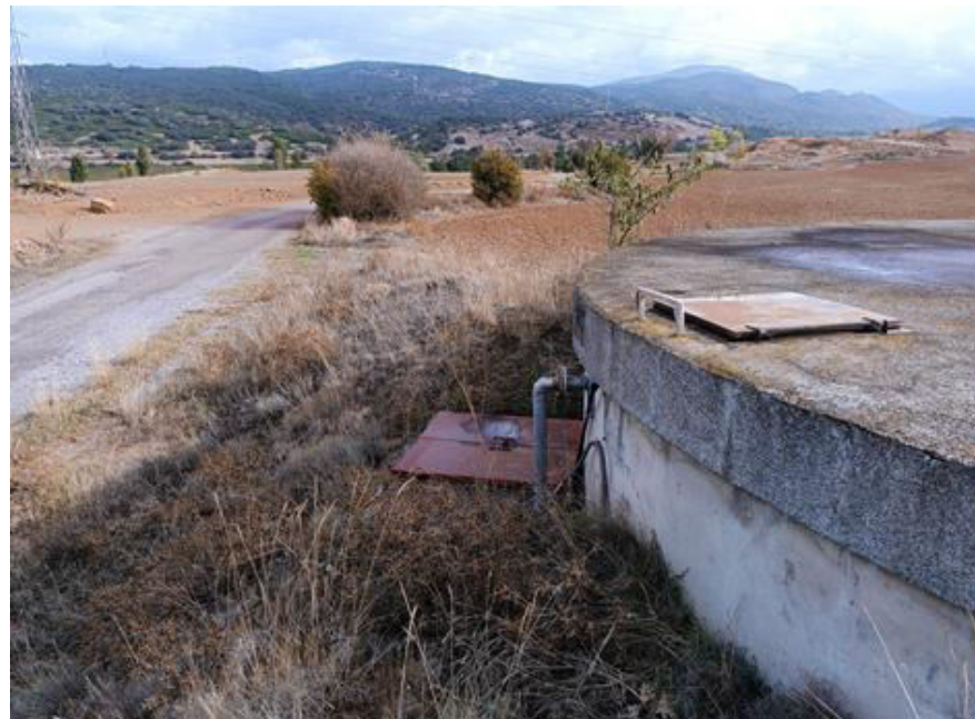
Figura 3. Instal·lacions del dipòsit Nou
