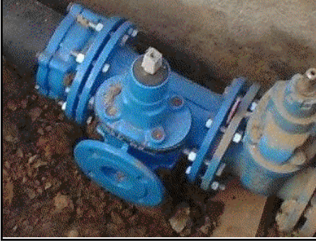
VÀLVULA DE DESCÀRREGA
