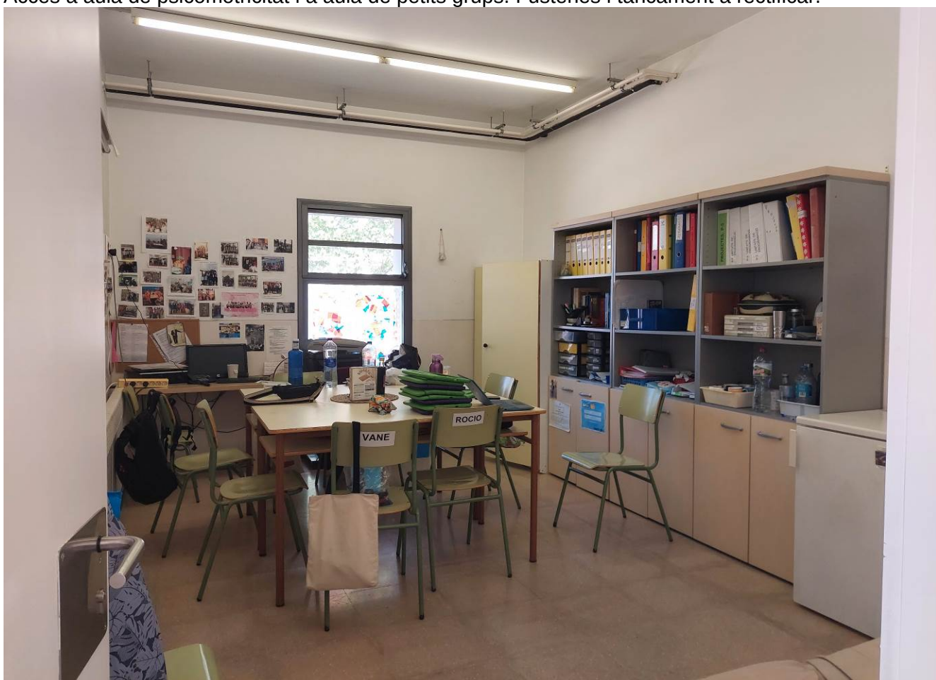
Aula de petits grups. Fusteria d'alumini a rectificar i generar nou accés des de l'exterior.
