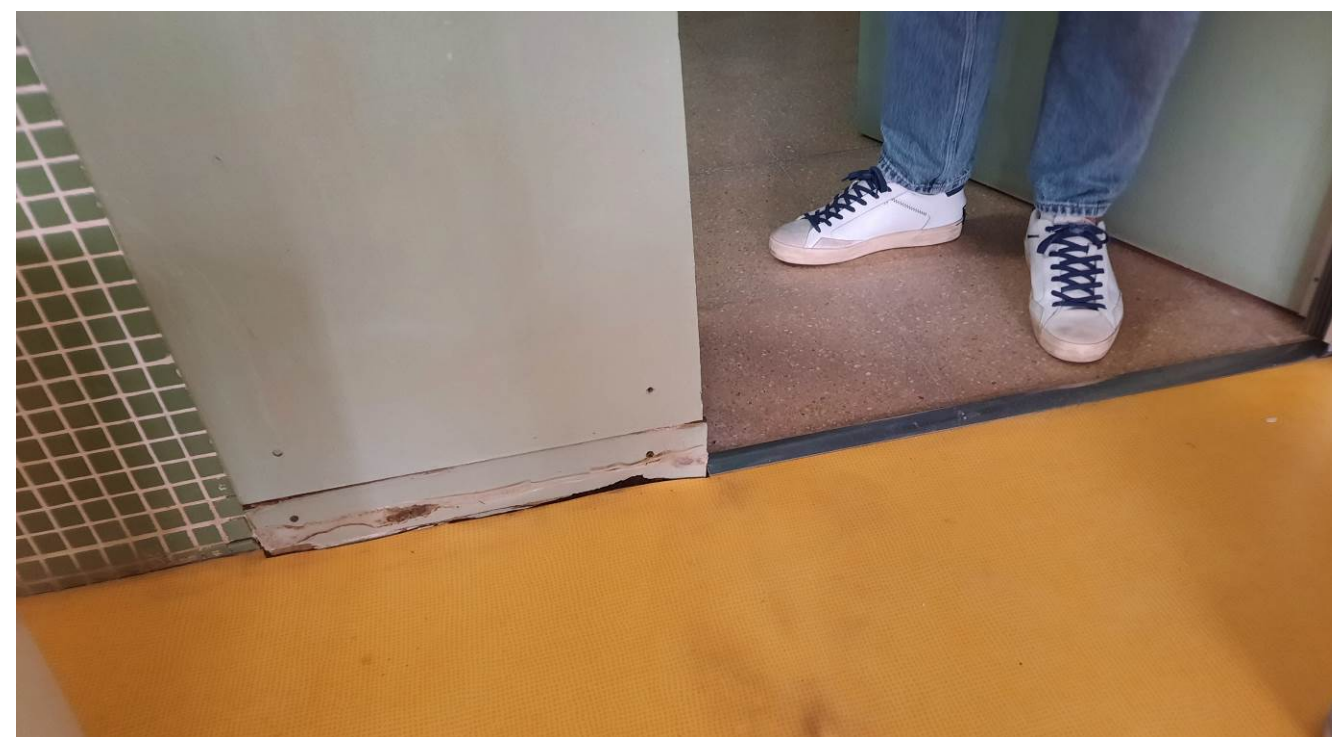
Desperfectes en fusterires i revestiments interiors de fusta
