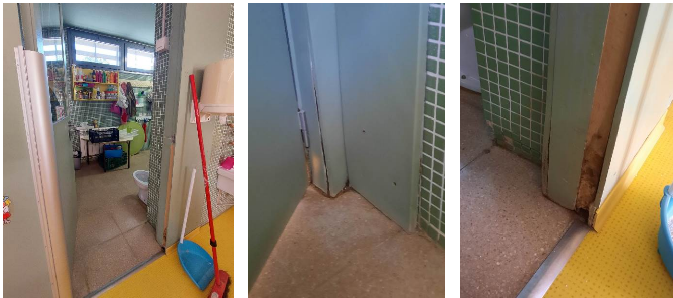
Desperfectes en fusterires i revestiments interiors de fusta
