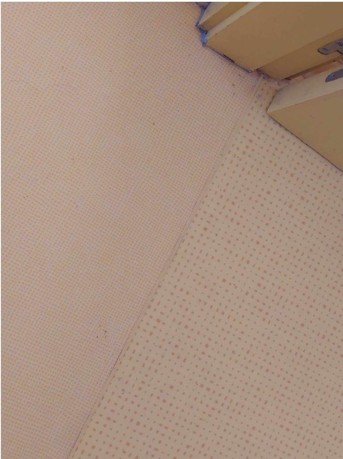
Canvi de paviment entre aules. Paviment original i paviment substituït recentment en una de les aules
