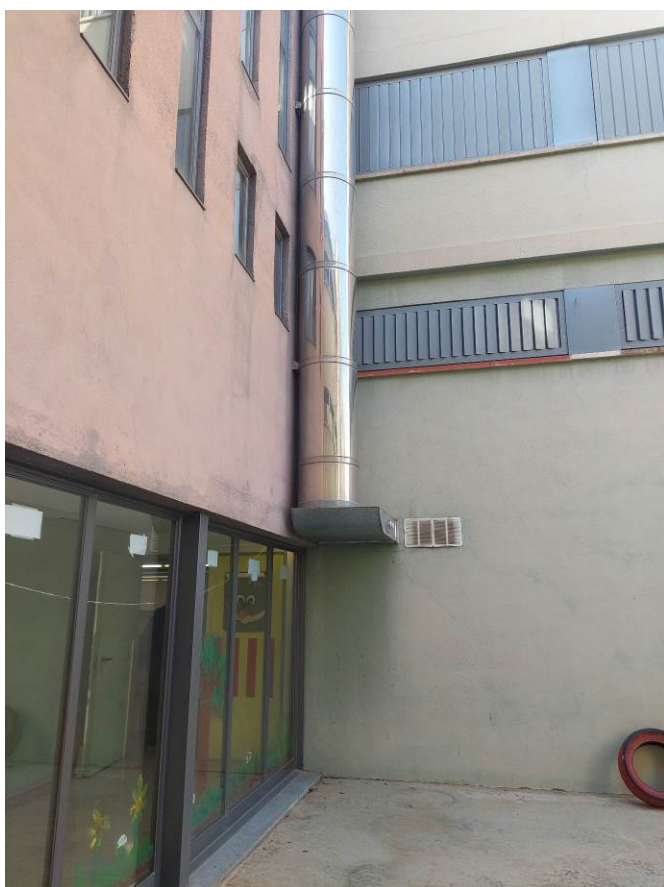
Xemeneia i reixa de ventilació de gas de la cuina
