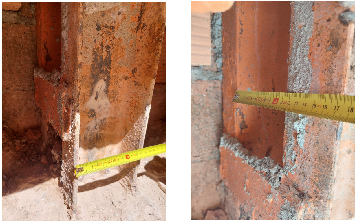
Fotografies cales façana zona xemeneia:
