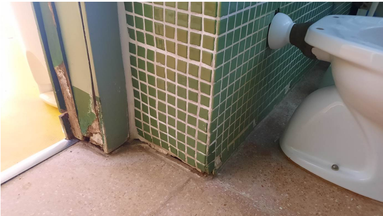
Desperfectes en fusterires i revestiments interiors de fusta
