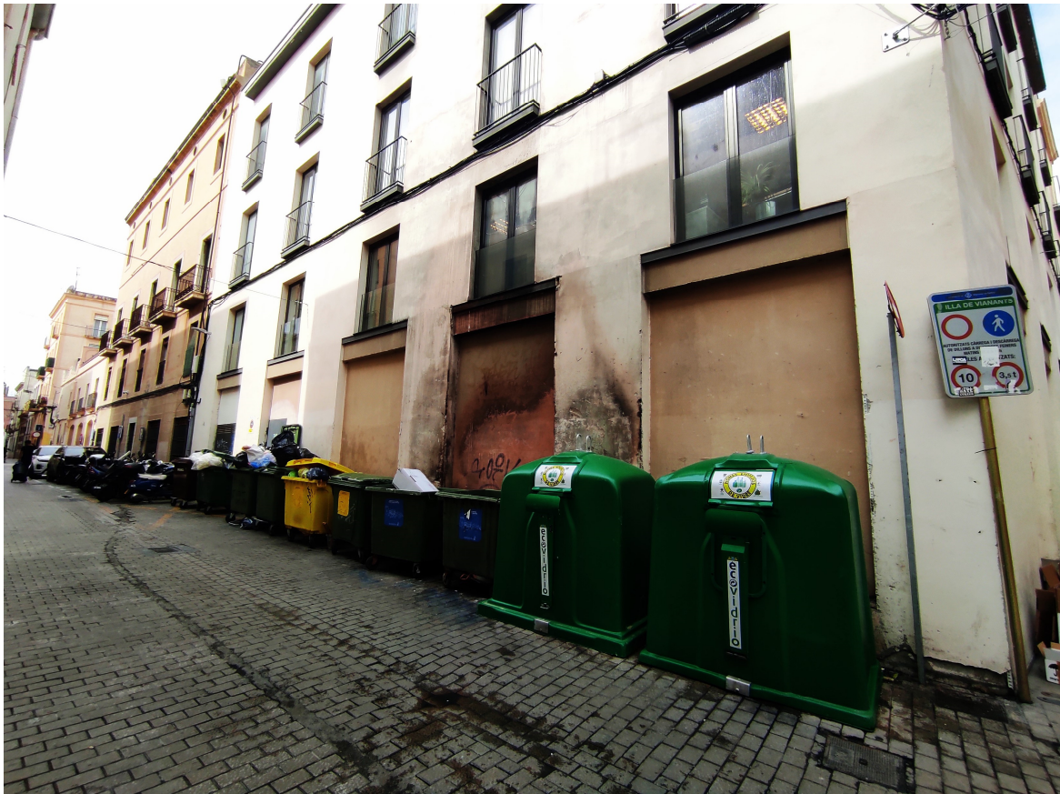
fig.02 Vista general façana afectada
