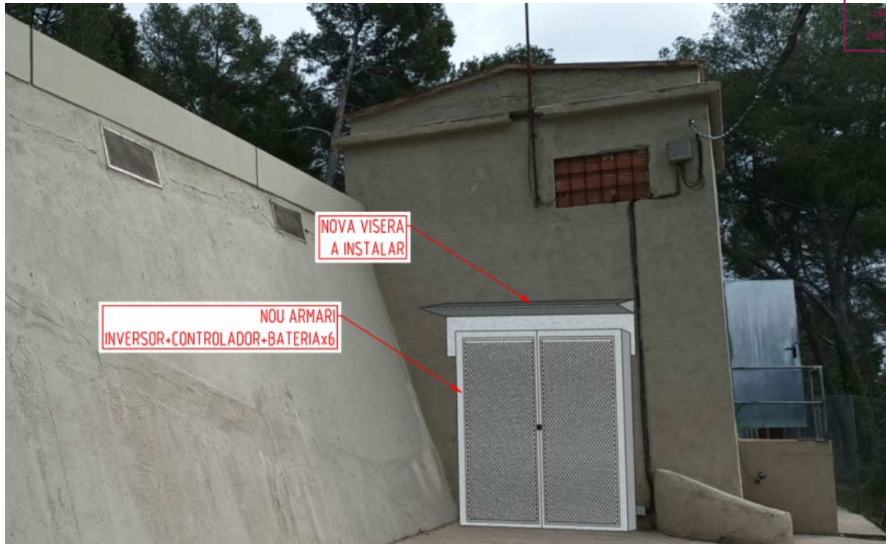
Ubicació del nou carregador/inversor de carrega
