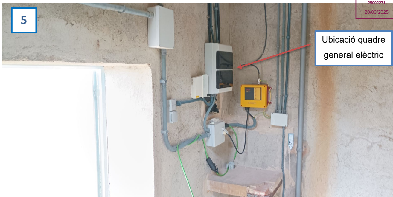
Imatge 5. Ubicació quadre general existent sala bombes/clor a on es connecta la instal·lació fotovoltaica
