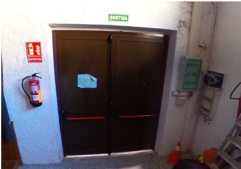
Foto quadre general de distribució
