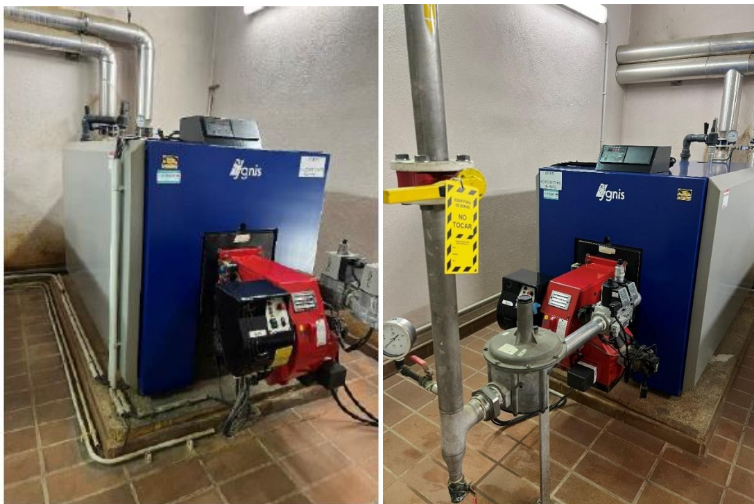
Figures 1 i 2. Detall de les calderes existents.
