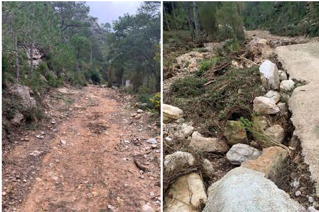
Imatge 7 i 8. Vista de l'estat de la pista .
