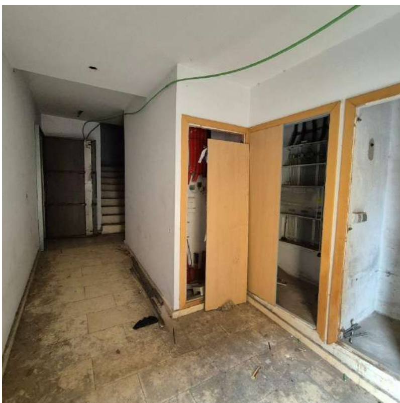
Interior edifici - Zones comuns - Entrada/Instal·lacions
