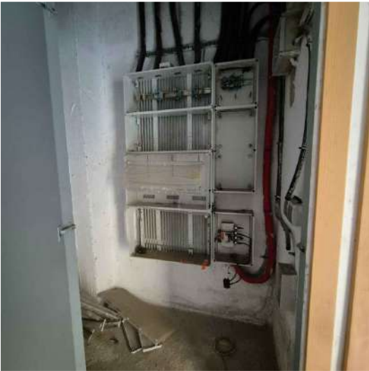
VESTÍBUL (ARMARI ELECTRICITAT)
