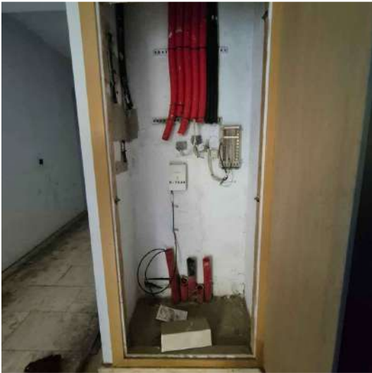
VESTÍBUL (ARMARI TELECOS)
