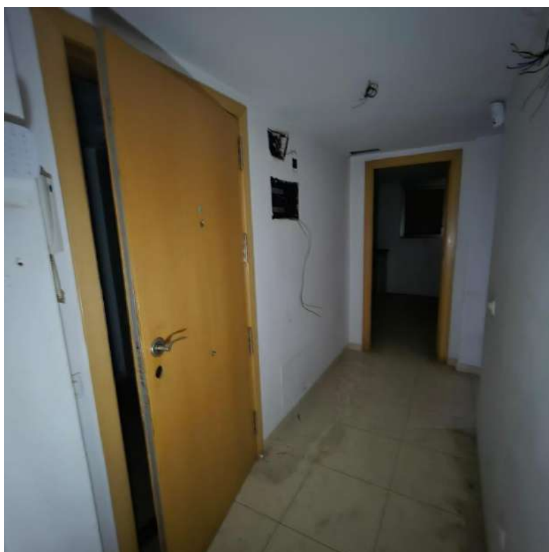
Interior edifici - Habitatge Planta baixa - Rebedor i quadres instal·lacions
