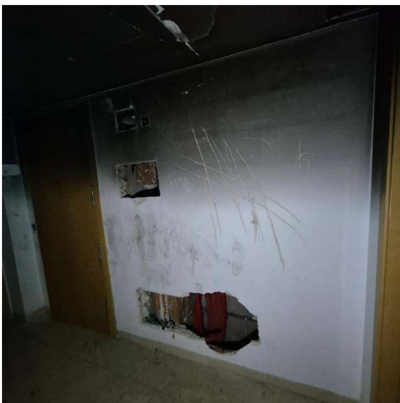
Interior edifici - Habitatge Planta segona - Rebedor i quadres instal·lacions
