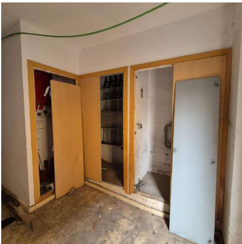
Interior edifici - Zones comuns - Entrada/Instal·lacions
