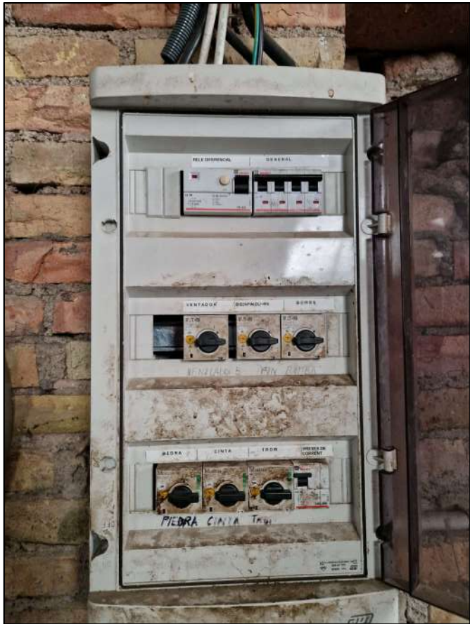
IMATGE 5. QUADRE GENERAL DE PROTECCIONS
