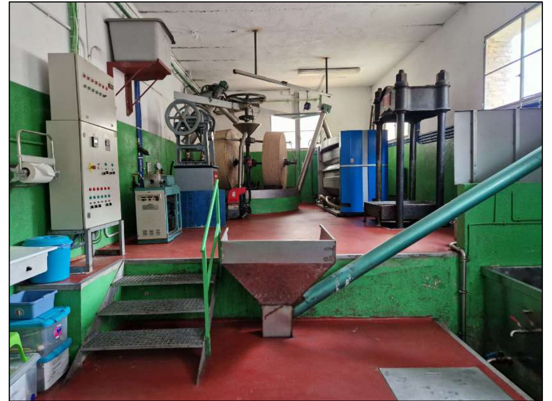
IMATGE 7. VISTA GENERAL. PREMSA, DECANTADORS, QUADRES DE COMANDAMENT
