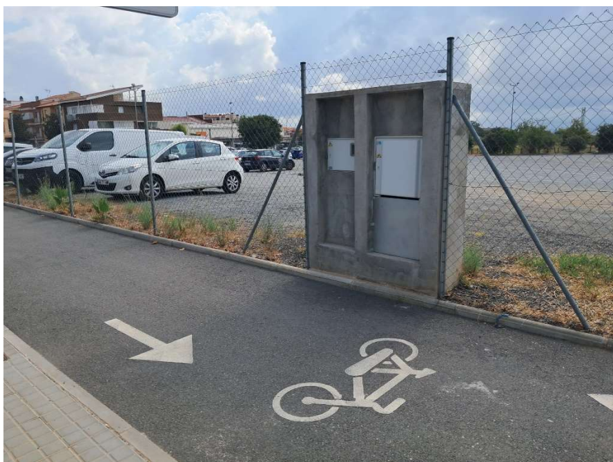
6.- Quadre elèctric existent a connectar regulació semafòrica
