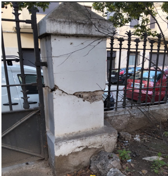
Imatge 36.- Detall afectació al pilar d' entrada. Font: Pròpia
