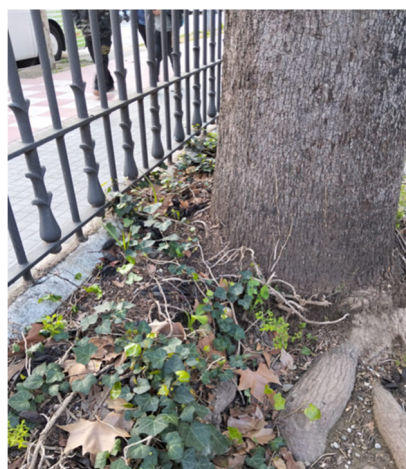
Imatge 28.- Exempler E20, afectació a la tanca de forja. Font: Pròpia
