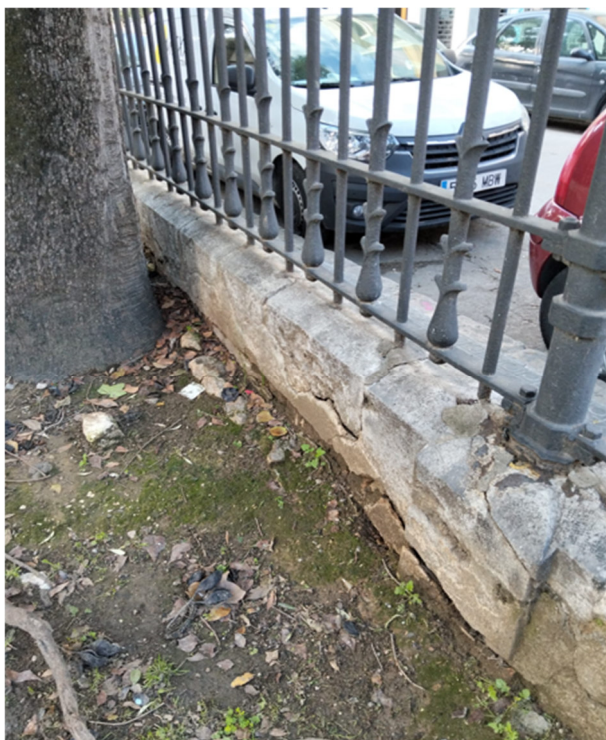
Imatge 34.- Detall afectació mur E35. Font: Pròpia
