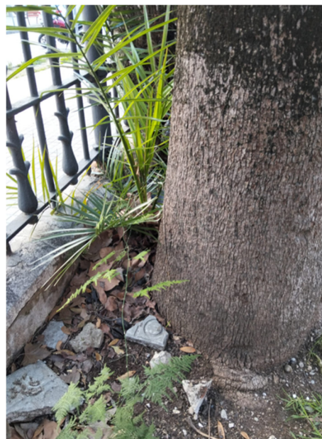
Imatge 33.- Exemplar E55, detall afectació mur i forja. Font: Pròpia
