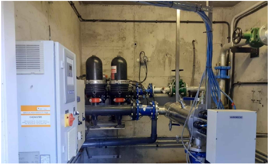
Sistema terciari de desinfecció actual i obsolet a adequar
