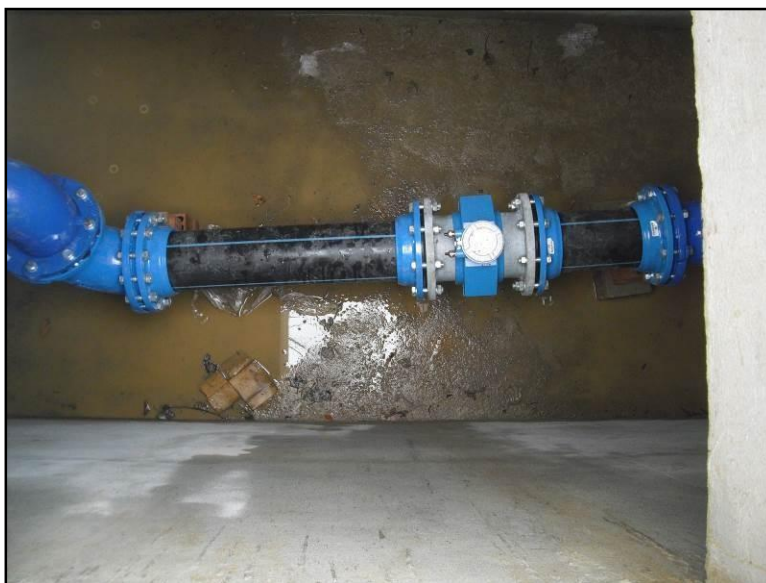
Imatge del cabalímetre de l'EB2, en el moment de la seva instal·lació l'any 2009
