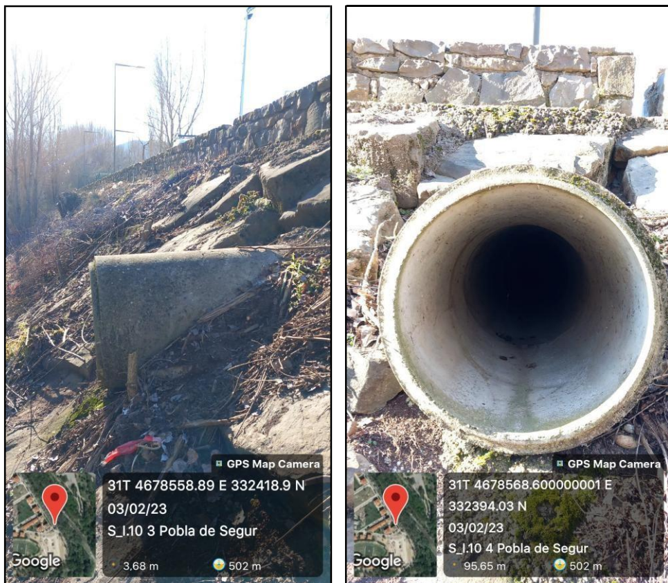
Punt d'abocament del sobreexidor del registre DPSE-PR-0110 al riu Flamisell
