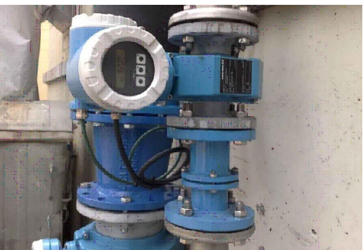
Cabalímetre EB 3 a substituir
