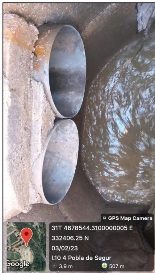
Imatge de l'interior del registre d'alta DPSE-PR-0110, amb els dos tubs de by-pass situats a la mateixa cota
