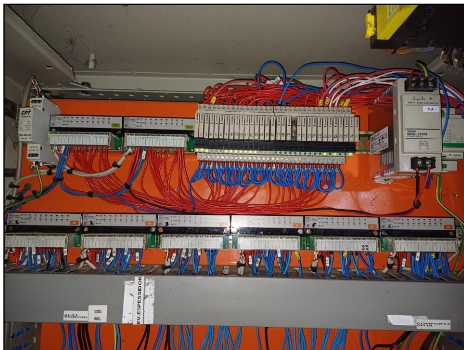
Imatge de l'actual PLC obsolet, de la marca Omron
