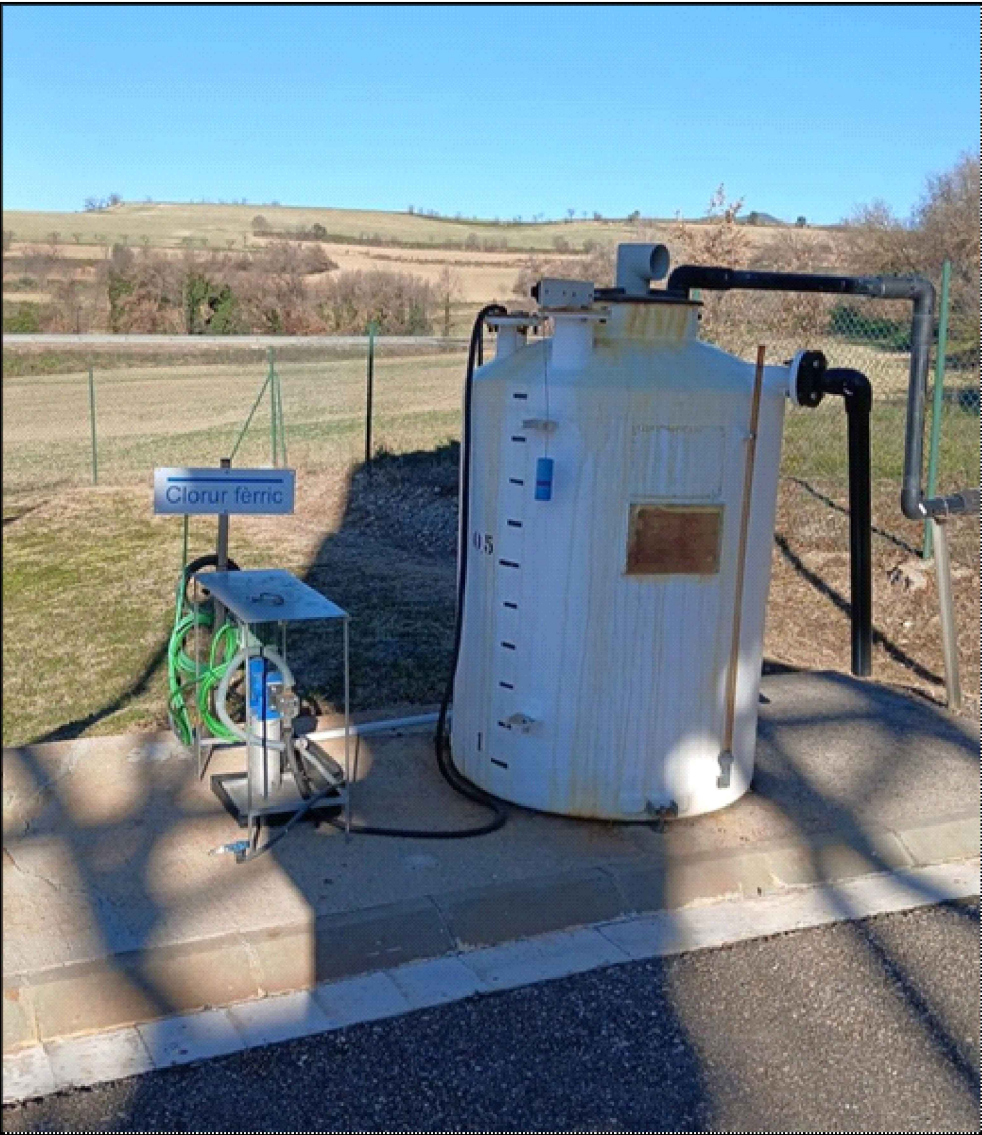
Instal.lació actual de dosificació de clorur fèrric
