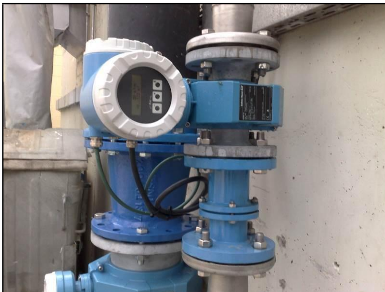
Imatge del cabalímetre de l'EB3, en el moment de la seva instal·lació l'any 2009
