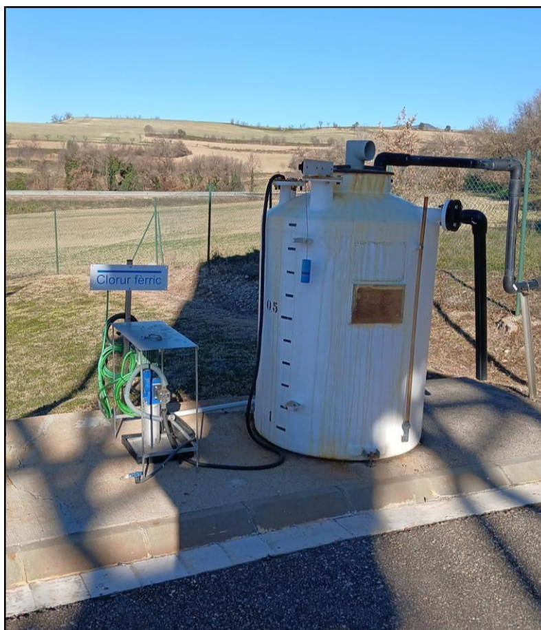
Imatge de l'actual instal·lació de dosificació de clorur fèrric
