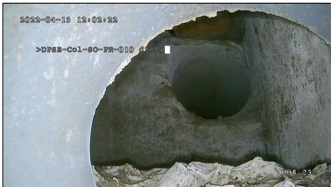
Vista del tub de by-pass que aboca al riu Flamisell, des d'una de les canonades de by-pass procedent del registre DPSE-PR-0110
