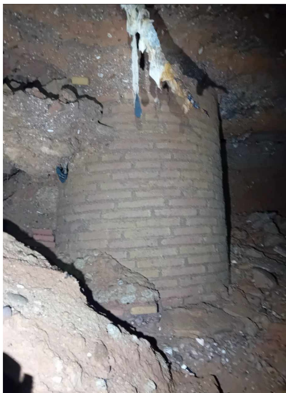
Detall del pou just sota l'aparcament, on la terra del volant ha desaparegut totalment
