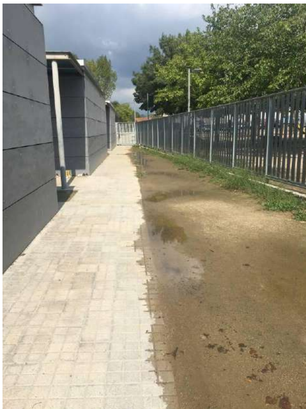
ESTAT ACTUAL DEL PATI. EFECTES DE LA PLUJA.
