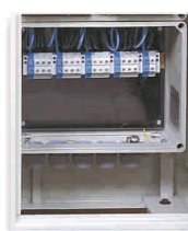
Espacio para conexiones
