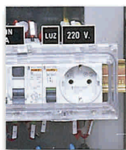
Toma de corriente
