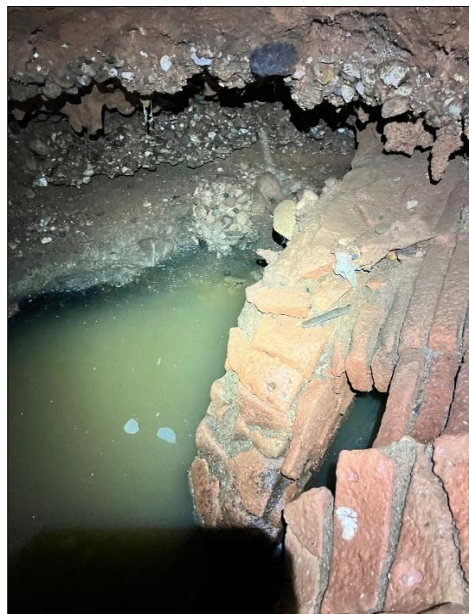
Vista de la zona trencament pou de salt
